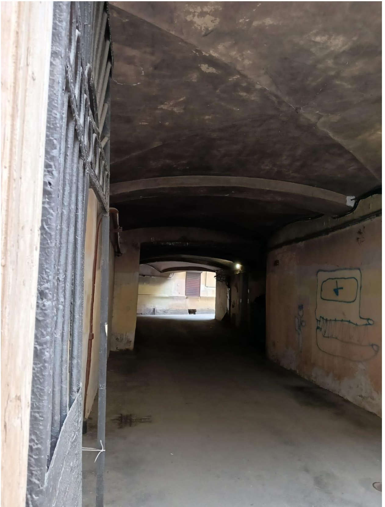
Фото 4. Объект культурного наследия «Особняк А.Р. Ламздорф», расположенный по адресу: Санкт-Петербург, улица Моховая, дом 20, литера А. Воротный проезд лицевого корпуса, своды.
