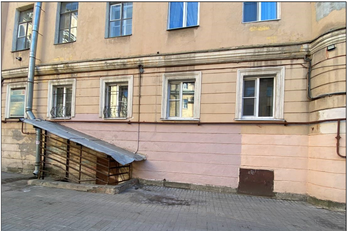
8. Выявленный объект культурного наследия «Жилой дом при заводе Ф.К. Сан-Галли». Фрагмент дворового юго-западного фасада. Оконные проемы квартиры № 1. 10.03.2023 г.
