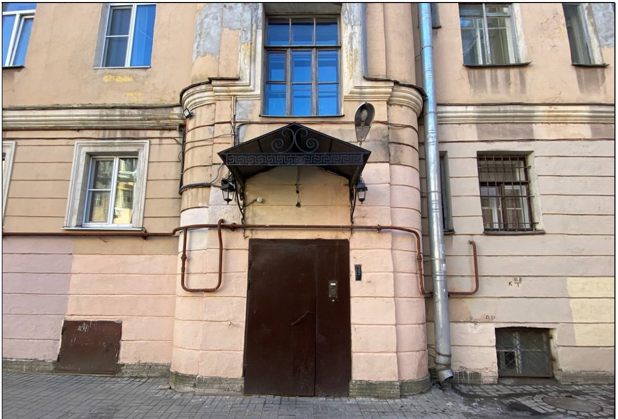
9. Выявленный объект культурного наследия «Жилой дом при заводе Ф.К. Сан-Галли». Фрагмент дворового юго-западного фасада. Вход на лестницу Л-4. 10.03.2023 г.
