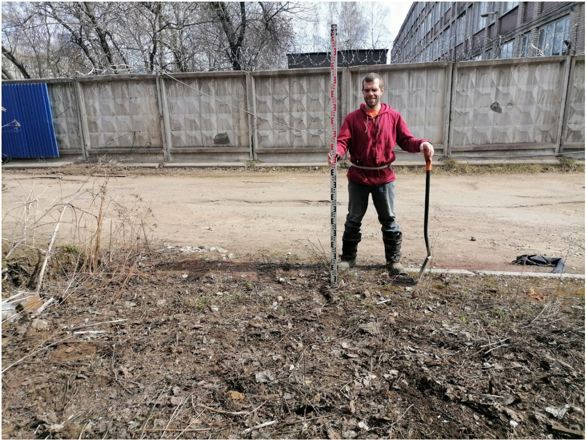
Рис. 19. Санкт-Петербург, внутригородское муниципальное образование Санкт-Петербурга муниципального округа Финляндский округ, Литовская улица, земельный участок 1, кадастровый номер 78:10:0005114:1801. Шурф 1. Вид шурфа 1 до начала работ, вид на восток.
