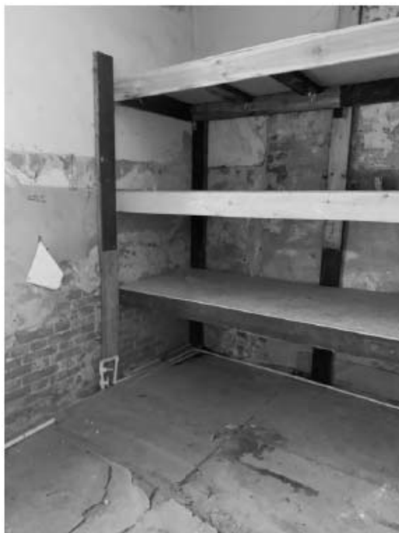
11. ОКН федерального значения «Корпус служебный казарм Первого учебного морского экипажа» (г. Кронштадт, Коммунистическая ул., д. 3 лит. А). Помещение 4-Н.
