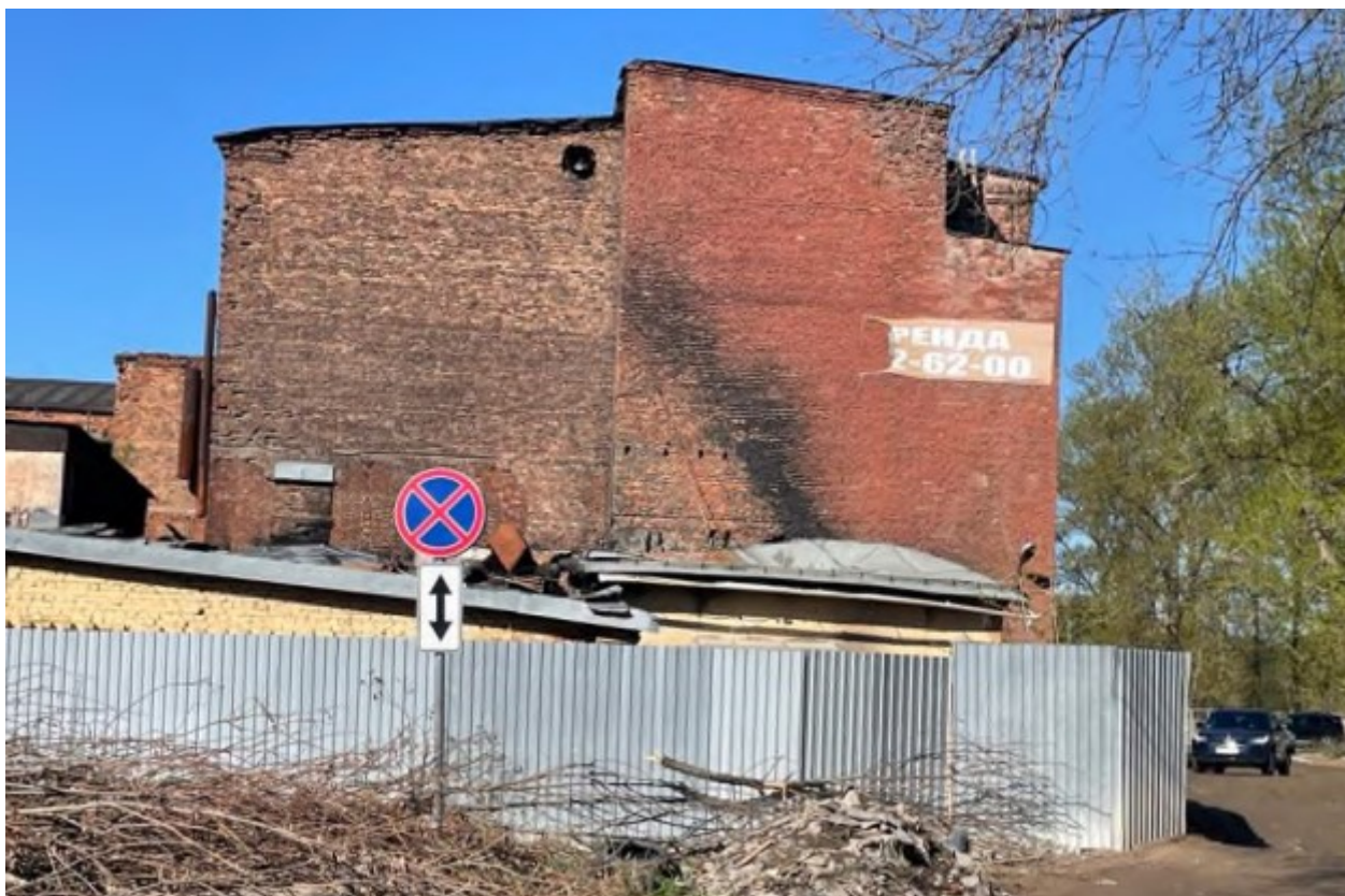
5. 1-этажная часть демонируемого здания по адресу: г. Санкт-Петербург, Октябрьская наб., д. 50, лит. А13 (1-ЗКН)
