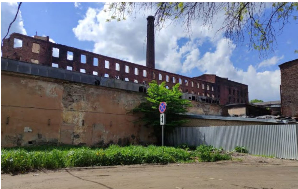
4. Демонтируемое здание по адресу: г. Санкт-Петербург, Октябрьская наб., д. 50, лит. А13 (1-3КН)
