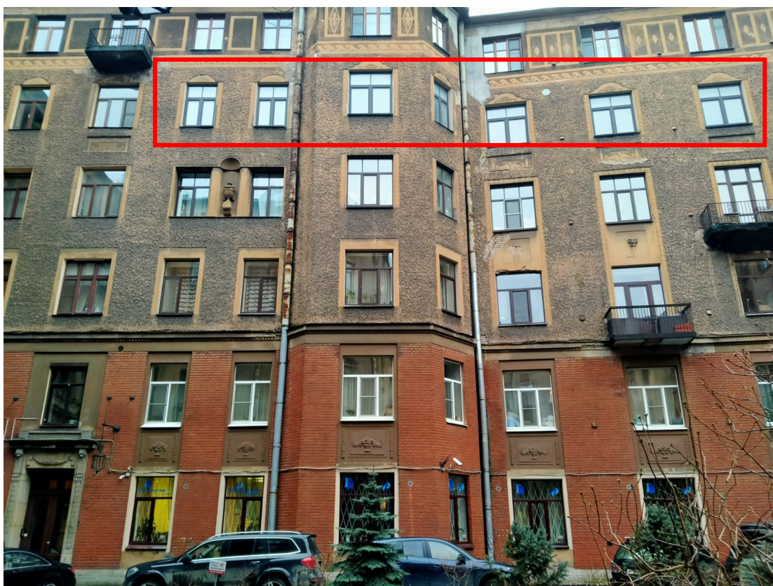
5. Здание по адресу: Санкт-Петербург, ул. Рубинштейна, д. 15-17, Лит. А. Фрагмент дворового фасада и входа в парадную, где находится квартира №558.
