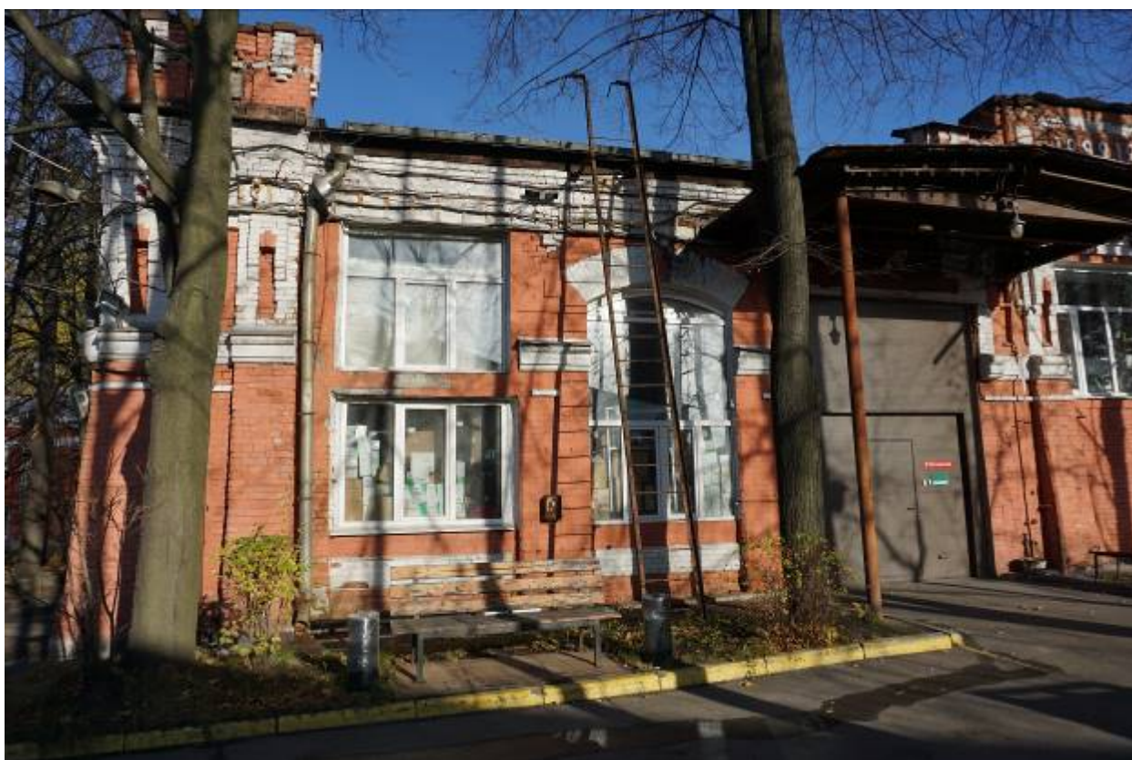
Фото 10. Фрагмент южного фасада здания. Вид на оконные проемы и дверной проем с козырьком.
