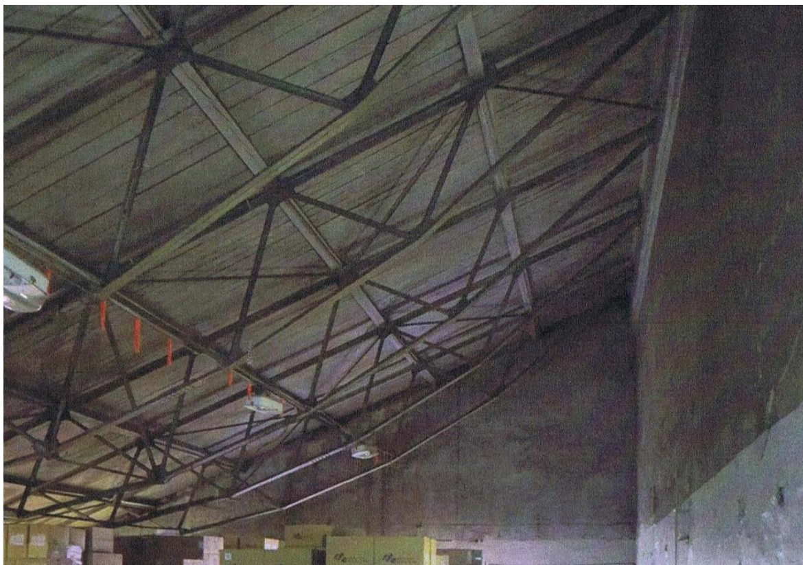
36. Металлические серповидные фермы (южная часть). — Архив КГИОП.
