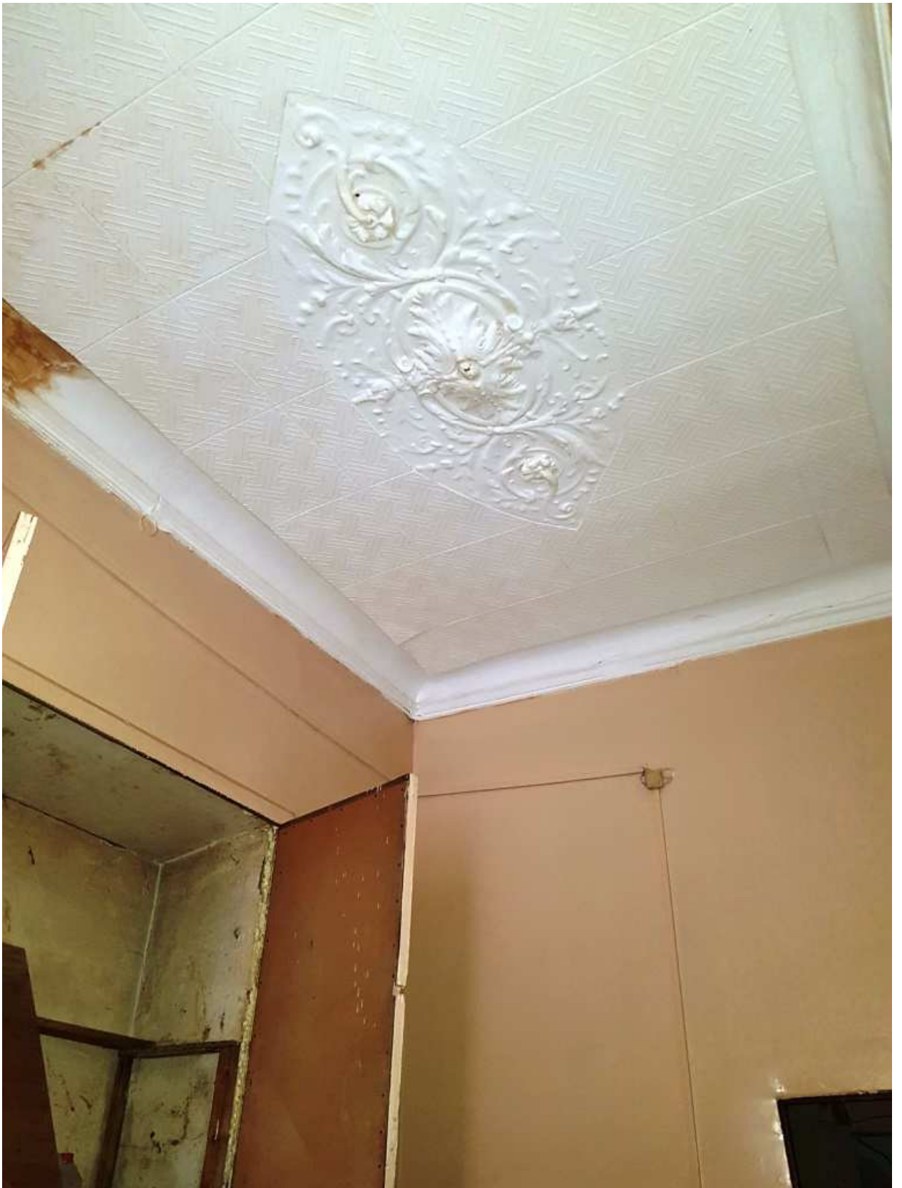
10. Пом.5. Потолочная розетка.
