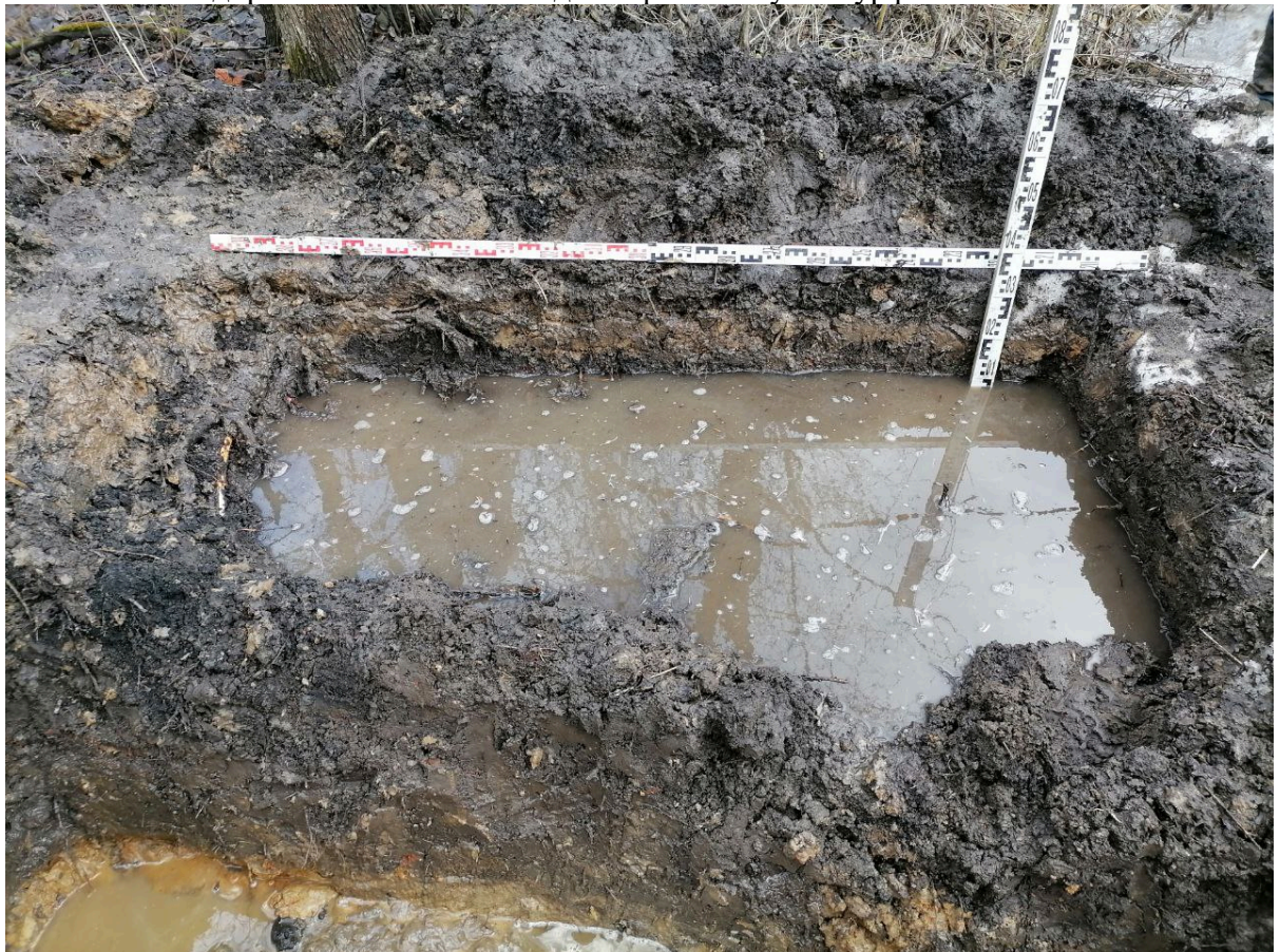
Рис. 27. Санкт-Петербург, Колпинское шоссе, Реконструкция Колпинского шоссе на участке от автодороги М- 10 «Россия» до Софийской ул. Шурф 1. Фиксация по матерiku, вид на восток.
