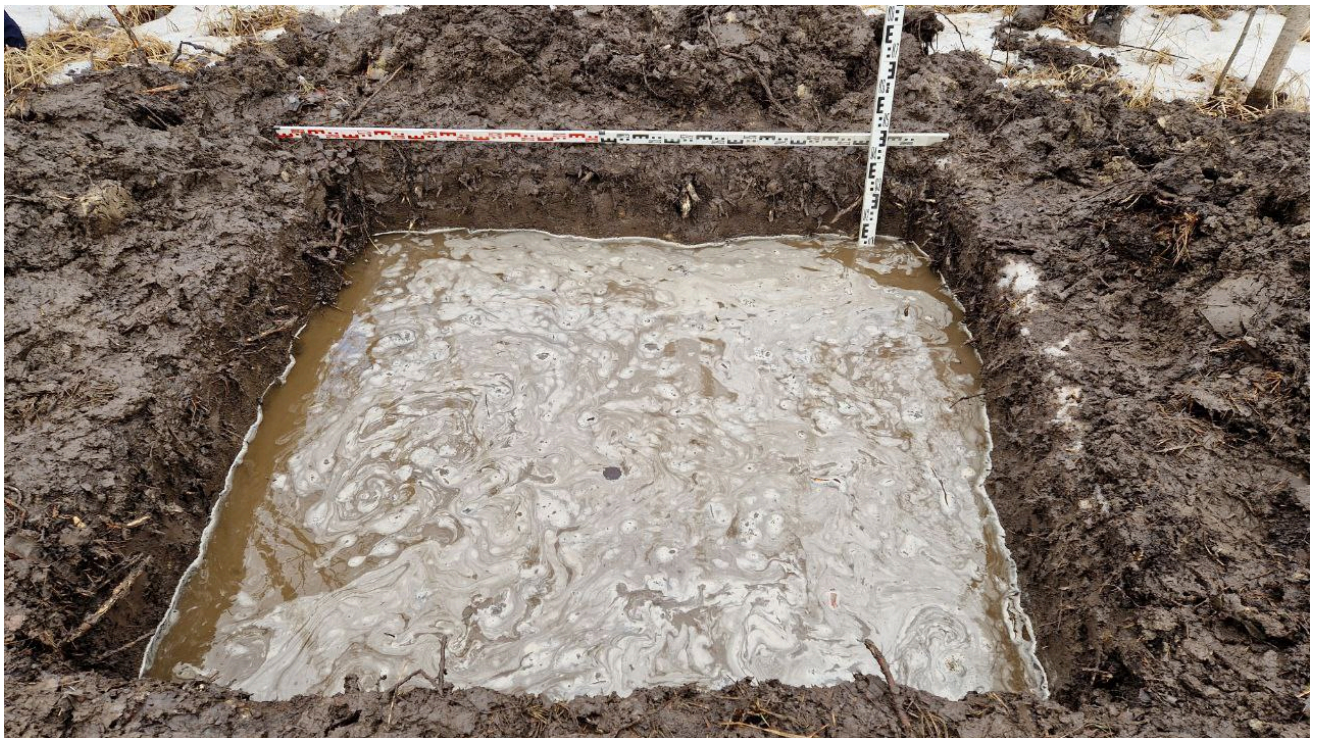
Рис. 37. Санкт-Петербург, Колпинское шоссе, Реконструкция Колпинского шоссе на участке от автодороги М- 10 «Россия» до Софийской ул. Шурф 2. Фиксация по уровню грунтовых вод. Вид на юг.
