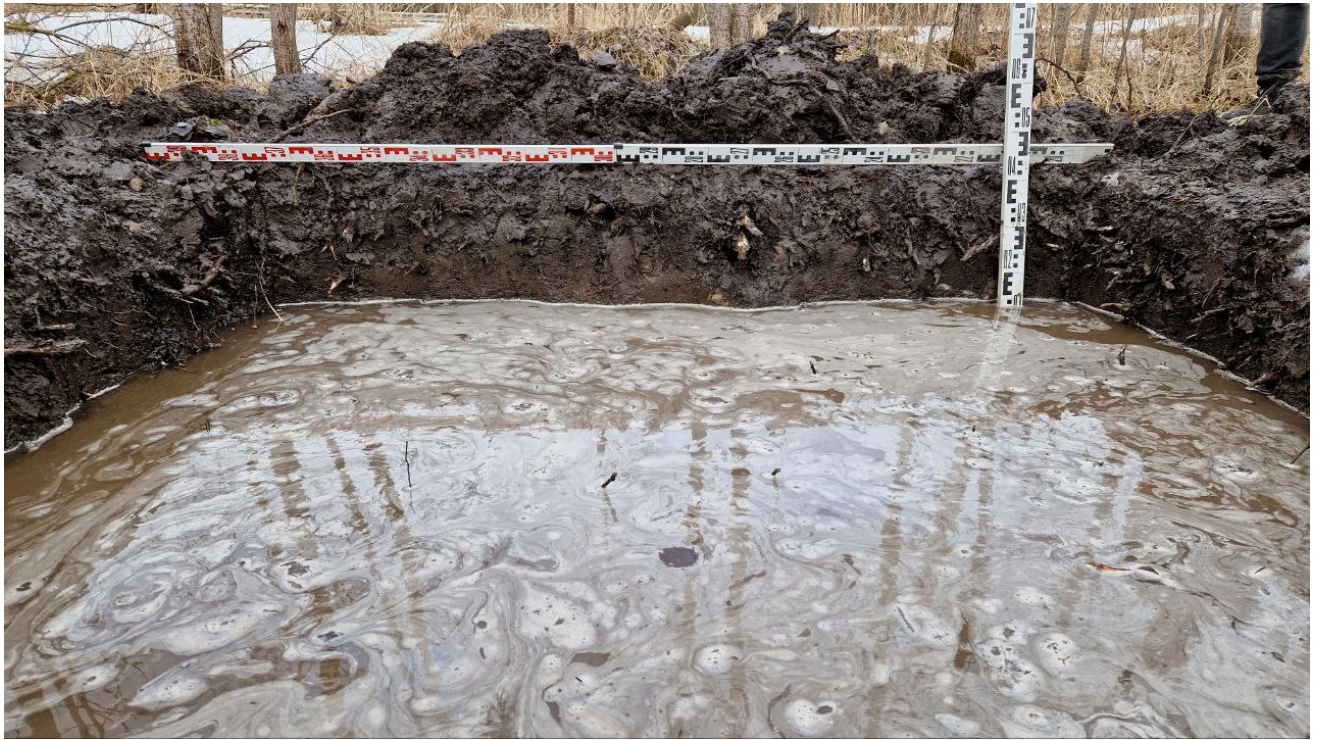
Рис. 38. Санкт-Петербург, Колпинское шоссе, Реконструкция Колпинского шоссе на участке от автодороги М- 10 «Россия» до Софийской ул. Шурф 2. Фиксация по уровню грунтовых вод. Южная стенка.
