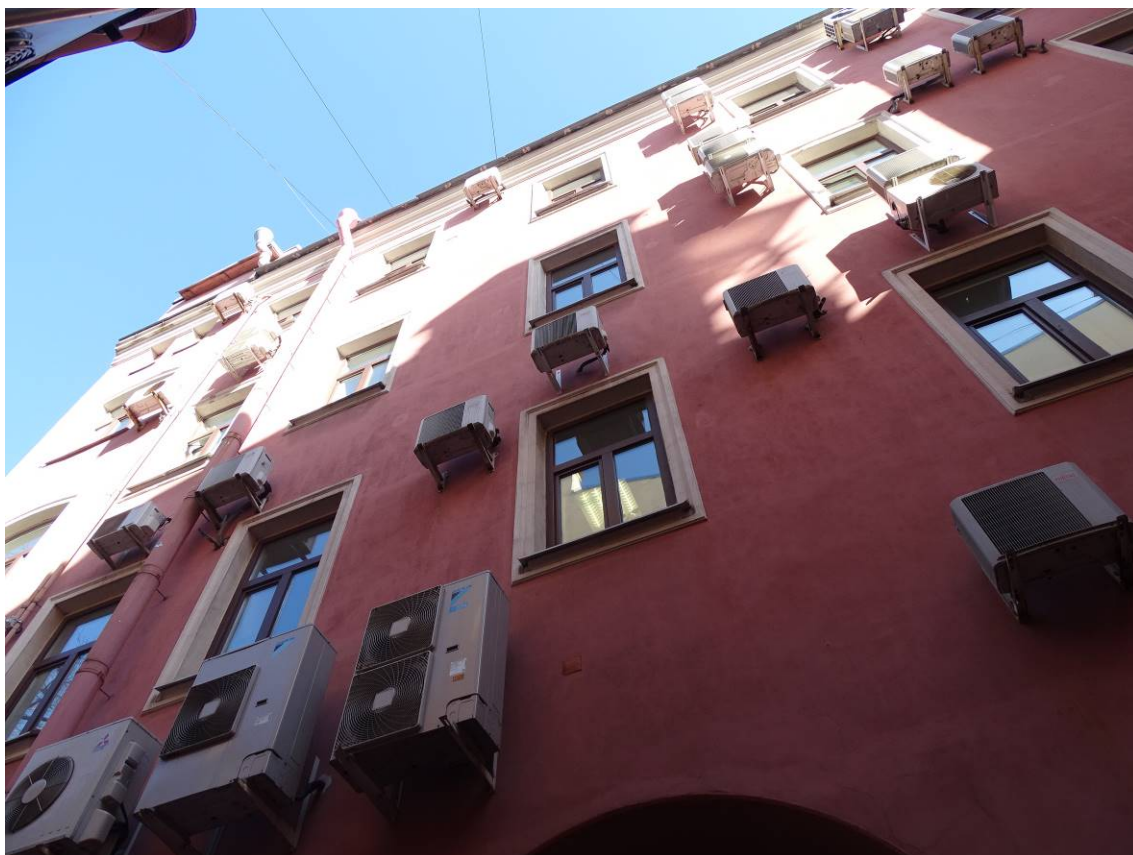
Фото 13. Объект культурного наследия регионального значения «Дом Тузова И.Л.». Восточный фасад дворового корпуса. Фрагмент. Съемка 03.04.2023 г. Трушковский В.Э
