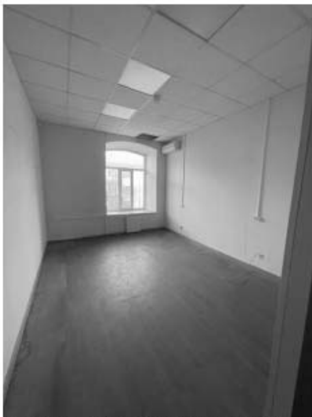
Фото 16 Интерьер части пом. 1-Н выявленного объекта культурного наследия «Дом Б.Е. Фурмана», по адресу: Санкт-Петербург, ул. Смольчкова, д. 15-17, лит. А (от 07.12.2022)
