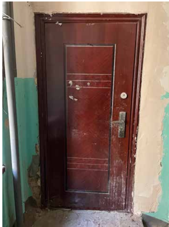
9. Дверь в квартиру с черной лестницы
