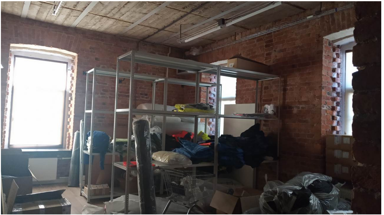
Фото 12. Оконные проемы комнат 23 и 28 в помещении 2-Н. Фото от 02.06.2022 г.
