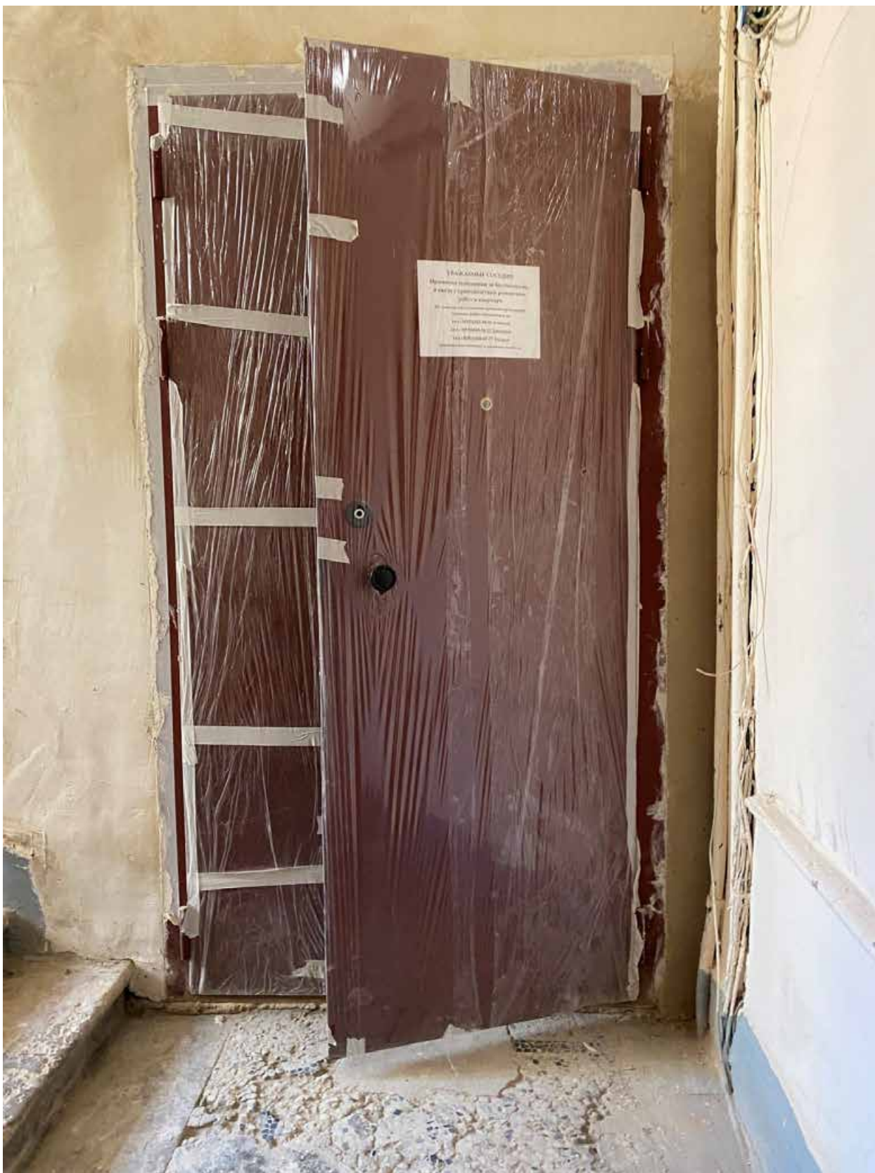
Фото 16. Вид на входную дверь в квартиру № 5 (с парадной лестницы) объекта культурного наследия.
