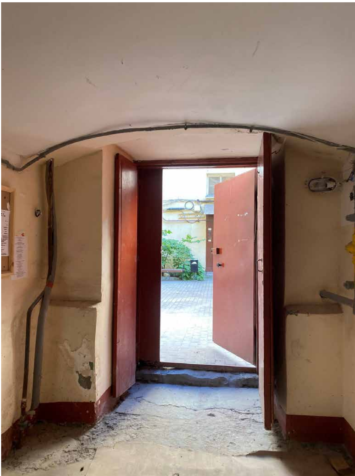
Фото 11. Вид на выход из парадной, ведущей из квартиры № 5 (черная лестница), объекта культурного наследия.
