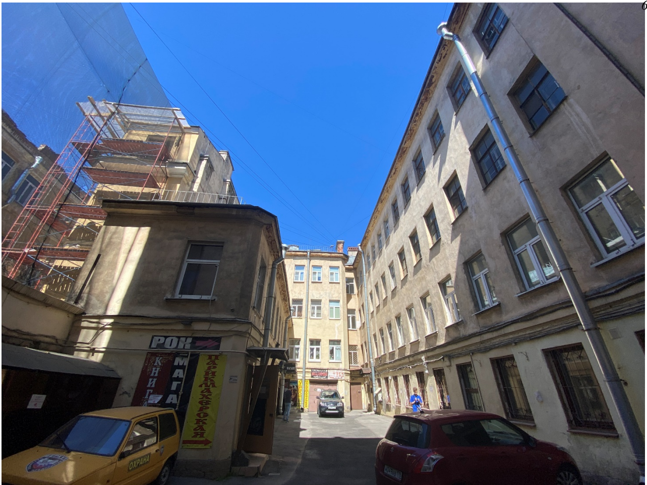
Фото 5. Юго-восточный и северо-восточный фасады дворового флигеля под лит. А 3 . Вид с юго-востока.
