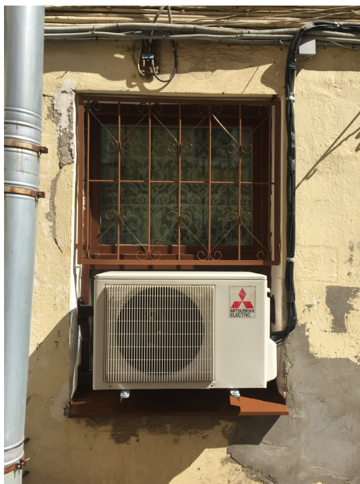
Фото 8. Внешний блок системы кондиционирования, устроенный в оконном заполнении со стороны юго-западного дворового фасада. Вид с юго-запада.
