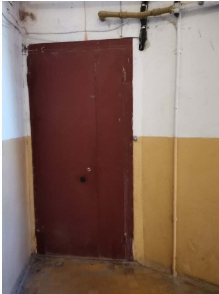
20. ОКН федерального значения «Дом Антонова («Дом Адамини»)». Дверь в Помещение 46-Н с лестничной клетки.
