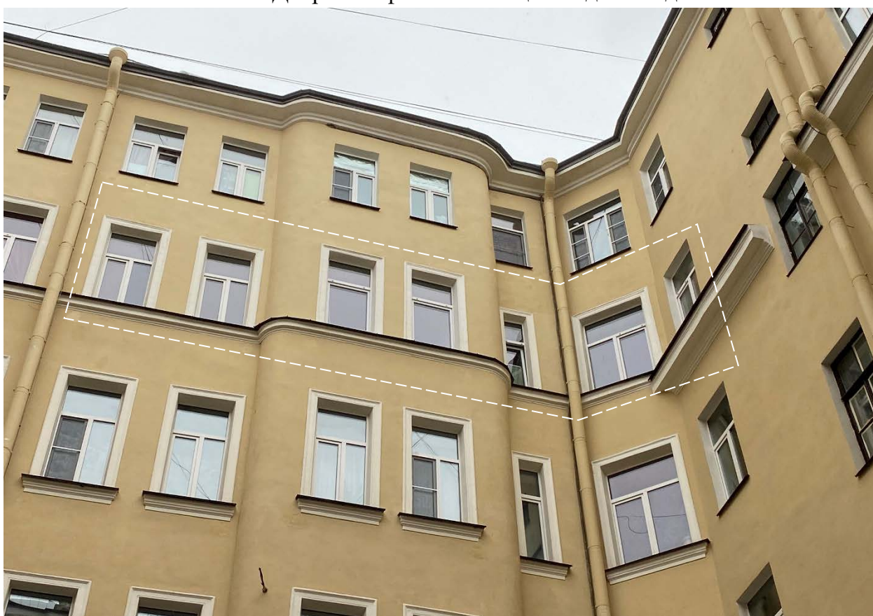
Фото 4. Фрагмент западного (слева) и северного (справа) фасадов выявленного объекта культурного наследия «Дом Л.Л., С.Л., и Д.Л. Фуфаевских» с оконными проемами в уровне 5-го этажа в границах квартиры № 20.
