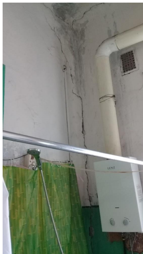
Фото 20. Трещины отделки в помещении ванной № 6.
