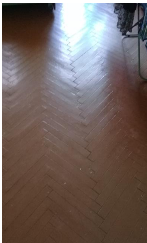
Фото 14. Окрашенный паркет в помещении комнаты № 2 (по техпаспорту).
