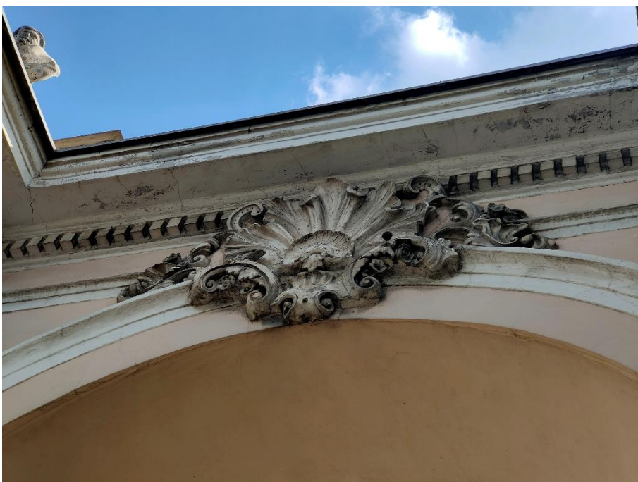
29. «Ограда с воротами», входящие в состав объекта культурного наследия федерального значения «Дом Дубяньских (Зиновьева Н.В., Карловой Н.Ф.), наб. р. Фонтанки, д.46. Западная часть ограды. Фрагмент. Фото 15.05.2023г.
