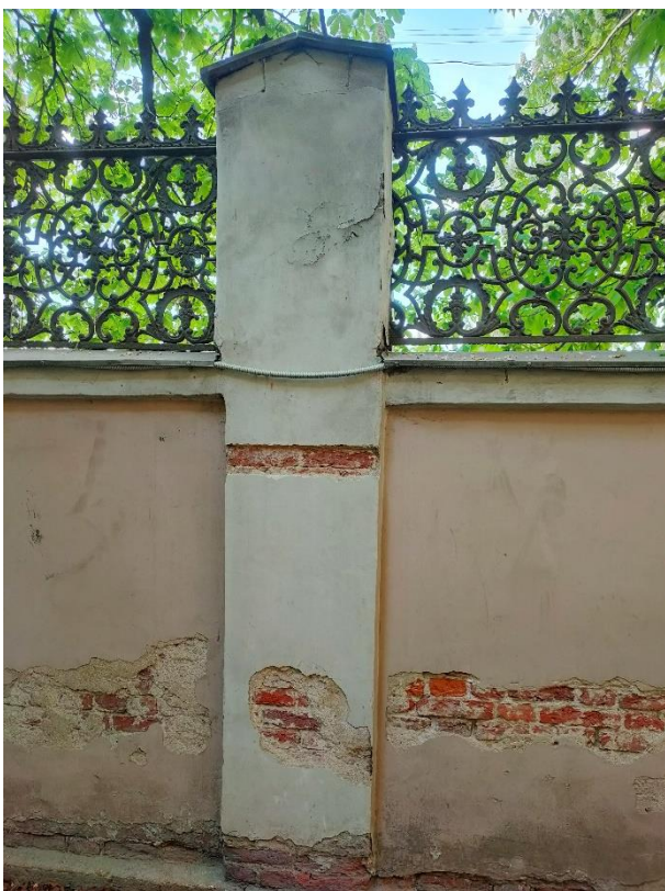
19. «Ограда с воротами», входящие в состав объекта культурного наследия федерального значения «Дом Дубяньских (Зиновьева Н.В., Карловой Н.Ф.), наб. р. Фонтанки, д.46. Восточная часть ограды. Фрагмент. Фото 15.05.2023г.
