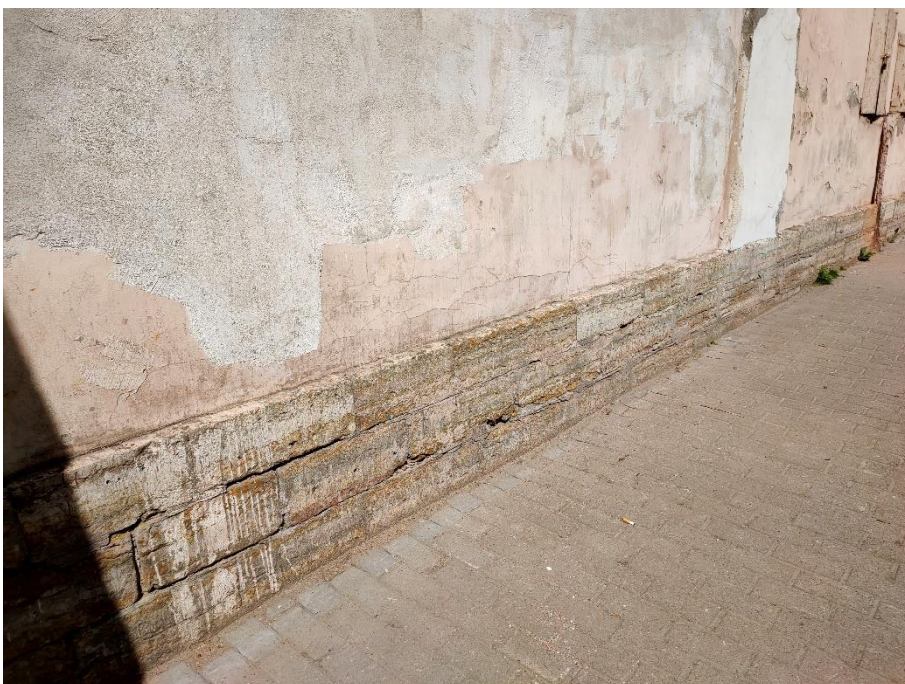
14. «Ограда с воротами», входящие в состав объекта культурного наследия федерального значения «Дом Дубянских (Зиновьева Н.В., Карловой Н.Ф.)», наб. р. Фонтанки, д.46. Восточная часть ограды. Фрагмент. Фото 15.05.2023г.
