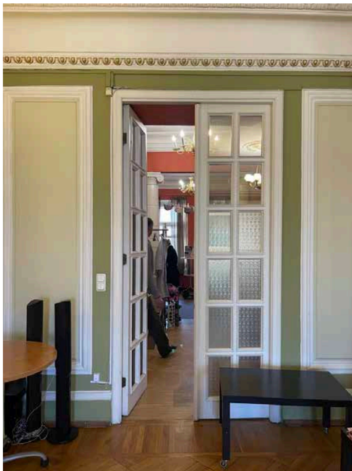
143. Дверной проем из помещения 26(Н)-2.
