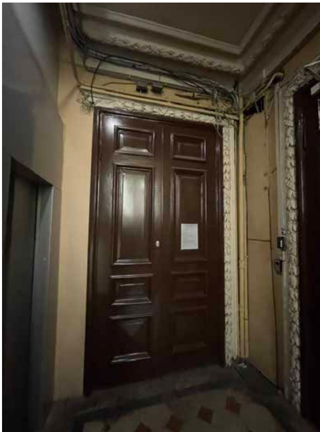
65. Дверной проем в помещение 22-Н(2). Имеются утраты наличника с растительными элементами в профилированной раме. Лепной декоративный элемент с картушем над дверным проемом отсутствует.
