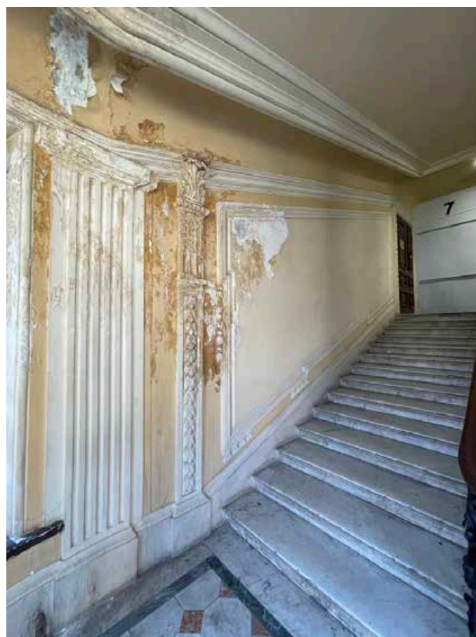
170. Общий вид лестничного марша с шестого этажа на мансардный этаж. Сильные дефекты декоративной отделки стен в результате протечек крыши.
