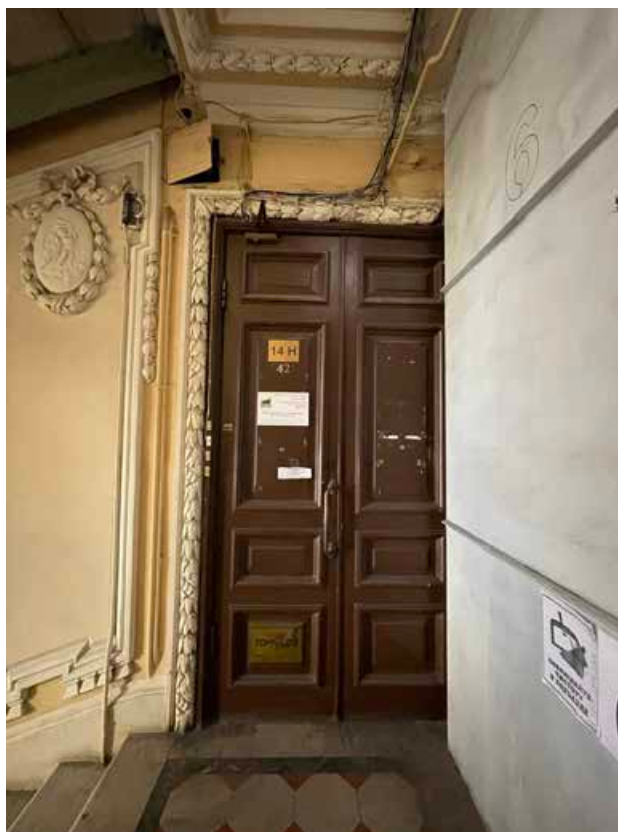
132. Дверной проем в помещение 14-Н(1). Частичная утрата наличника дверного проема в виде цветочной гирлянды в связи с устройством лифтовой шахты на всю высоту лестничной клетки. Заполнение двустворчатое деревянное, каждая створка поделена на 4 филенки.
