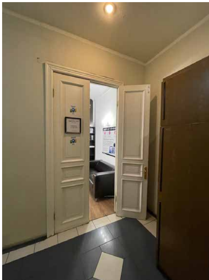
123. Дверной проем помещения 25(Н)-4. Проем оформлен профилированным наличником. Заполнение деревянное двустворчатое, каждая створка поделена на 3 филенки.
