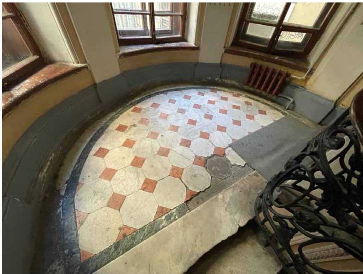
41. Покрытие лестничной площадки между вторым и третьим этажами – метлахская плитка красного и белого цвета, простой бордюр зеленого мрамора. Имеются утраты.
