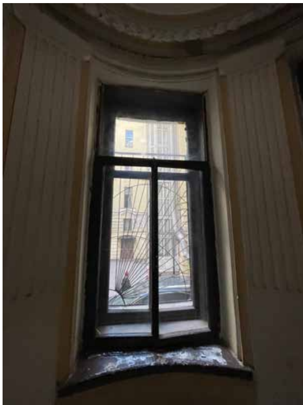
20. Оконный проем круглого ризалита лестничной клетки между первым и вторым этажами в южную сторону.
