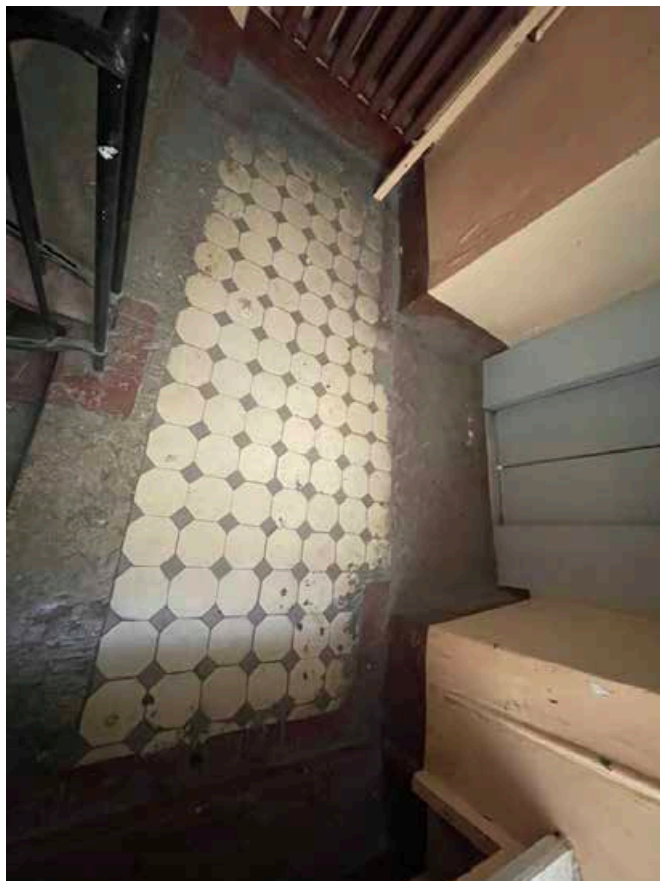
218. Покрытие пола аналогичной метлахской плиткой на лестничной площадке между вторым и третьим этажами лестничной клетки западного фасада.
