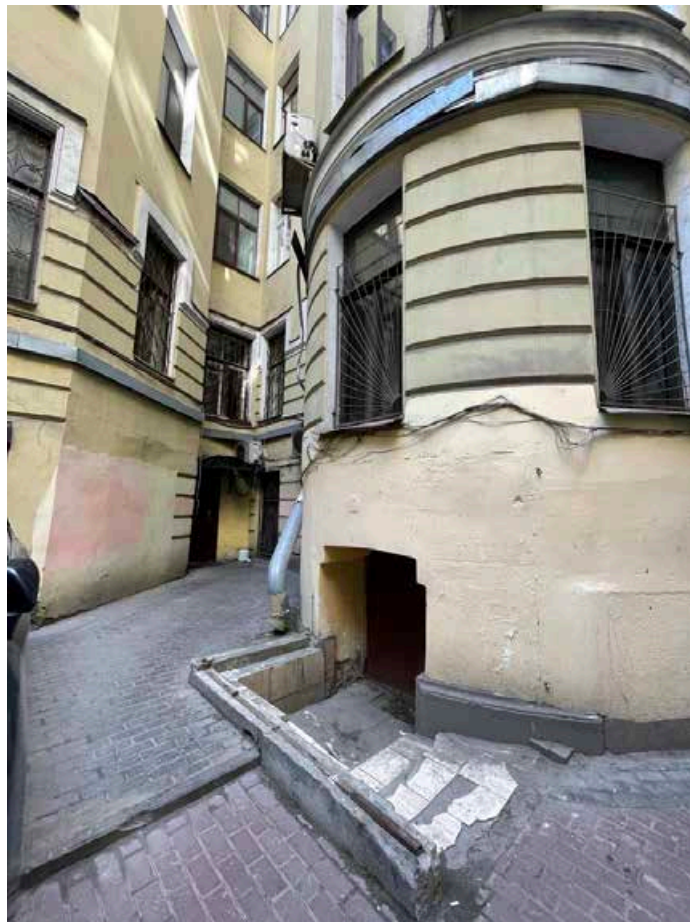
19. Фрагмент круглого ризалита северного фасада северного двора – дверной проем в подвальные помещения лестничной клетки с приямок.
