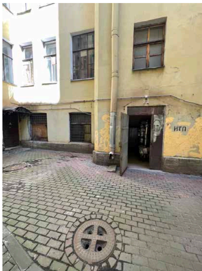
34. Фрагмент северного фасада южного двора. Цоколь отделан известняком. Дверной проем в ризалите ведет в ИТП под лестницей.
