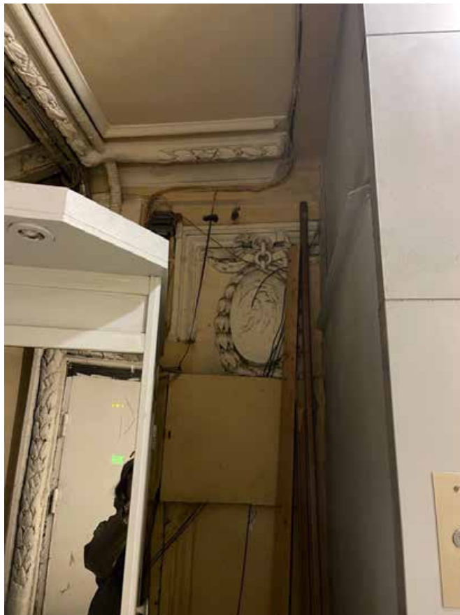
11. На стене рядом с лифтовой шахтой сохранился медальон с низким рельефом и цветочной гирляндой, аналогичный медальонам на стенах лестничных маршей.
