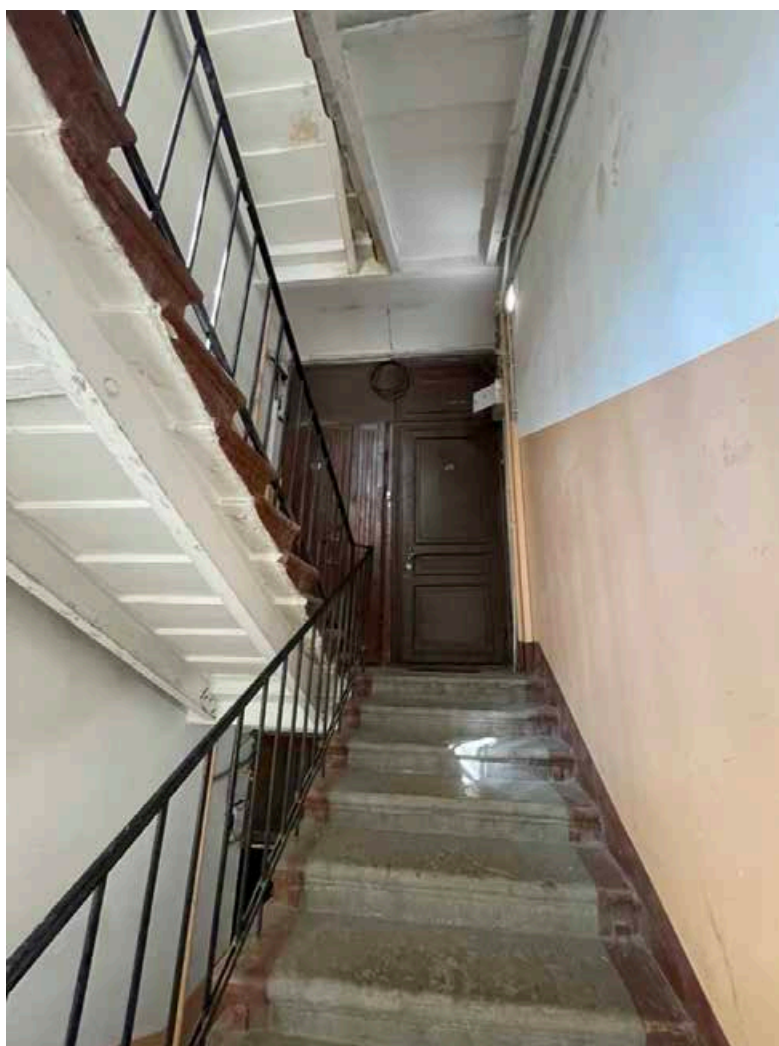
229. Общий вид лестничного марша с пятого на шестой этаж. Лестничная клетка западного фасада.
