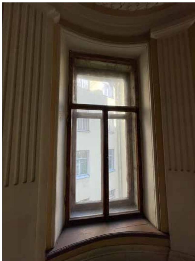
82. Оконный проем круглого ризалита лестничной площадки между четвертым и пятым этажами. Вид в восточную сторону.
