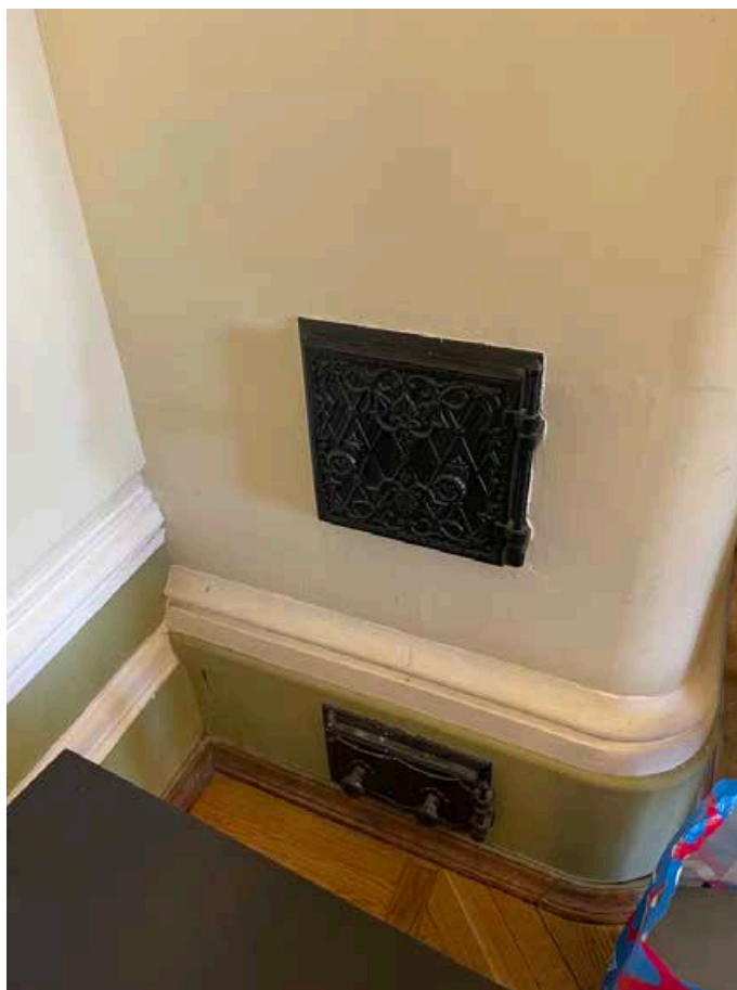
140. Дверцы металлические в печи в помещении 26(Н)-2.
