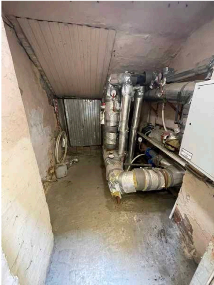
234. Общий вид помещения ИТП под лестницей южного фасада. Помещение 8-Н, вход со стороны южного двора.
