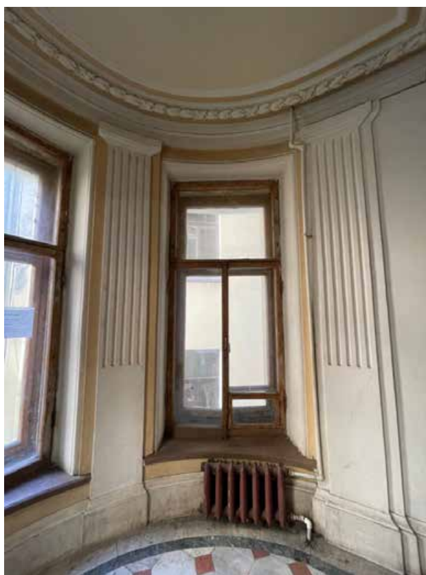
84. Оконный проем круглого ризалита лестничной площадки между четвертым и пятым этажами. Вид в западную сторону.
