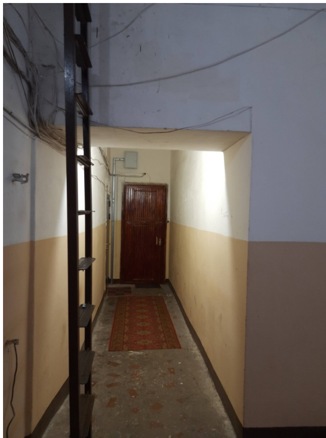
Фото 9 Входное дверное заполнение квартиры № выявленного объекта культурного наследия «Дом Р.С.Грובה» по адресу: Санкт-Петербург, Марата ул., д. 55/5, лит. А
