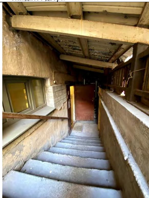
19.Общий вид примыкающего к северному дворовому фасаду объекта культурного наследия. Входы в пом. 1-Н и 14-Н в уровне подвального этажа.
