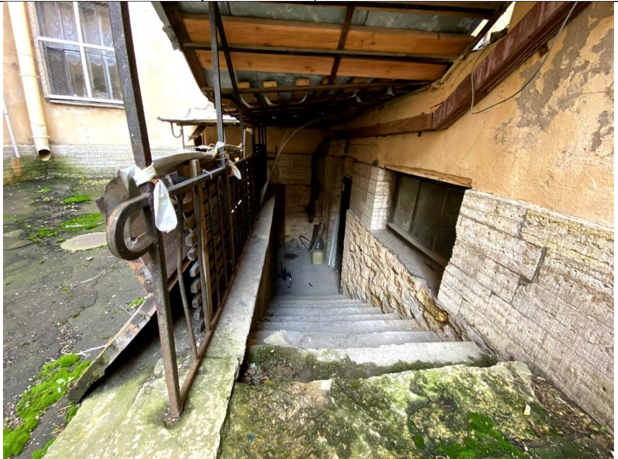
15. Общий вид прямка, примыкающего к южному дворовому фасаду объекта культурного наследия. Входы в пом. 1-Н и 15-Н в уровне подвального этажа.
