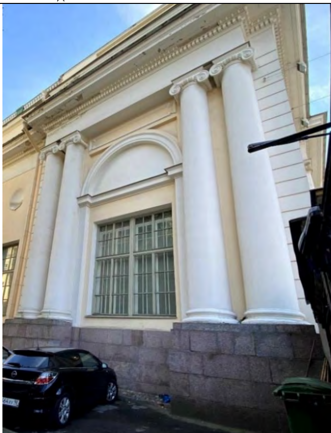
6. Боковой ризалит в западной части восточного северного лицевого фасада объекта культурного наследия.
