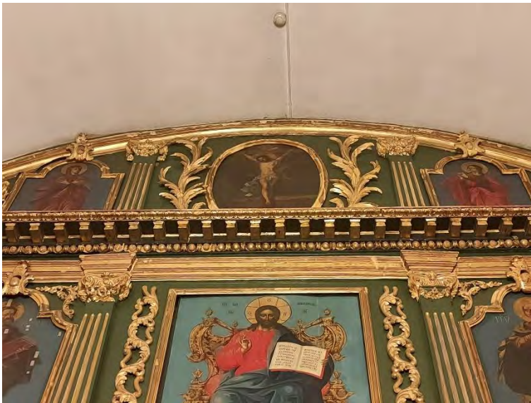
57. «Собор Сампсониевский», расположенный по адресу: г. Санкт-Петербург, Большой Сампсониевский пр., д. 41, лит. А. Иконостас южного придела Святого Архистратига Михаила. Фрагмент. Фото 17.11.2022г.
