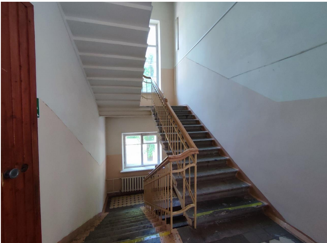
45. Объект культурного наследия регионального значения «Женская гимназия», по адресу: Санкт-Петербург, город Пушкин, Пушкинская улица, дом 28/21, литера А. Общий вид боковой лестничной клетки (пом. 4-Н (22)) в уровне 2-го этажа.
