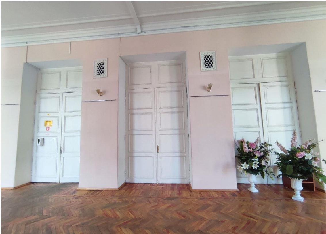
77. Объект культурного наследия регионального значения «Женская гимназия», по адресу: Санкт-Петербург, город Пушкин, Пушкинская улица, дом 28/21, литера А. Фрагмент пом. 6-Н (1) в уровне 4-го этажа. Заполнения дверных проемов пом. 6-Н (8).
