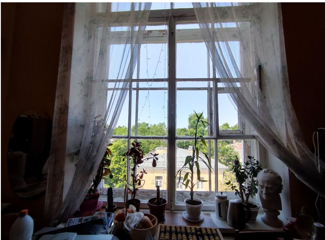
95. Объект культурного наследия регионального значения «Женская гимназия», по адресу: Санкт-Петербург, город Пушкин, Пушкинская улица, дом 28/21, литера А. Оконное заполнение в пом. 6-Н (11) в уровне 4-го этажа.
