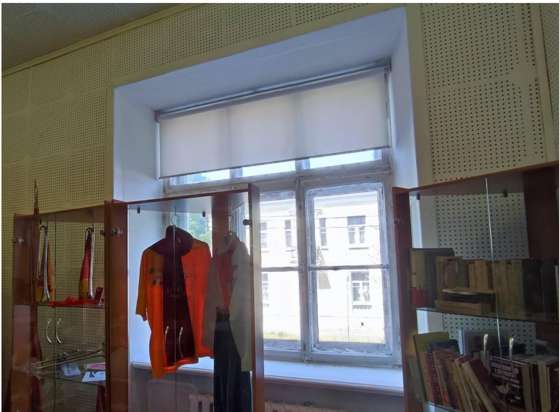
40. Объект культурного наследия регионального значения «Женская гимназия», по адресу: Санкт-Петербург, город Пушкин, Пушкинская улица, дом 28/21, литера А. Оконное заполнение в пом. 4-Н (18) в уровне 2-го этажа.
