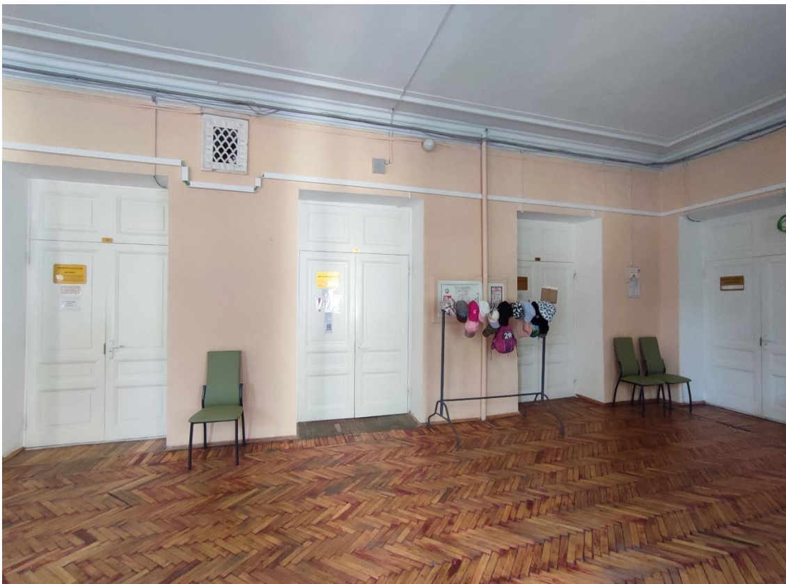
33. Объект культурного наследия регионального значения «Женская гимназия», по адресу: Санкт-Петербург, город Пушкин, Пушкинская улица, дом 28/21, литера А. Фрагмент пом. 4-Н (1) в уровне 2-го этажа. Заполнения дверных проемов пом. 4-Н (15, 16, 18).
