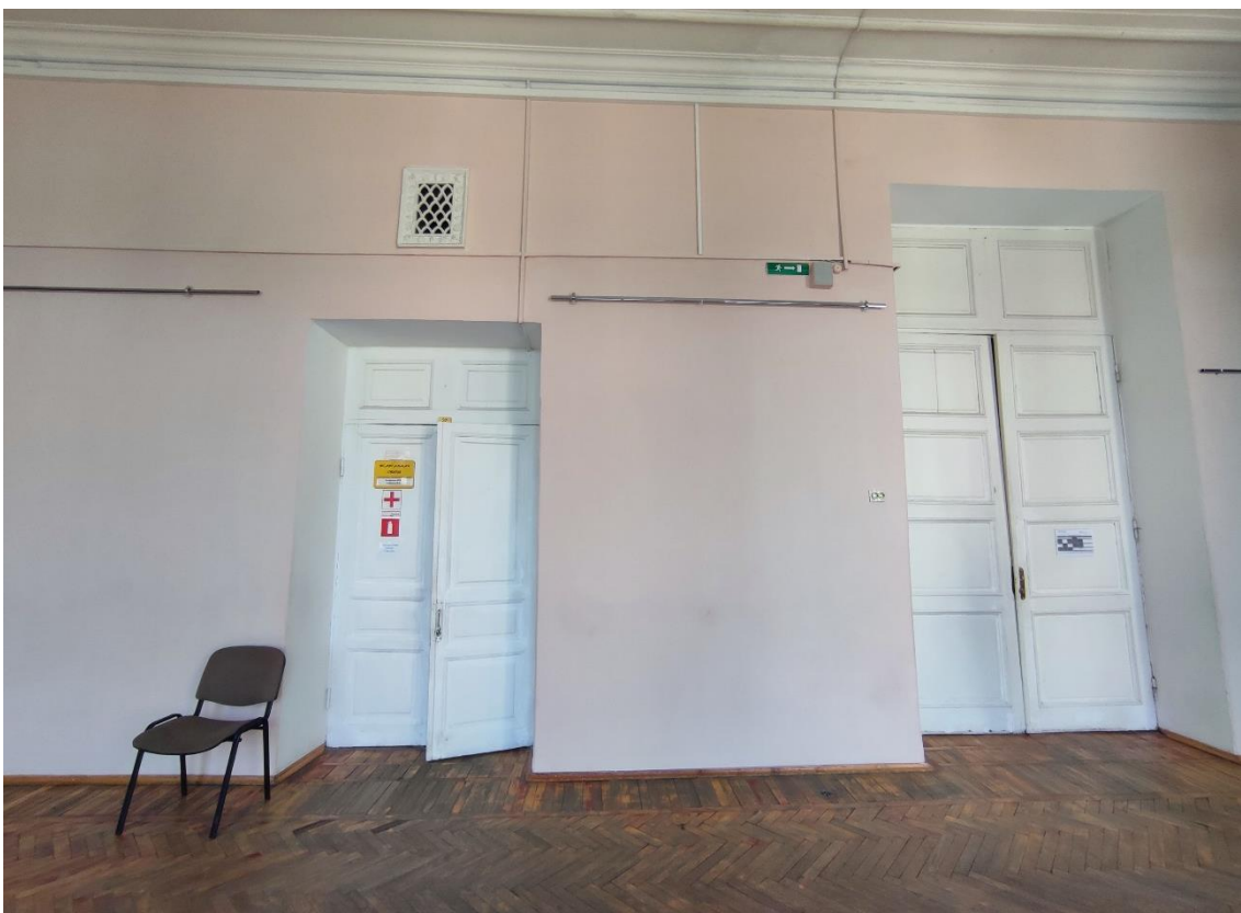
81. Объект культурного наследия регионального значения «Женская гимназия», по адресу: Санкт-Петербург, город Пушкин, Пушкинская улица, дом 28/21, литера А. Фрагмент пом. 6-Н (1) в уровне 4-го этажа. Заполнения дверных проемов пом. 6-Н (7, 8).
