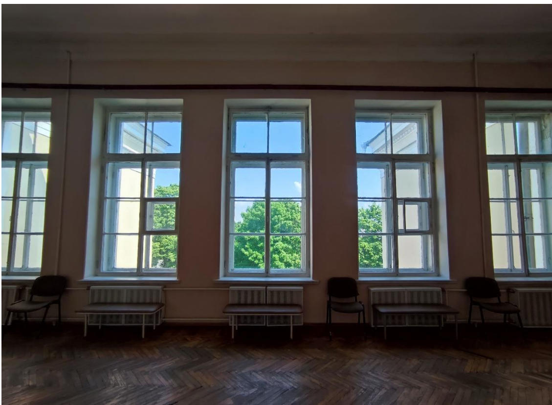
89. Объект культурного наследия регионального значения «Женская гимназия», по адресу: Санкт-Петербург, город Пушкин, Пушкинская улица, дом 28/21, литера А. Фрагмент пом. 6-Н (1) в уровне 4-го этажа.
