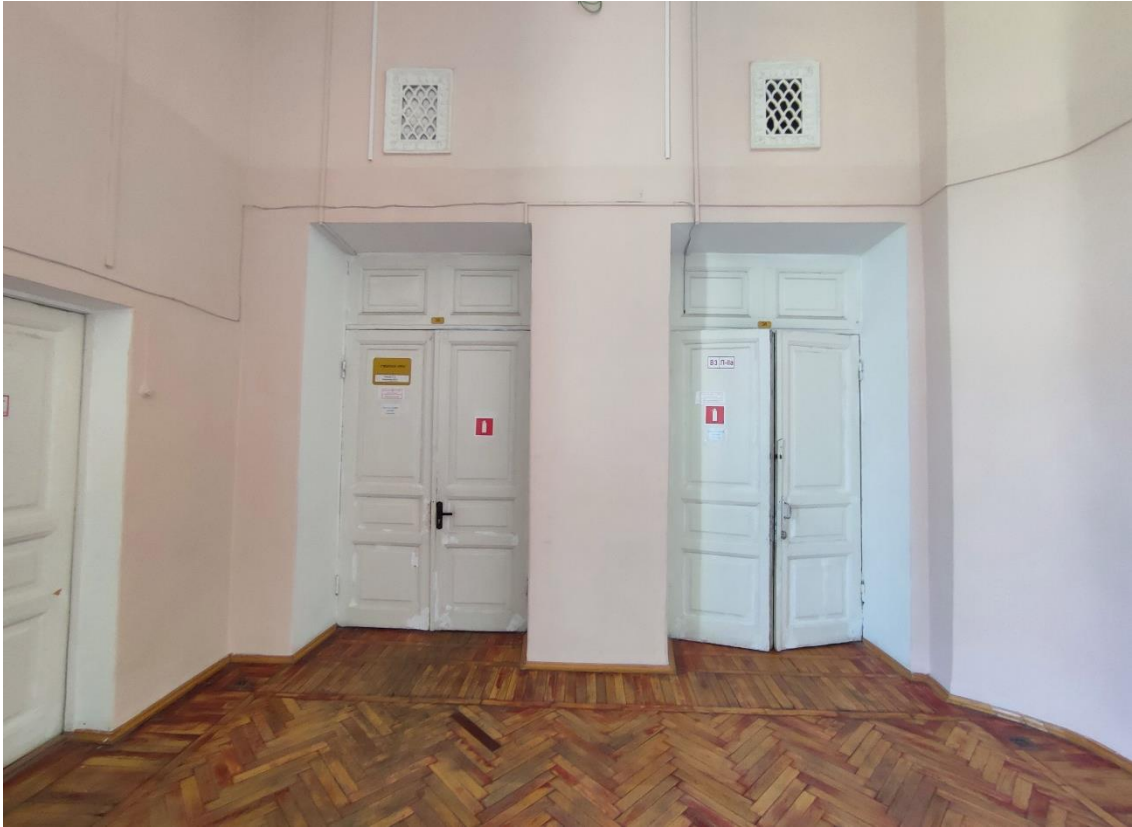
84. Объект культурного наследия регионального значения «Женская гимназия», по адресу: Санкт-Петербург, город Пушкин, Пушкинская улица, дом 28/21, литера А. Фрагмент пом. 6-Н (1) в уровне 4-го этажа. Заполнения дверных проемов пом. 6-Н (7, 8).
