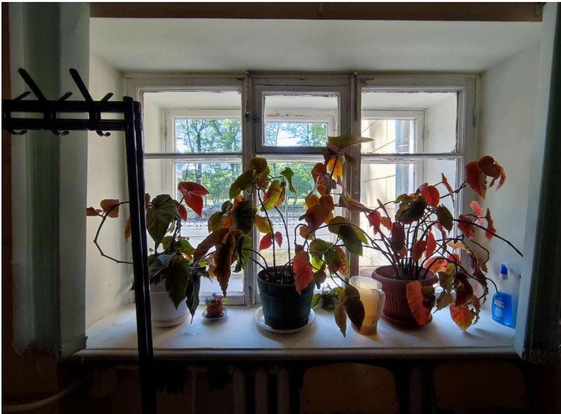
15. Объект культурного наследия регионального значения «Женская гимназия», по адресу: Санкт-Петербург, город Пушкин, Пушкинская улица, дом 28/21, литера А. Оконное заполнение в пом. 1-Н (2) в уровне 1-го этажа.
