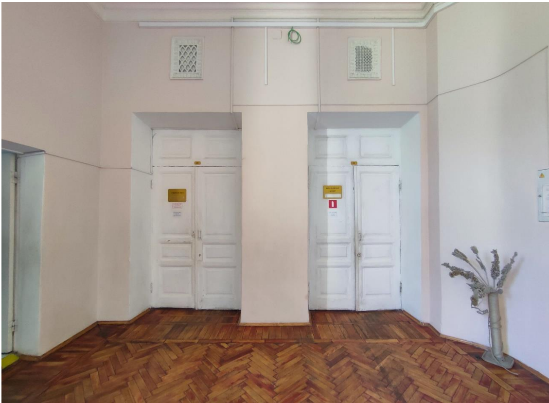
69. Объект культурного наследия регионального значения «Женская гимназия», по адресу: Санкт-Петербург, город Пушкин, Пушкинская улица, дом 28/21, литера А. Фрагмент пом. 5-Н (1) в уровне 3-го этажа. Заполнения дверных проемов пом. 5-Н (4, 5).
