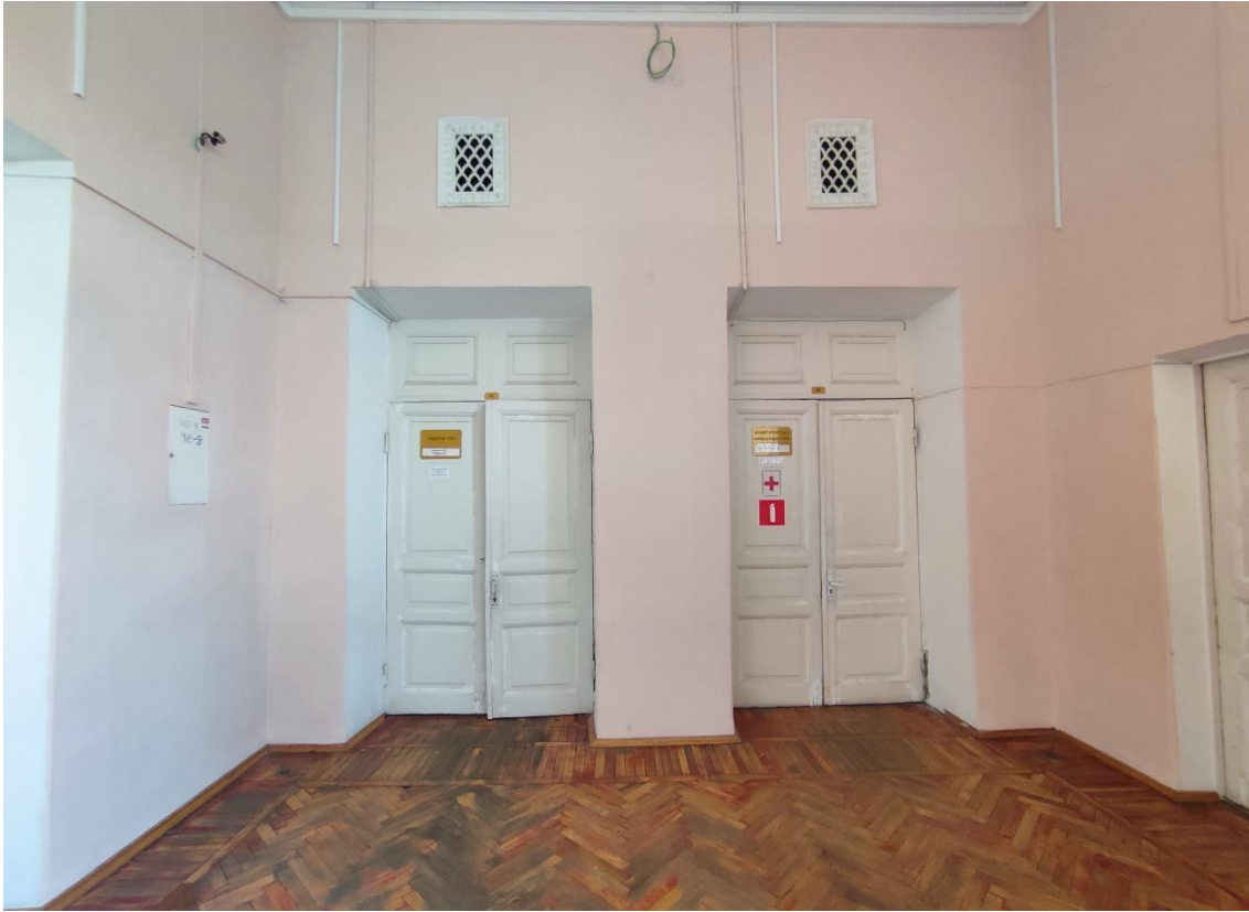
90. Объект культурного наследия регионального значения «Женская гимназия», по адресу: Санкт-Петербург, город Пушкин, Пушкинская улица, дом 28/21, литера А. Фрагмент пом. 6-Н (1) в уровне 4-го этажа. Заполнения дверных проемов пом. 6-Н (13, 15).
