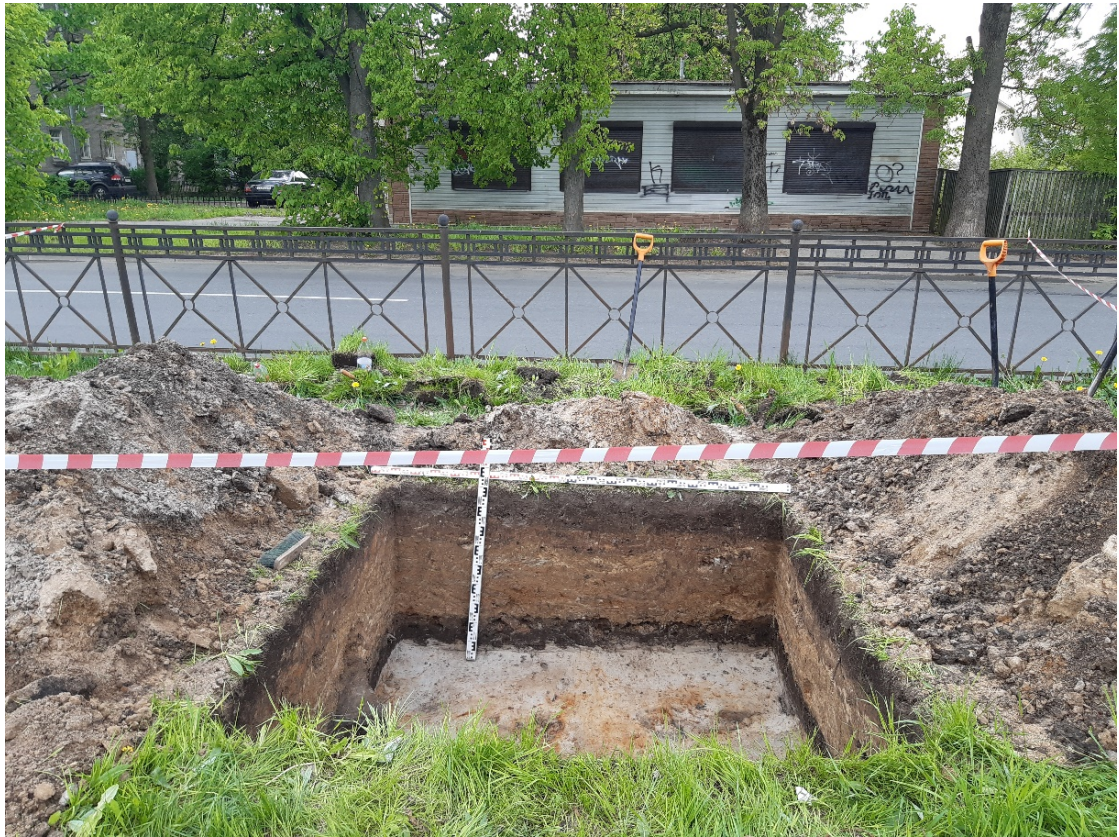
Рис.50. «Газопровод среднего давления для подключения (технологического присоединения) объекта капитального строительства на земельном участке по адресу: Санкт-Петербург, город Колпино, садоводство Ижорский массив №1, участок 17». Шурф 1. Фотофиксация по светло-серой супеси с ожелезнением (материку). Уровень остановки работ. Общий вид на запад.
