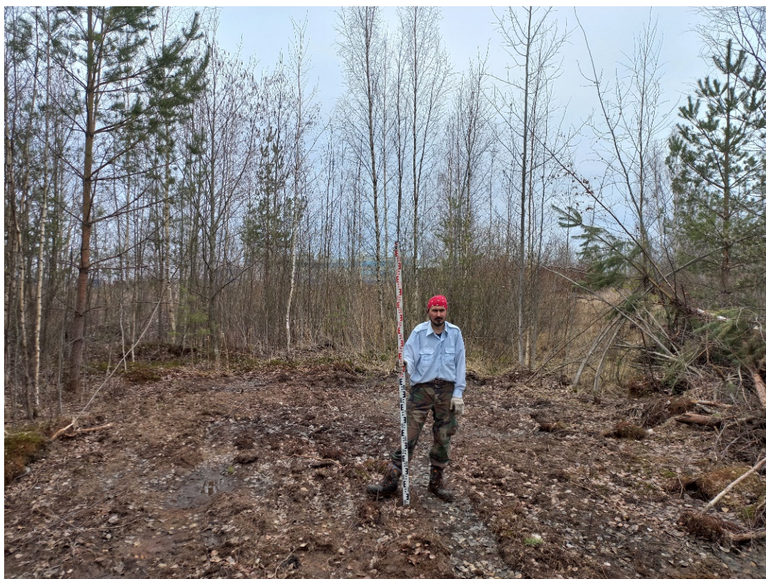
Рис. 37. Санкт-Петербург, поселок Стрельна, Заводская дорога, дом 11, литера А. Шурф 2. Общий вид до начала работ. Вид на восток.
