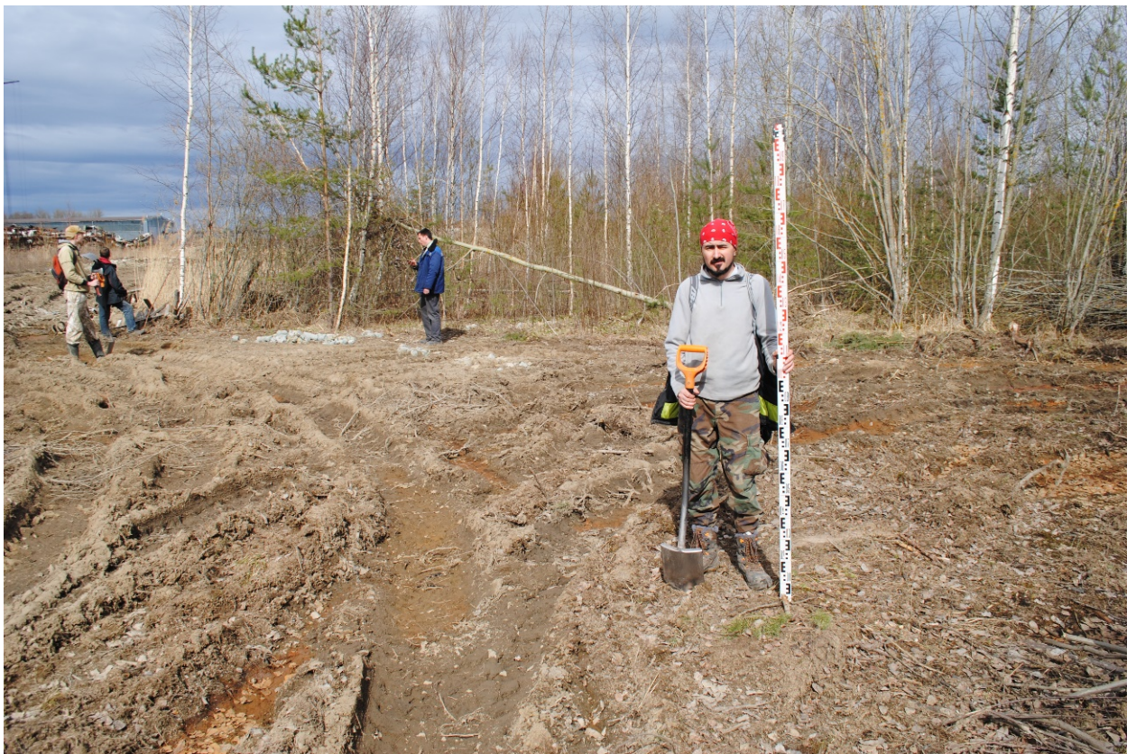
Рис.27. Санкт-Петербург, поселок Стрельна, Заводская дорога, дом 11, литера А. Общий вид трассы. Точка съемки 10 вид на север.
