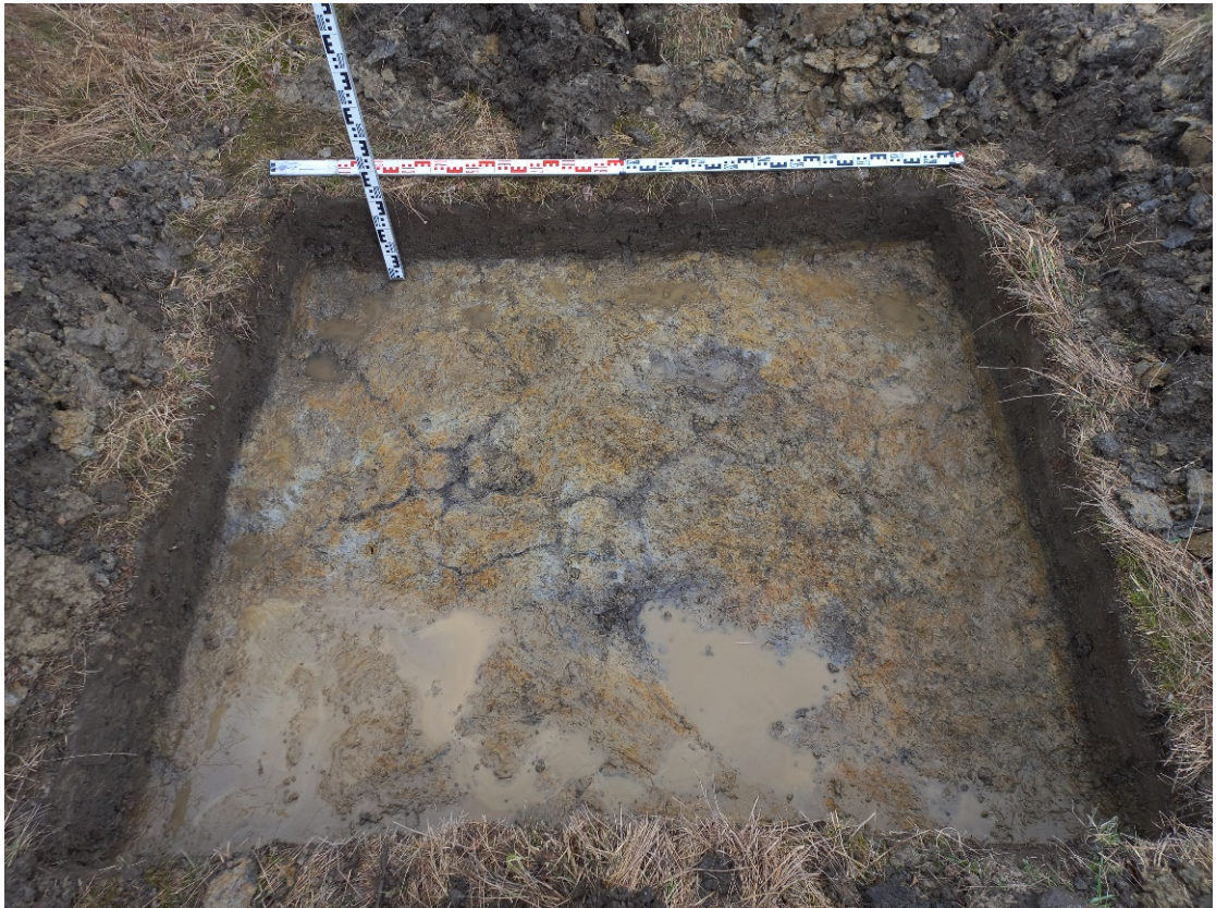
Рис.34. Санкт-Петербург, поселок Стрельна, Заводская дорога, дом 11, литера А. Шурф 1. Фотофиксация по уровню прекращения работ. Вид на восток.
