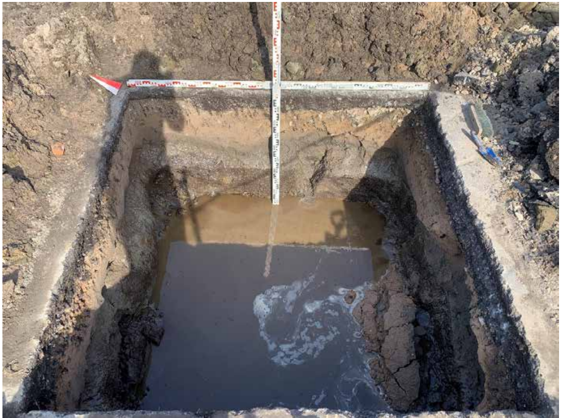
Рис. 73. СПб, Парголово, ул. Михаила Дудина, КН:78:36:0013101:20121-2023. Шурф 3. Фиксация по уровню окончания работ, вид на восток.
