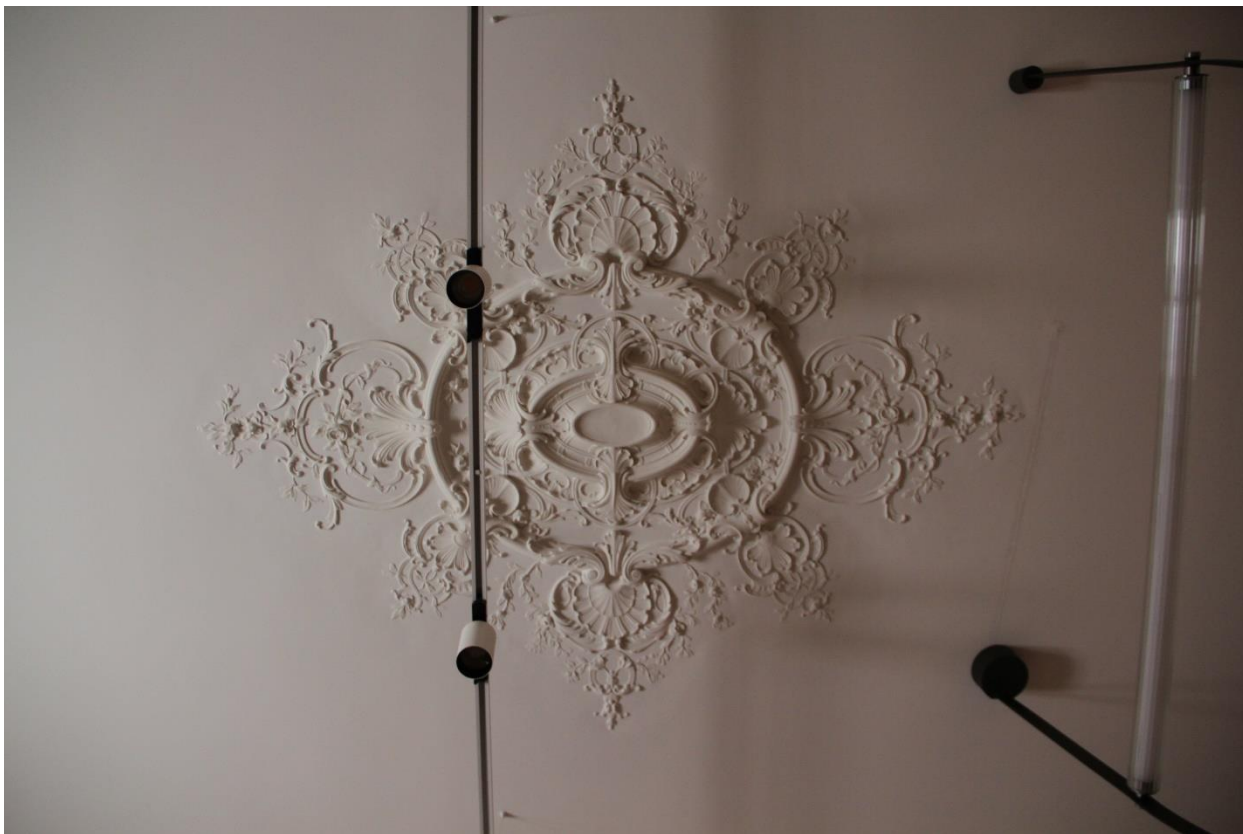
Фото 10. Розетка в помещении № 1.
