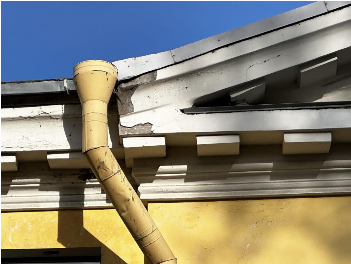
Фото 20. «Контора заводская», входящий в состав объекта культурного наследия федерального значения «Заводы ижорские адмиралтейские», Санкт-Петербург, г. Колпино, бульвар Победы, д. 1, литера АВ. Фрагмент лицевого западного фасада здания. Дата съемки: 26.04.2023 г. Автор съемки: Куваева Ю.П.
