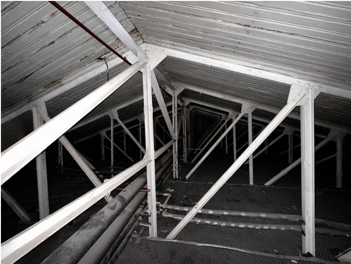
Фото 54. «Контора заводская», входящий в состав объекта культурного наследия федерального значения «Заводы ижорские адмиралтейские», Санкт-Петербург, г. Колпино, бульвар Победы, д. 1, литера АВ. Вид на восточную часть помещения чердака между осями 1-2 и Б-Г с запада. Дата съемки: 26.04.2023 г. Автор съемки: Куваева Ю.П.
