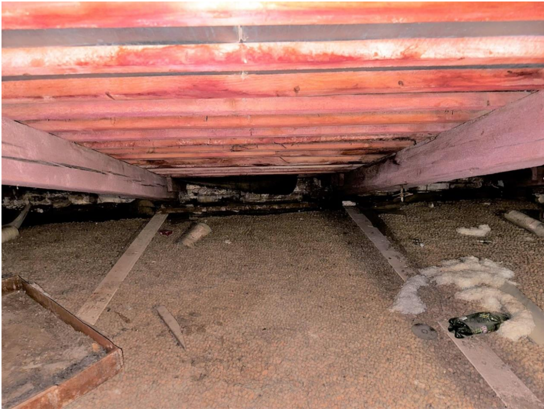
Фото 72. «Контора заводская», входящий в состав объекта культурного наследия федерального значения «Заводы ижорские адмиралтейские», Санкт-Петербург, г. Колпино, бульвар Победы, д. 1, литера АВ. Средняя часть помещения чердака между осями 9-10 и В-Г. Западный скат. Фото с востока. Дата съемки: 26.04.2023 г. Автор съемки: Куваева Ю.П.
