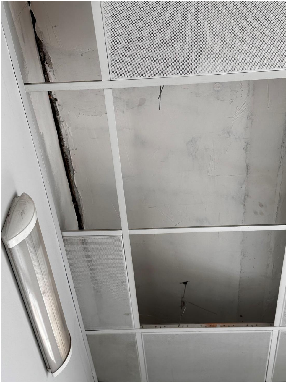
Фото 49. «Контора заводская», входящий в состав объекта культурного наследия федерального значения «Заводы ижорские адмиралтейские», Санкт-Петербург, г. Колпино, бульвар Победы, д. 1, литера АВ. 2-ой этаж. Помещение лестничной клетки между осями 20-21. Перекрытие в виде сводов «монье» по металлическим балкам. Дата съемки: 26.04.2023 г. Автор съемки: Куваева Ю.П.
