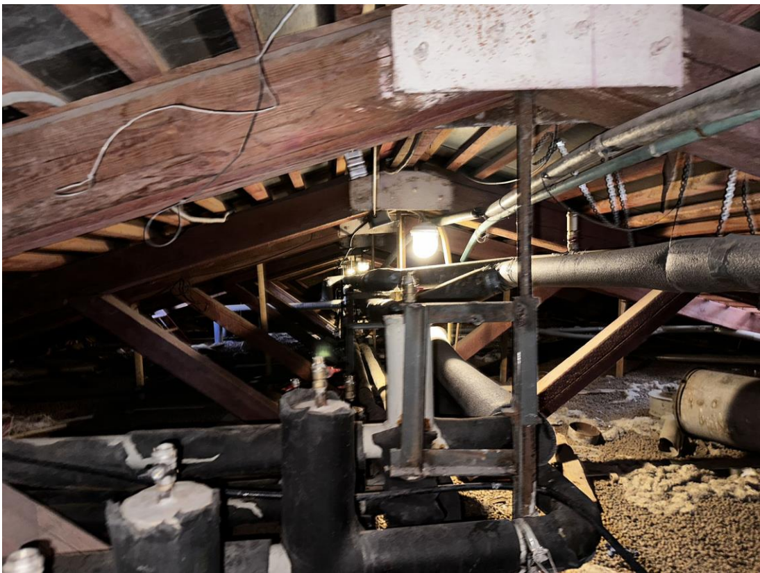
Фото 69. «Контора заводская», входящий в состав объекта культурного наследия федерального значения «Заводы ижорские адмиралтейские», Санкт-Петербург, г. Колпино, бульвар Победы, д. 1, литера АВ. Помещение чердака между осями 9-10 и В-Г. Общий вид северной части с севера. Дата съемки: 26.04.2023 г. Автор съемки: Куваева Ю.П.
