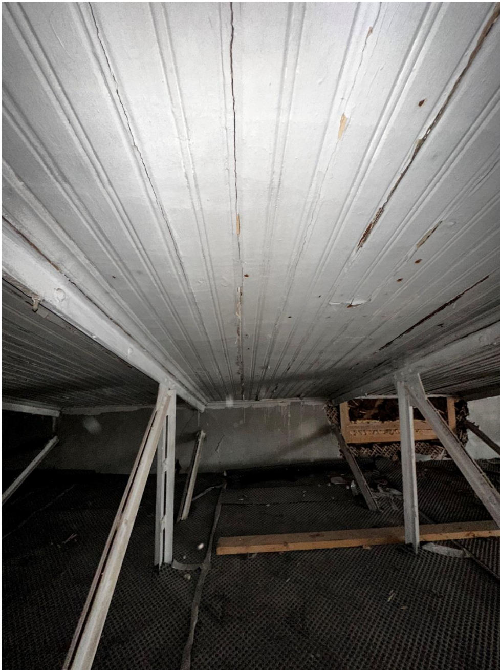
Фото 59. «Контора заводская», входящий в состав объекта культурного наследия федерального значения «Заводы ижорские адмиралтейские», Санкт-Петербург, г. Колпино, бульвар Победы, д. 1, литера АВ. Помещение чердака между осями 1-2 и Б-Г. Наружная (южная) стена на пересечении осей 1-В. Фото с севера. Дата съемки: 26.04.2023 г. Автор съемки: Куваева Ю.П.
