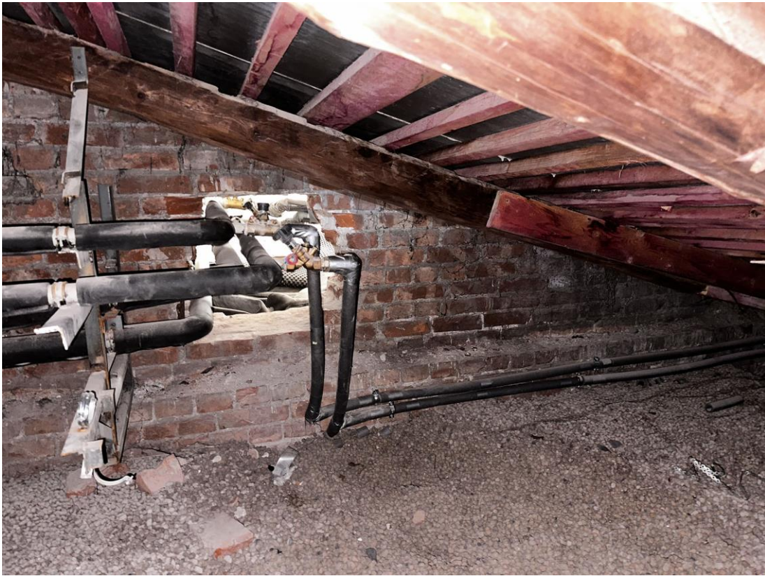
Фото 68. «Контора заводская», входящий в состав объекта культурного наследия федерального значения «Заводы ижорские адмиралтейские», Санкт-Петербург, г. Колпино, бульвар Победы, д. 1, литера АВ. Южная часть помещения чердака между осями 2-9 и В-Г. Западный скат. Поперечная стена по оси 2. Фото с севера. Дата съемки: 26.04.2023 г. Автор съемки: Куваева Ю.П.
