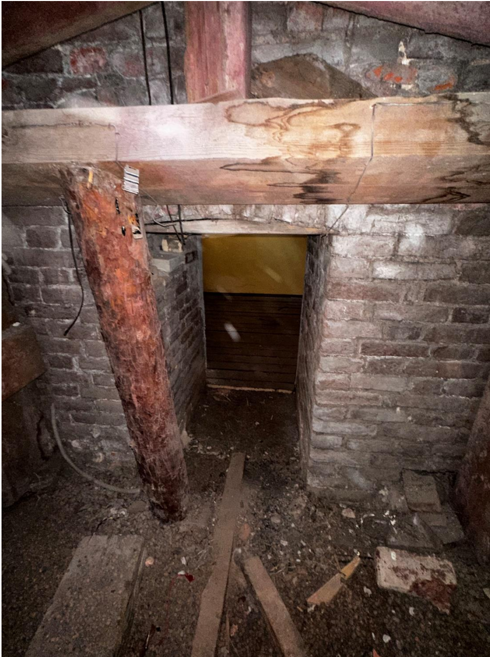
Фото 76. «Контора заводская», входящий в состав объекта культурного наследия федерального значения «Заводы ижорские адмиралтейские», Санкт-Петербург, г. Колпино, бульвар Победы, д. 1, литера АВ. Северная часть помещения чердака между осями 10-14 и В-Г. Вход в помещение основания башни. Фото с востока. Дата съемки: 26.04.2023 г. Автор съемки: Куваева Ю.П.
