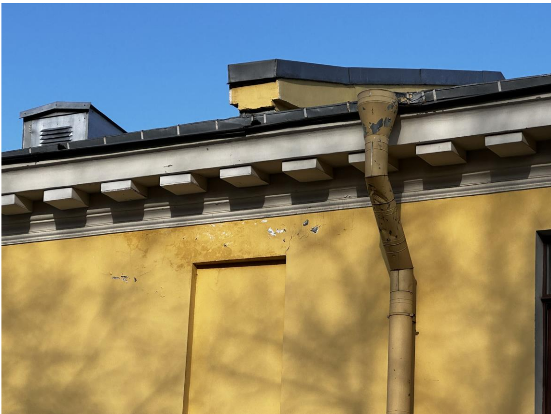
Фото 15. «Контора заводская», входящий в состав объекта культурного наследия федерального значения «Заводы ижорские адмиралтейские», Санкт-Петербург, г. Колпино, бульвар Победы, д. 1, литера АВ. Фрагмент лицевого западного фасада здания. Дата съемки: 26.04.2023 г. Автор съемки: Куваева Ю.П.
