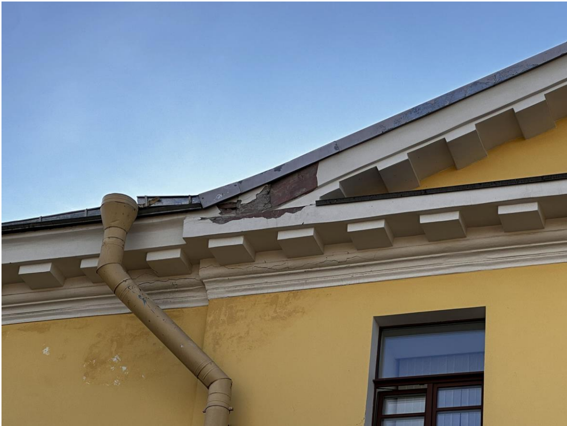
Фото 27. «Контора заводская», входящий в состав объекта культурного наследия федерального значения «Заводы ижорские адмиралтейские», Санкт-Петербург, г. Колпино, бульвар Победы, д. 1, литера АВ. Фрагмент дворового восточного фасада здания. Дата съемки: 26.04.2023 г. Автор съемки: Куваева Ю.П.
