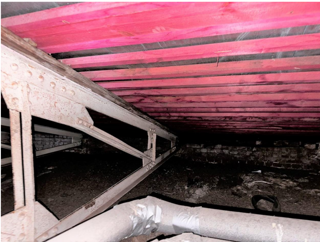
Фото 88. «Контора заводская», входящий в состав объекта культурного наследия федерального значения «Заводы ижорские адмиралтейские», Санкт-Петербург, г. Колпино, бульвар Победы, д. 1, литера АВ. Северная часть помещения чердака между осями 18-20 и В-Г. Западный скат. Фото с северо-востока. Дата съемки: 26.04.2023 г. Автор съемки: Куваева Ю.П.
