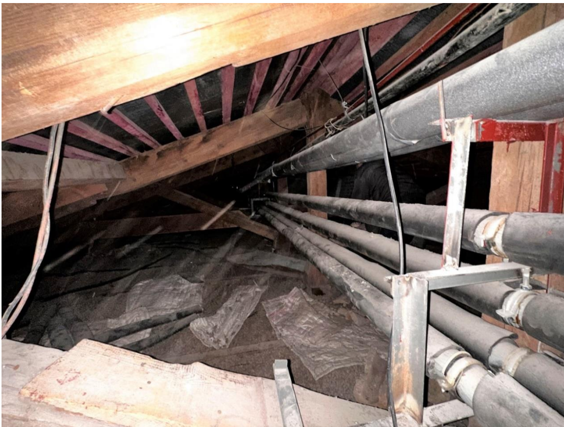
Фото 75. «Контора заводская», входящий в состав объекта культурного наследия федерального значения «Заводы ижорские адмиралтейские», Санкт-Петербург, г. Колпино, бульвар Победы, д. 1, литера АВ. Северная часть помещения чердака между осями 10-14 и В-Г. Восточный скат. Фото с севера. Дата съемки: 26.04.2023 г. Автор съемки: Куваева Ю.П.
