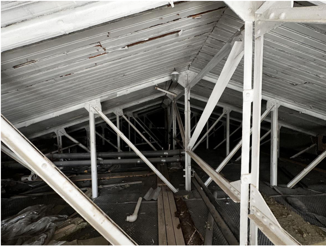
Фото 52. «Контора заводская», входящий в состав объекта культурного наследия федерального значения «Заводы ижорские адмиралтейские», Санкт-Петербург, г. Колпино, бульвар Победы, д. 1, литера АВ. Общий вид помещения чердака между осями 1-2 и Б-Г с запада. Дата съемки: 26.04.2023 г. Автор съемки: Куваева Ю.П.
