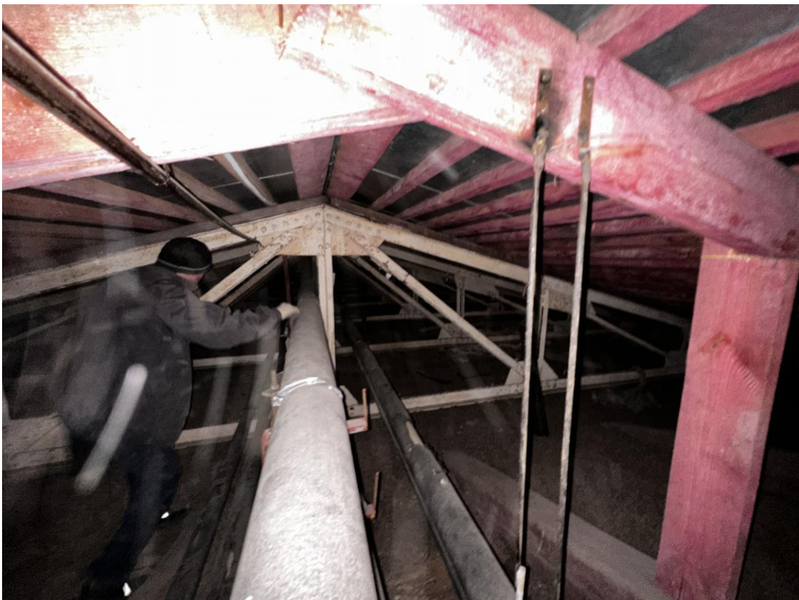
Фото 61. «Контора заводская», входящий в состав объекта культурного наследия федерального значения «Заводы ижорские адмиралтейские», Санкт-Петербург, г. Колпино, бульвар Победы, д. 1, литера АВ. Северная часть помещения чердака между осями 2-9 и В-Г. Общий вид с севера. Дата съемки: 26.04.2023 г. Автор съемки: Куваева Ю.П.
