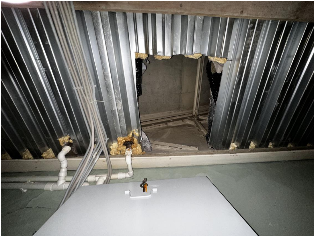
Фото 51. «Контора заводская», входящий в состав объекта культурного наследия федерального значения «Заводы ижорские адмиралтейские», Санкт-Петербург, г. Колпино, бульвар Победы, д. 1, литера АВ. Фрагмент исторического перекрытия над лестничной клеткой между осями 1-2 и А-Б. Дата съемки: 26.04.2023 г. Автор съемки: Куваева Ю.П.
