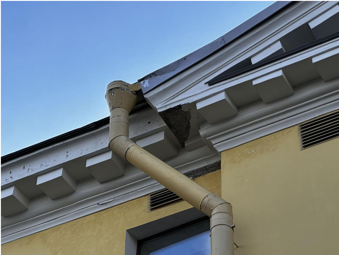
Фото 29. «Контора заводская», входящий в состав объекта культурного наследия федерального значения «Заводы ижорские адмиралтейские», Санкт-Петербург, г. Колпино, бульвар Победы, д. 1, литера АВ. Фрагмент дворового восточного фасада здания. Дата съемки: 26.04.2023 г. Автор съемки: Куваева Ю.П.
