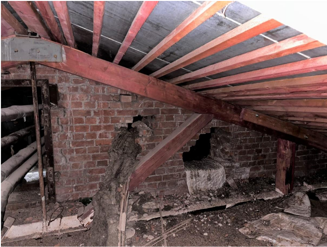
Фото 85. «Контора заводская», входящий в состав объекта культурного наследия федерального значения «Заводы ижорские адмиралтейские», Санкт-Петербург, г. Колпино, бульвар Победы, д. 1, литера АВ. Южная часть помещения чердака между осями 14-18. Западный скат. Поперечная стена по оси 14. Фото с северо-востока. Дата съемки: 26.04.2023 г. Автор съемки: Куваева Ю.П.
