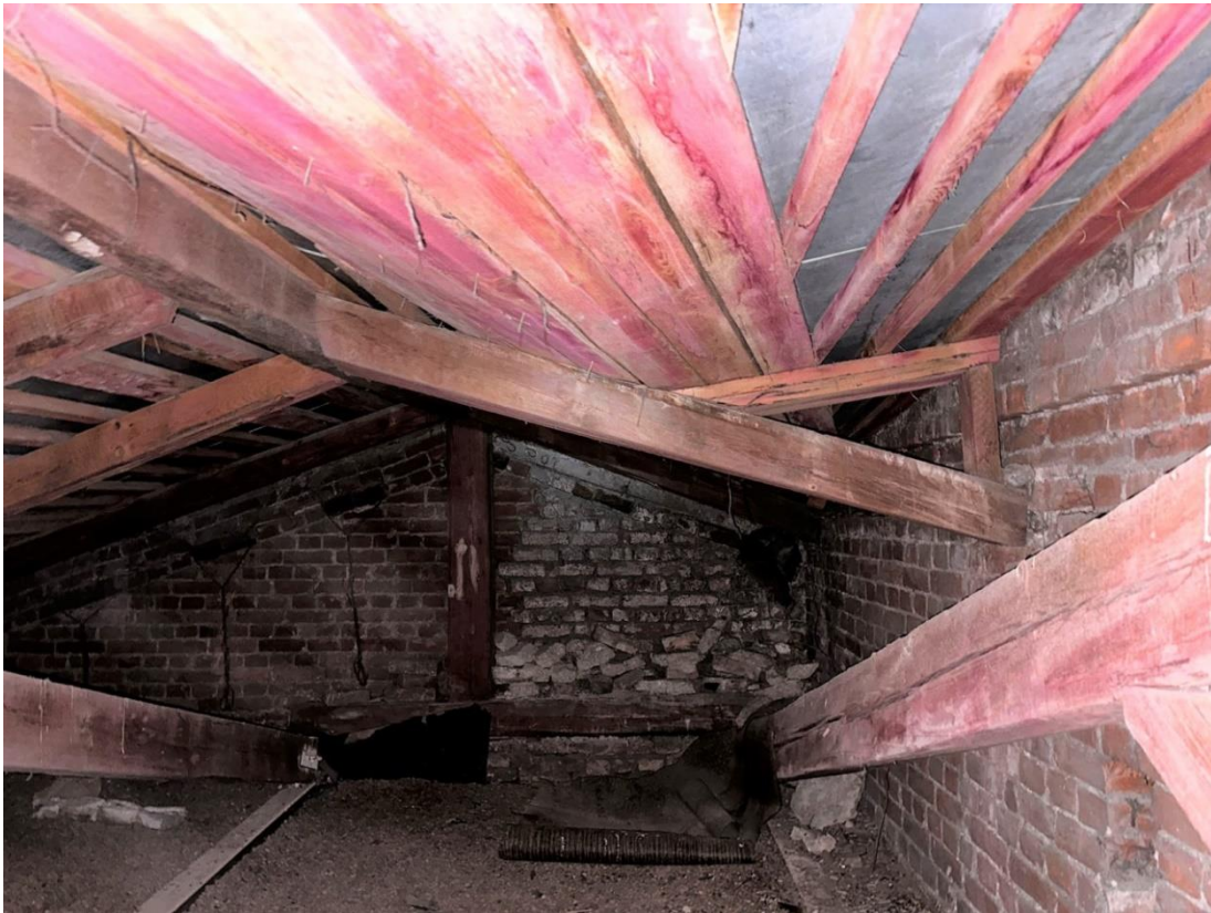
Фото 81. «Контора заводская», входящий в состав объекта культурного наследия федерального значения «Заводы ижорские адмиралтейские», Санкт-Петербург, г. Колпино, бульвар Победы, д. 1, литера АВ. Северная часть помещения чердака между осями 14-18 и В-Г. Западный скат. Вид на наружную (западную) стену по оси Г и поперечную стену по оси 18. Фото с востока. Дата съемки: 26.04.2023 г. Автор съемки: Куваева Ю.П.
