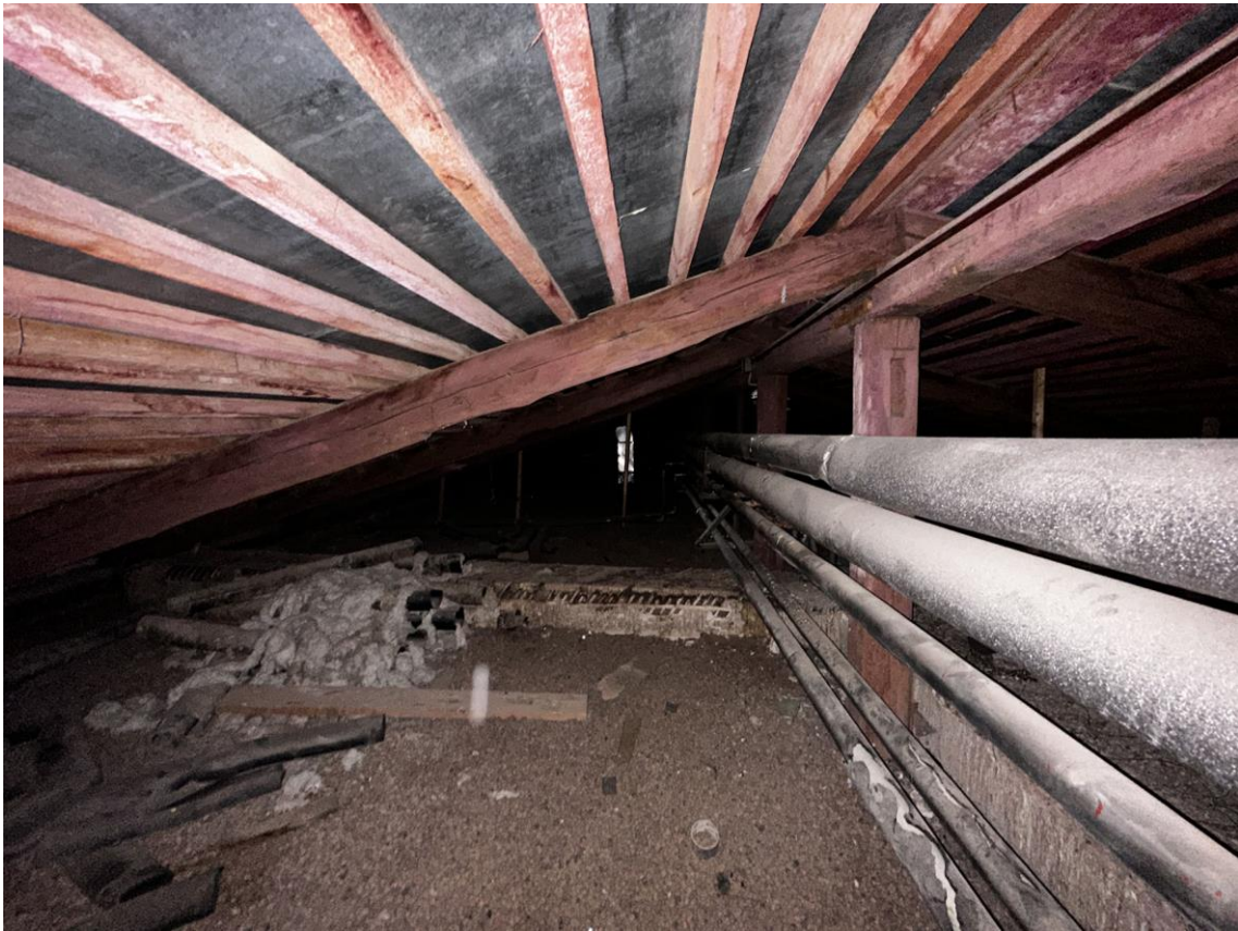
Фото 66. «Контора заводская», входящий в состав объекта культурного наследия федерального значения «Заводы ижорские адмиралтейские», Санкт-Петербург, г. Колпино, бульвар Победы, д. 1, литера АВ. Южная часть помещения чердака между осями 2-9 и В-Г. Восточный скат. Фото с севера. Дата съемки: 26.04.2023 г. Автор съемки: Куваева Ю.П.
