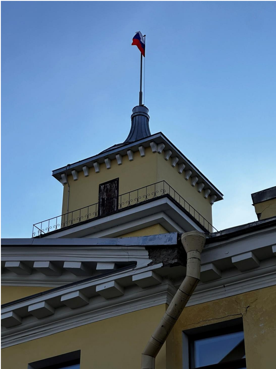
Фото 28. «Контора заводская», входящий в состав объекта культурного наследия федерального значения «Заводы ижорские адмиралтейские», Санкт-Петербург, г. Колпино, бульвар Победы, д. 1, литера АВ. Фрагмент центральной башни и фронтона со стороны двора, с северо-востока. Дата съемки: 26.04.2023 г. Автор съемки: Куваева Ю.П.
