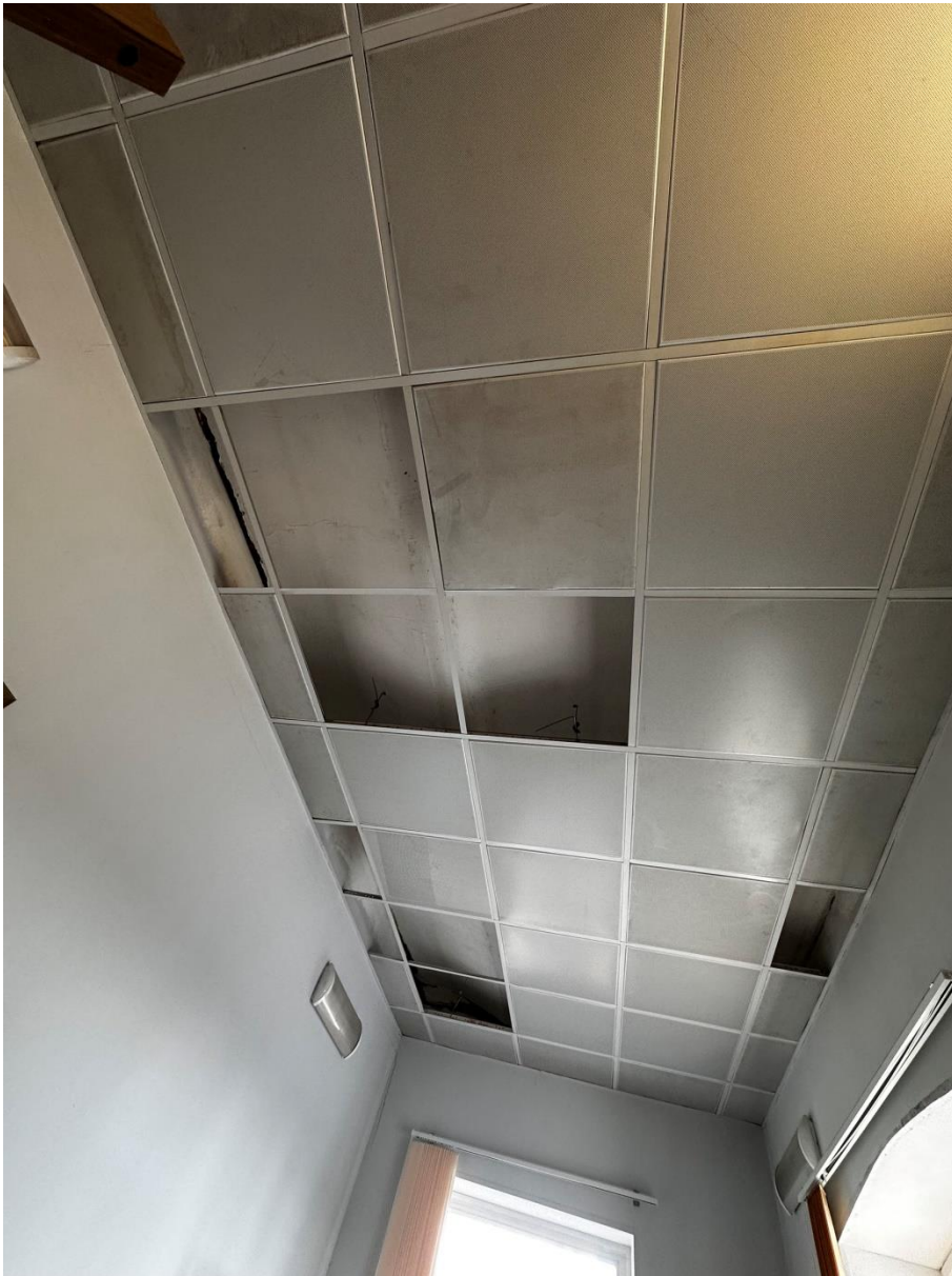
Фото 48. «Контора заводская», входящий в состав объекта культурного наследия федерального значения «Заводы ижорские адмиралтейские», Санкт-Петербург, г. Колпино, бульвар Победы, д. 1, литера АВ. 2-ой этаж. Помещение лестничной клетки между осями 20-21. Дата съемки: 26.04.2023 г. Автор съемки: Куваева Ю.П.
