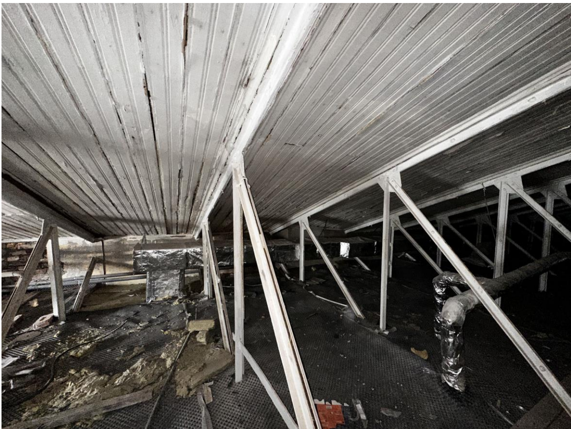
Фото 53. «Контора заводская», входящий в состав объекта культурного наследия федерального значения «Заводы ижорские адмиралтейские», Санкт-Петербург, г. Колпино, бульвар Победы, д. 1, литера АВ. Вид на среднюю (северную) часть помещения чердака между осями 1-2 и Б-Г с юга. Дата съемки: 26.04.2023 г. Автор съемки: Куваева Ю.П.
