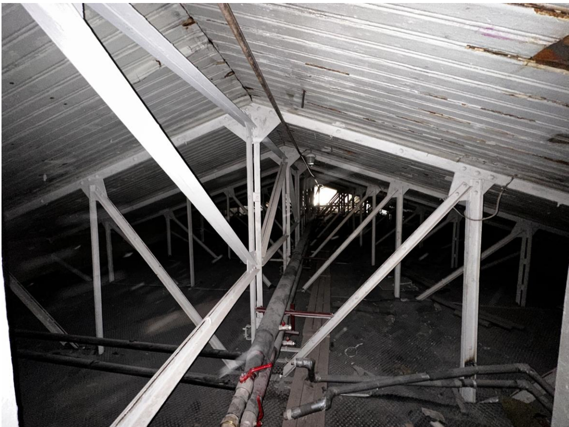
Фото 55. «Контора заводская», входящий в состав объекта культурного наследия федерального значения «Заводы ижорские адмиралтейские», Санкт-Петербург, г. Колпино, бульвар Победы, д. 1, литера АВ. Общий вид помещения чердака между осями 1-2 и Б-Г. Дата съемки: 26.04.2023 г. Автор съемки: Куваева Ю.П.
