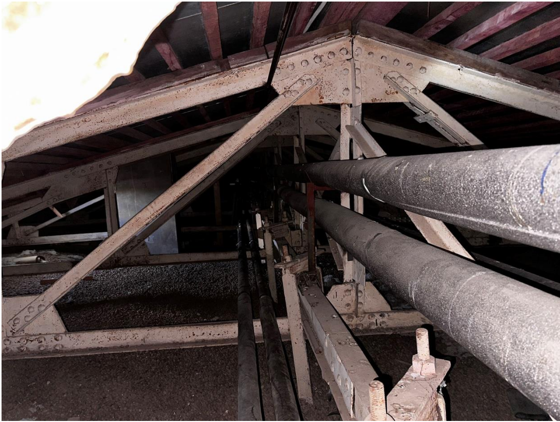
Фото 62. «Контора заводская», входящий в состав объекта культурного наследия федерального значения «Заводы ижорские адмиралтейские», Санкт-Петербург, г. Колпино, бульвар Победы, д. 1, литера АВ. Средняя часть помещения чердака между осями 2-9 и В-Г. Общий вид с севера. Дата съемки: 26.04.2023 г. Автор съемки: Куваева Ю.П.
