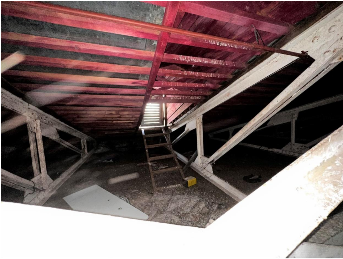
Фото 89. «Контора заводская», входящий в состав объекта культурного наследия федерального значения «Заводы ижорские адмиралтейские», Санкт-Петербург, г. Колпино, бульвар Победы, д. 1, литера АВ. Средняя часть помещения чердака между осями 18-20 и В-Г. Восточный скат. Фото с северо-запада. Дата съемки: 26.04.2023 г. Автор съемки: Куваева Ю.П.
