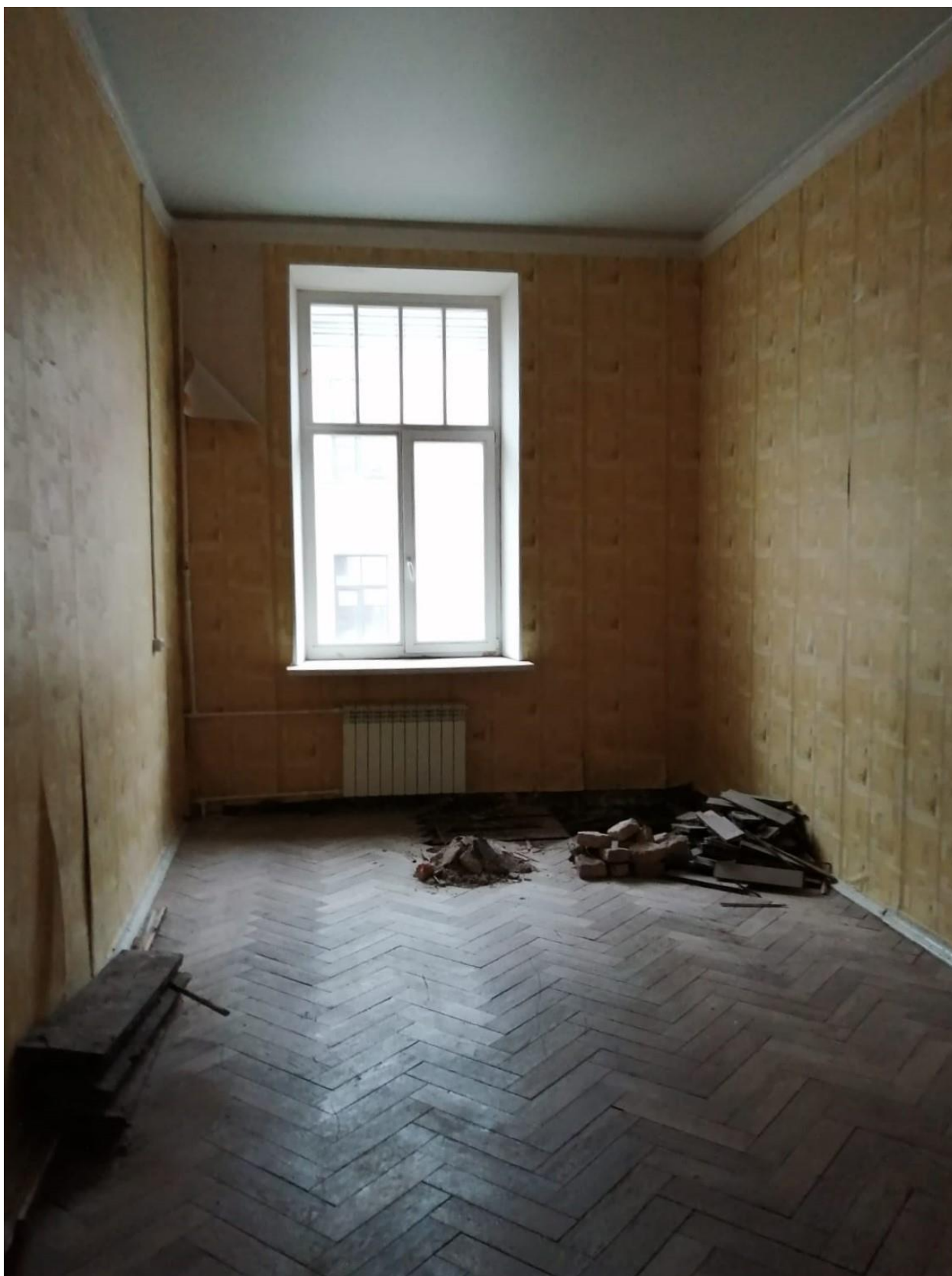
Фото 20. Объект культурного наследия регионального значения «Здание второй гимназии императора Александра I с жилым домом», Санкт-Петербург, Казанская улица, дом 27, литера А. Квартира 3, помещение 13. Заполнение оконного проема.
