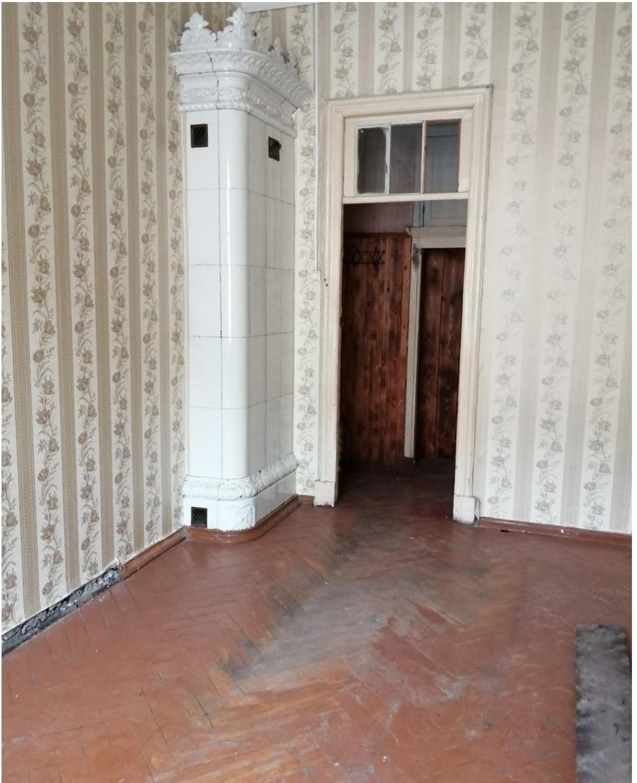
Фото 19. Объект культурного наследия регионального значения «Здание второй гимназии императора Александра I с жилым домом», Санкт-Петербург, Казанская улица, дом 27, литера А. Квартира 3, помещение 12. Печь (междустенная, одноярусная, на два помещения): облицовка – глазурованный белый изразец; плинт и навершие – рельефный изразец; плинт с растительным орнаментом, волнитообразными завитками, пальметтами; навершие – в виде фризов из плетенки, розовых гирлянд, профилированного карниза с пальметтами и волнитообразными завитками; аттик – в виде фриза из волнитообразных завитков с пальметтами; дверца топки – латунная.
