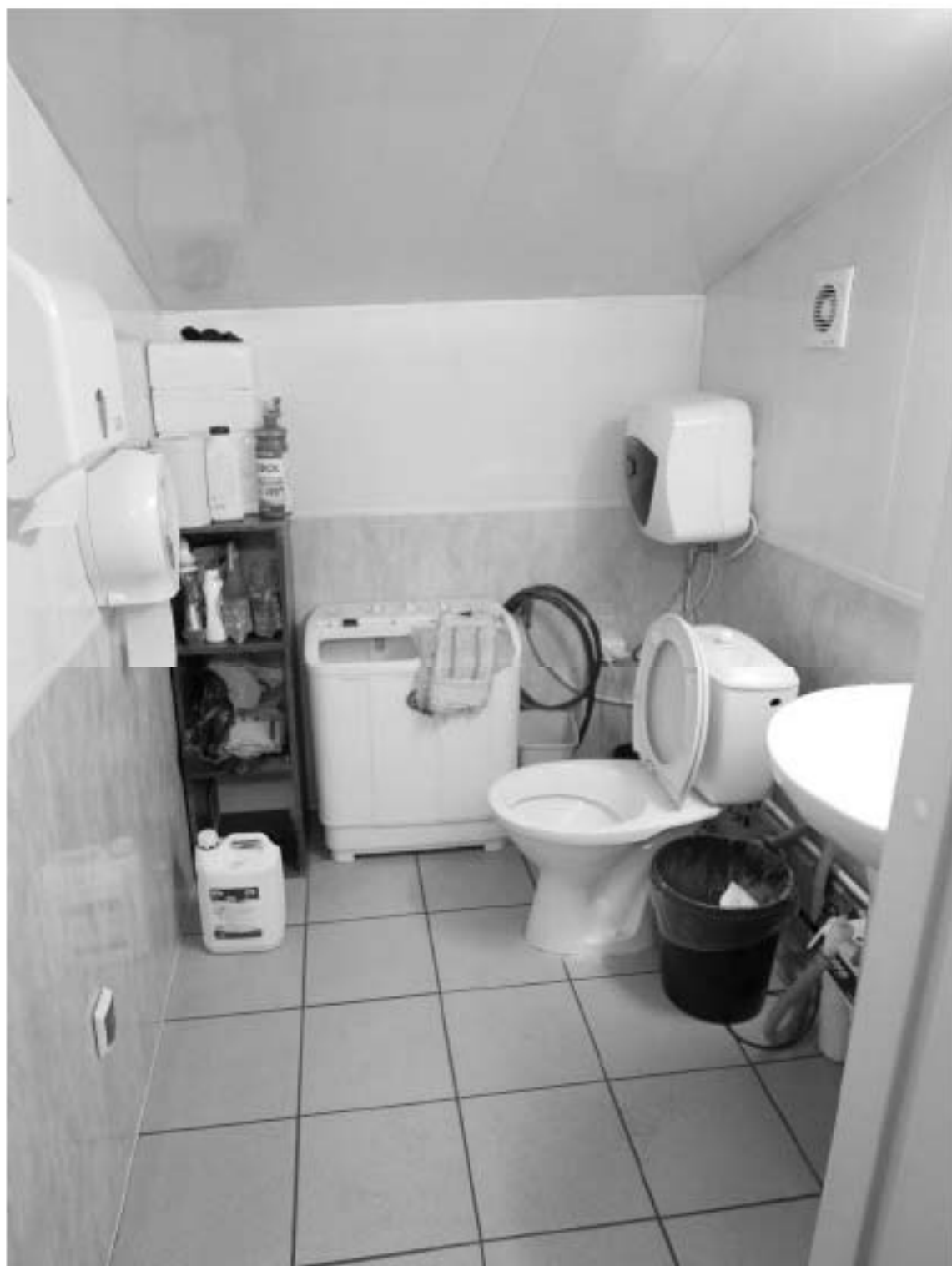
309. «Дом Н.Я. и Ф.Я. Колобовых». Санкт-Петербург, Большой пр. П.С., 16-18; Красного курсанта ул., д.1; Пионерская ул., д.6, литера А. Большой пр. П.С., 18. 6-й этаж. Помещение 11-Н. Санузел. Фото: 21.03. 2023.
