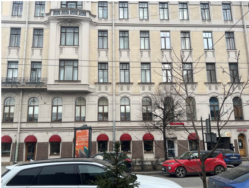
6. Выявленный объект культурного наследия «Дом А.Д.и Н.К.Чижовых». Фрагмент лицевого фасада по ул. Чайковского. Эркер. Столярное заполнение оконных проемов.
