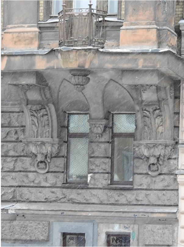
17. «Дом М.В. Захарова», Большой Казачий переулок, д.6, лит. А. Северо-западный фасад. Фрагмент. Фото 06.02.2023г.
