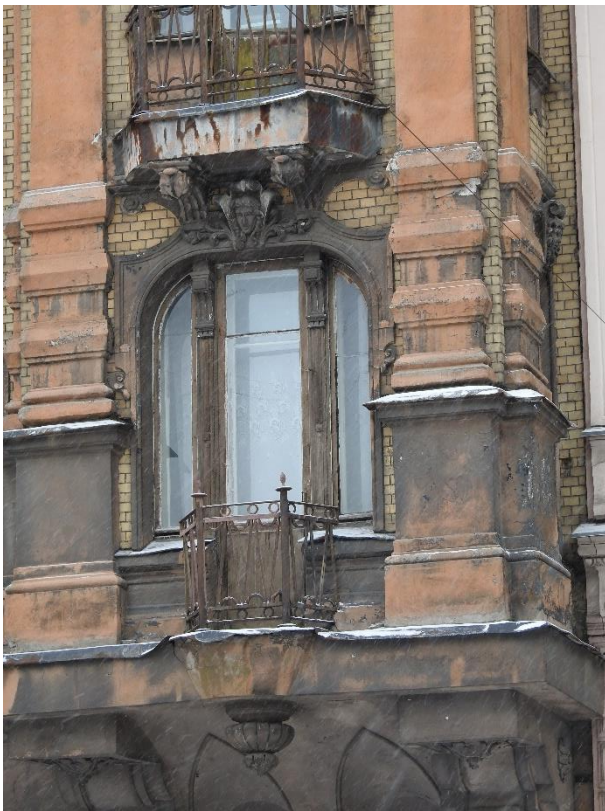
20. «Дом М.В. Захарова», Большой Казачий переулок, д.6, лит. А. Северо-западный фасад. Фрагмент. Фото 06.02.2023г.
