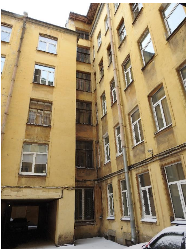
34. «Дом М.В. Захарова», Большой Казачий переулок, д.6, лит. А. Северо-западный фасад внутреннего двора. Фрагмент. Фото 06.02.2023г.
