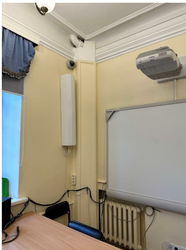
Фото 18. Класс 2-ого этажа – разводка системы отопления (Пом. 20)
