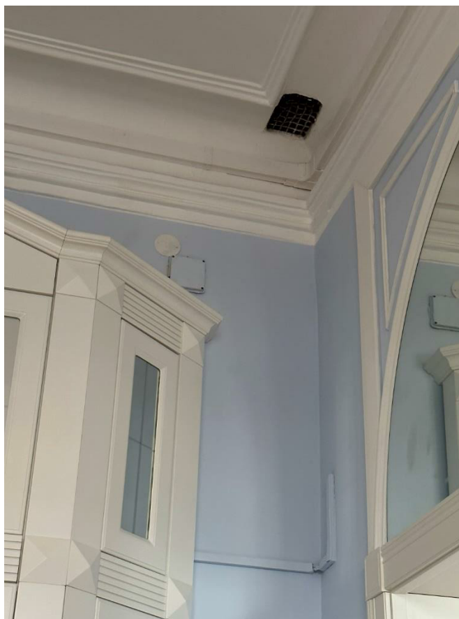
Фото 15. Вентиляционная решетка в холле 1-ого этажа (Пом. 030)
