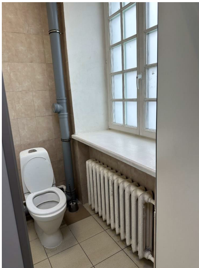
Фото 30. Туалет 2-ого этажа – разводка системы отопления (Пом. 056)
