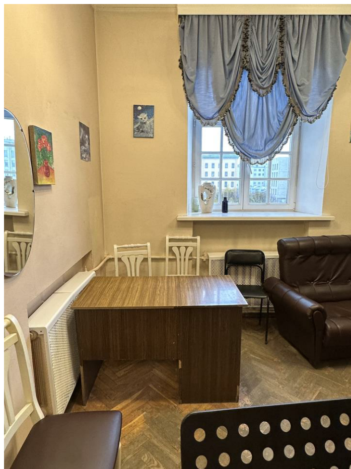
Фото 26. Класс 3-его этажа – разводка системы отопления (Пом. 31)
