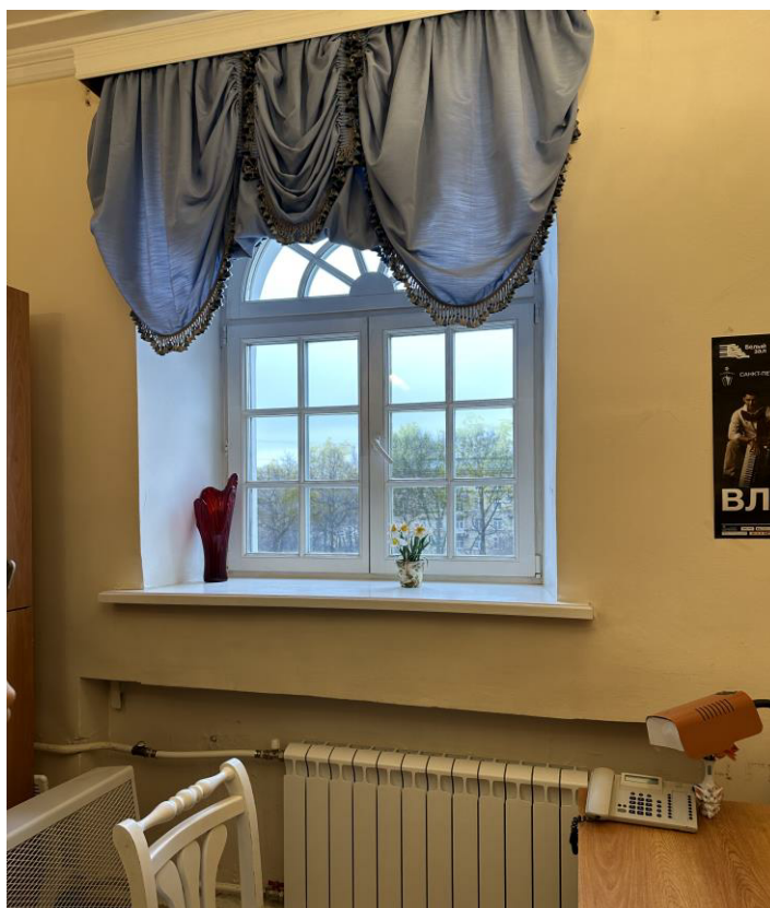
Фото 27. Класс 3-его этажа – разводка системы отопления (Пом. 29)
