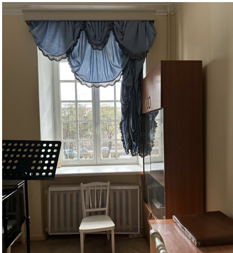
Фото 23. Класс 2-ого этажа – разводка системы отопления (Пом. 17)
