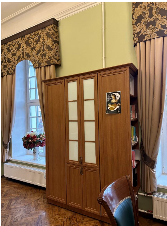
Фото 22. Канцелярия – система отопления (1 этаж) (Пом. 031)
