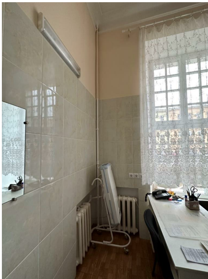
Фото 29. Мед.кабинет (1 этаж) – разводка системы отопления (Пом. 035)
