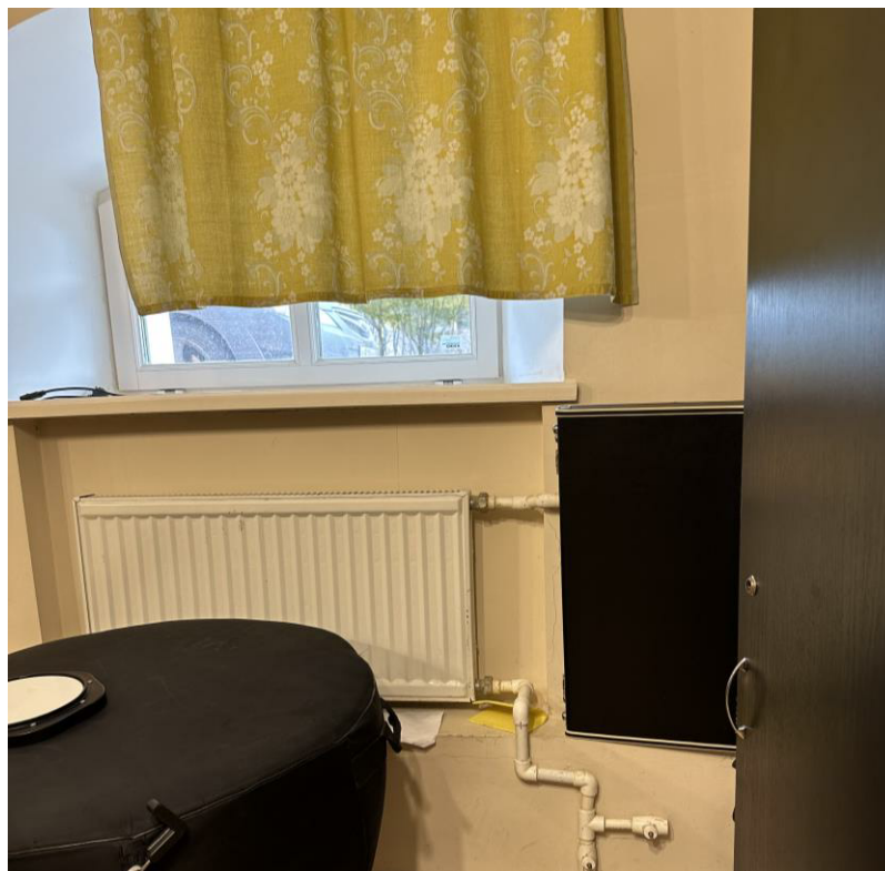
Фото 21. Помещение цокольного этажа – разводка системы отопления (Пом. 026)
