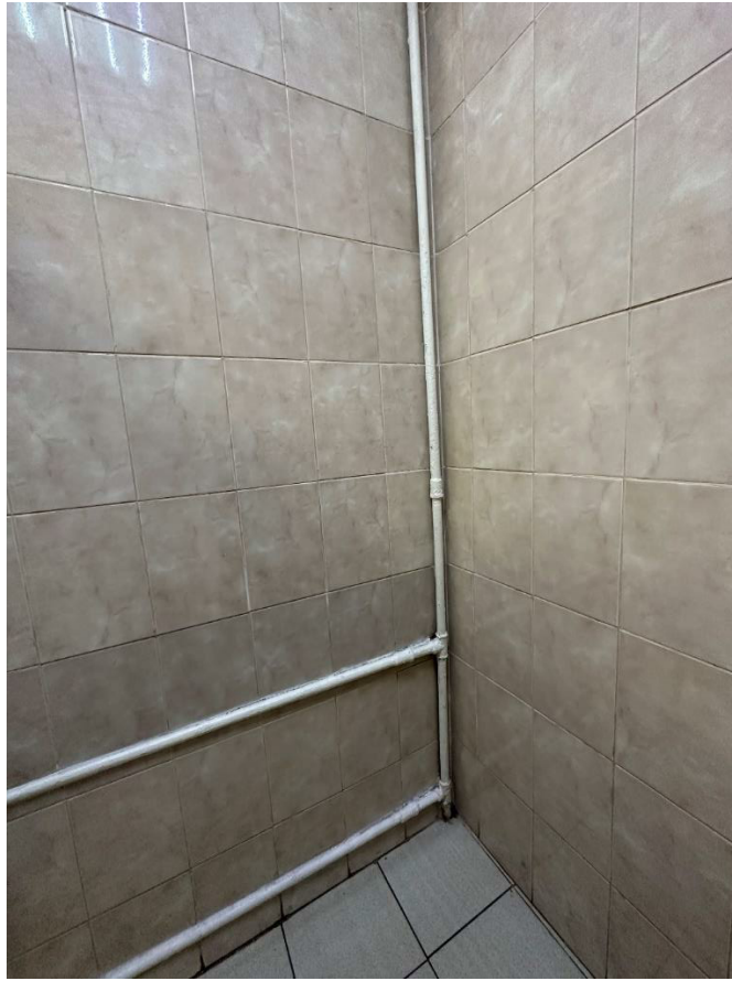
Фото 31. Туалет 2-ого этажа – разводка системы отопления (Пом. 059)
