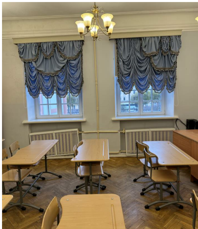
Фото 25. Класс 2-ого этажа – разводка системы отопления (Пом. 22)
