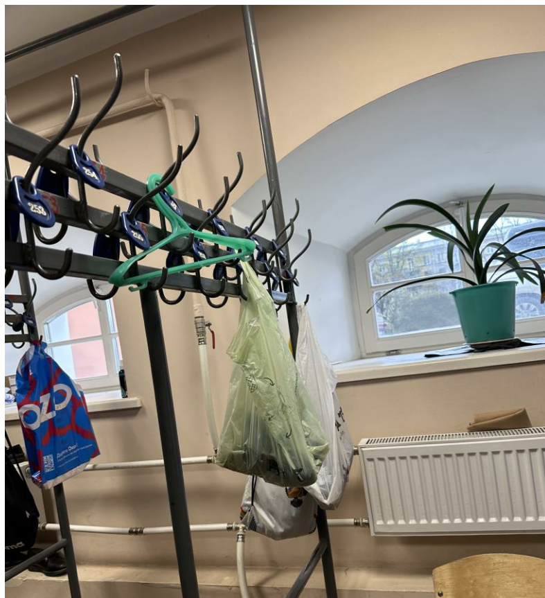
Фото 19. Разводка системы отопления в гардеробе (цокольный этаж) (Пом. 08)
