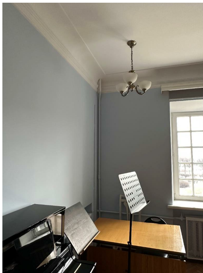
Фото 24. Класс 2-ого этажа – разводка системы отопления (Пом. 18)
