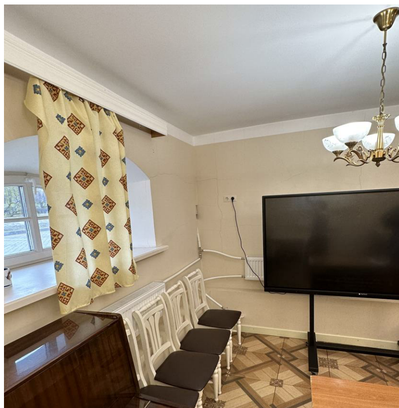
Фото 20. Помещение цокольного этажа – разводка системы отопления (Пом. 2А)
