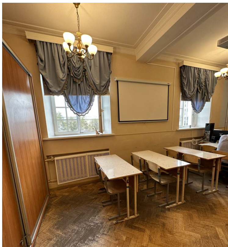
Фото 28. Класс 2-его этажа – разводка системы отопления (Пом. 12)
