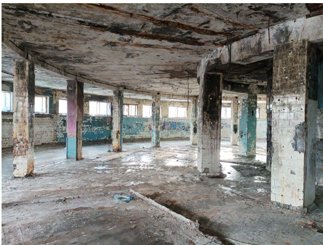
22. Объект культурного наследия регионального значения «Ушаковские бани «Гигант», по адресу: Санкт-Петербург, ул. Зои Космодемьянской, дом 7, литера А. Помещение второго этажа. Дата съемки: 01.03.2023г.
