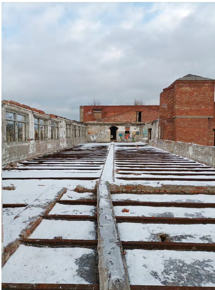
17. Объект культурного наследия регионального значения «Ушаковские бани «Гигант», по адресу: Санкт-Петербург, ул. Зои Космодемьянской, дом 7, литера А. Перекрытия второго этажа. Дата съемки: 01.03.2023г.
