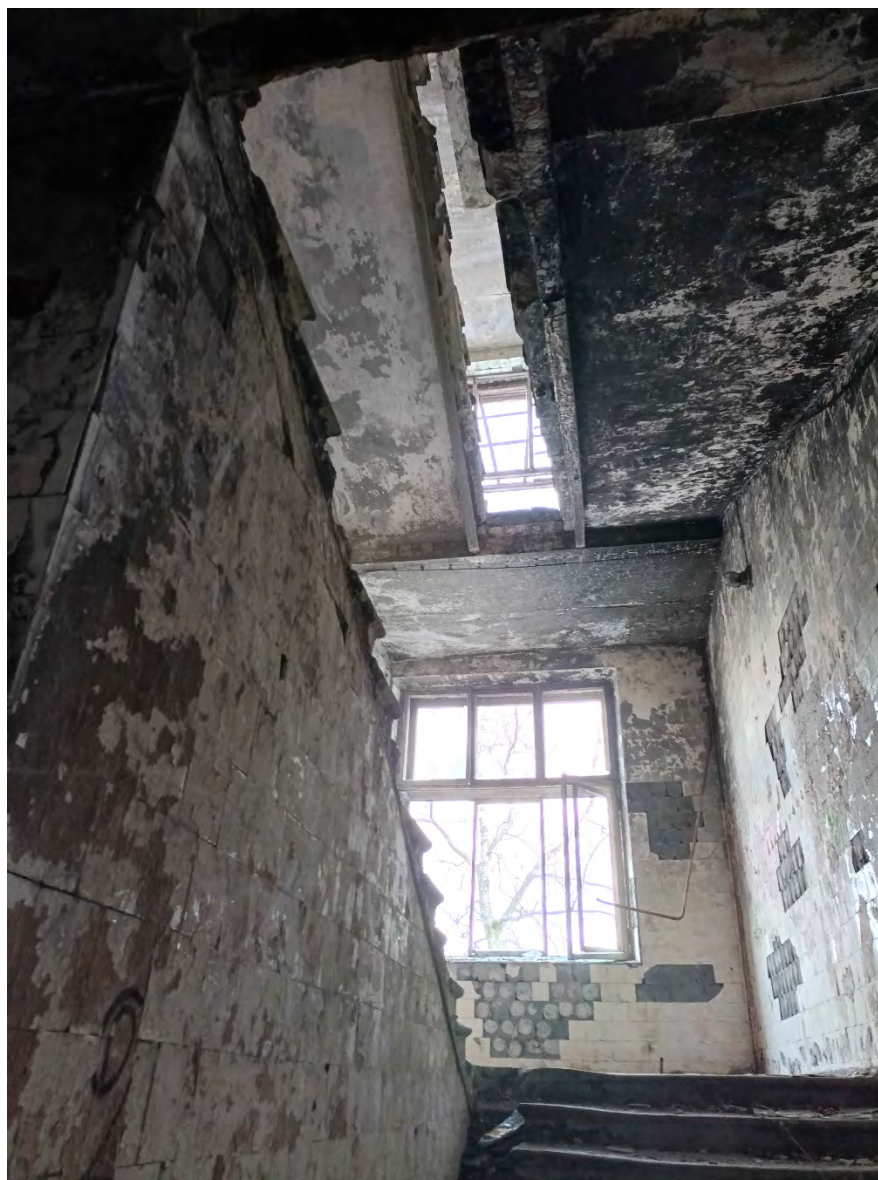
20. Объект культурного наследия регионального значения «Ушаковские бани «Гигант», по адресу: Санкт-Петербург, ул. Зои Космодемьянской, дом 7, литера А. Фрагмент лестницы в южной части объекта. Дата съемки: 01.03.2023г.
