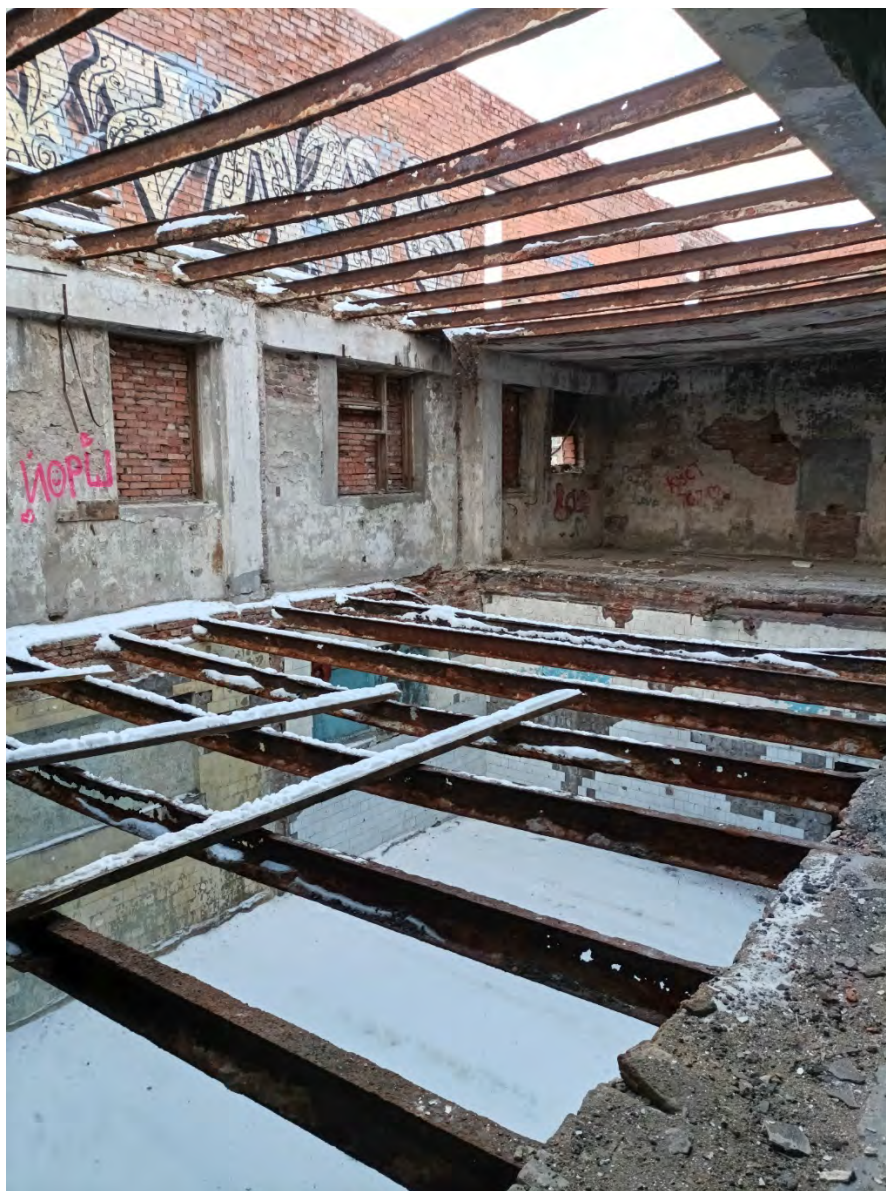
18. Объект культурного наследия регионального значения «Ушаковские бани «Гигант», по адресу: Санкт-Петербург, ул. Зои Космодемьянской, дом 7, литера А. Металлические балки перекрытий. Дата съемки: 01.03.2023г.
