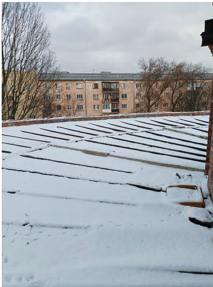
15. Объект культурного наследия регионального значения «Ушаковские бани «Гигант», по адресу: Санкт-Петербург, ул. Зои Космодемьянской, дом 7, литера А. Перекрытия второго этажа. Дата съемки: 01.03.2023г.
