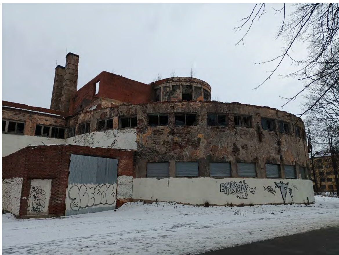
8. Объект культурного наследия регионального значения «Ушаковские бани «Гигант», по адресу: Санкт-Петербург, ул. Зои Космодемьянской, дом 7, литера А. Фрагмент круглой части фасада. Дата съемки: 01.03.2023г.
