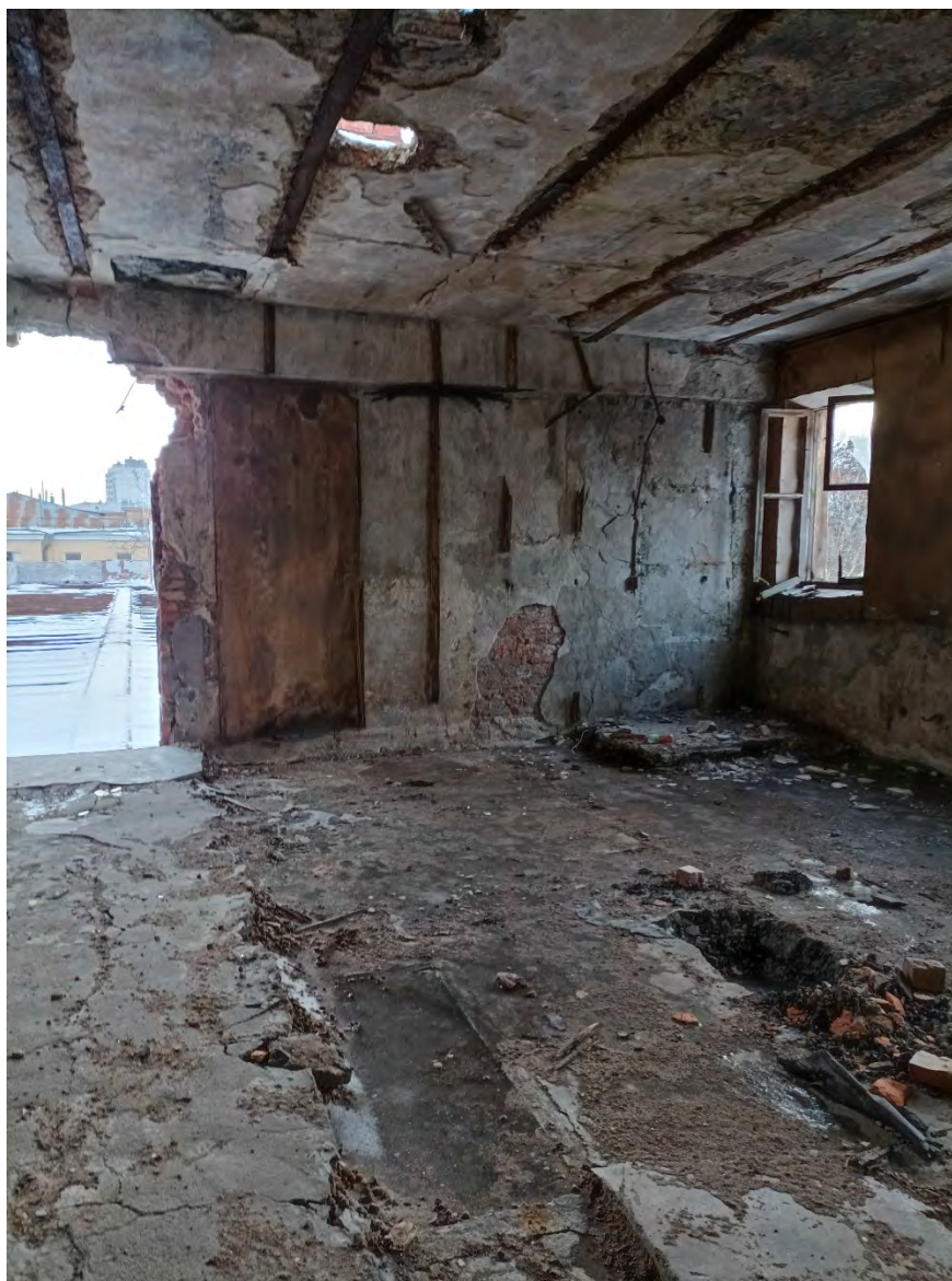
26. Объект культурного наследия регионального значения «Ушаковские бани «Гигант», по адресу: Санкт-Петербург, ул. Зои Космодемьянской, дом 7, литера А. Фрагмент перекрытий третьего и второго этажа. Дата съемки: 01.03.2023г.
