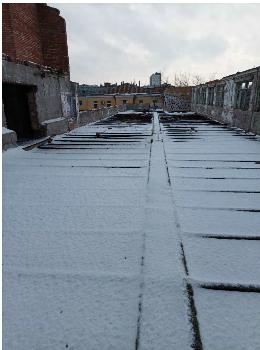
16. Объект культурного наследия регионального значения «Ушаковские бани «Гигант», по адресу: Санкт-Петербург, ул. Зои Космодемьянской, дом 7, литера А. Перекрытия второго этажа. Дата съемки: 01.03.2023г.
