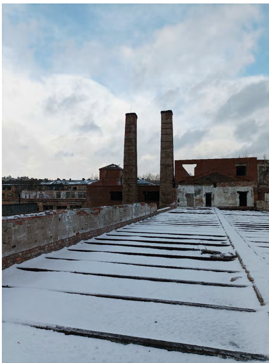
13. Объект культурного наследия регионального значения «Ушаковские бани «Гигант», по адресу: Санкт-Петербург, ул. Зои Космодемьянской, дом 7, литера А. Перекрытия второго этажа. Дата съемки: 01.03.2023г.
