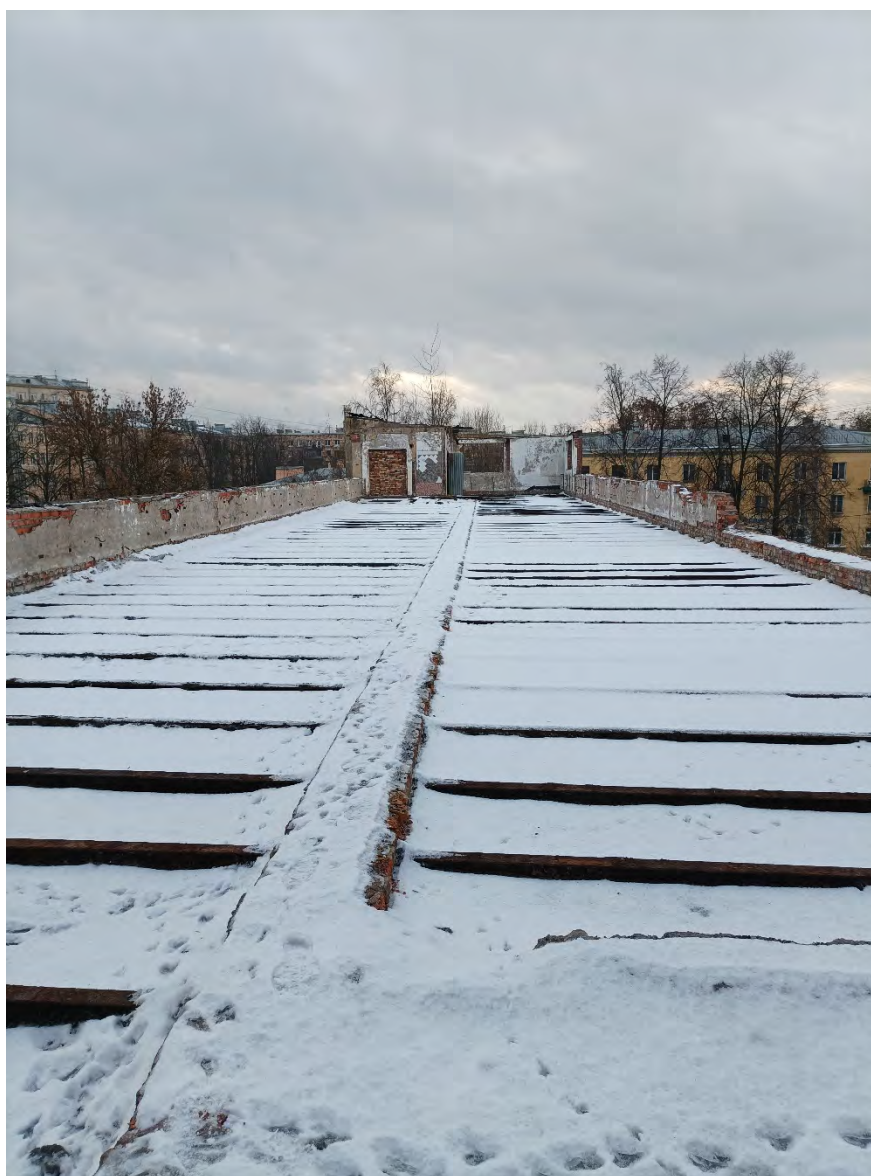
14. Объект культурного наследия регионального значения «Ушаковские бани «Гигант», по адресу: Санкт-Петербург, ул. Зои Космодемьянской, дом 7, литера А. Перекрытия второго этажа. Дата съемки: 01.03.2023г.
