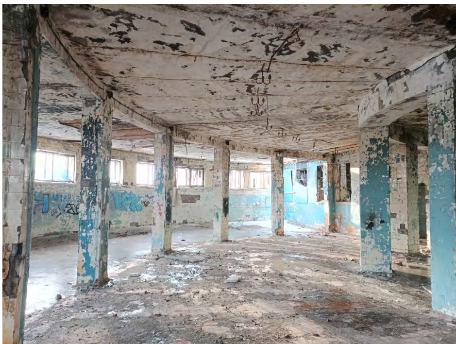
23. Объект культурного наследия регионального значения «Ушаковские бани «Гигант», по адресу: Санкт-Петербург, ул. Зои Космодемьянской, дом 7, литера А. Помещение второго этажа. Дата съемки: 01.03.2023г.
