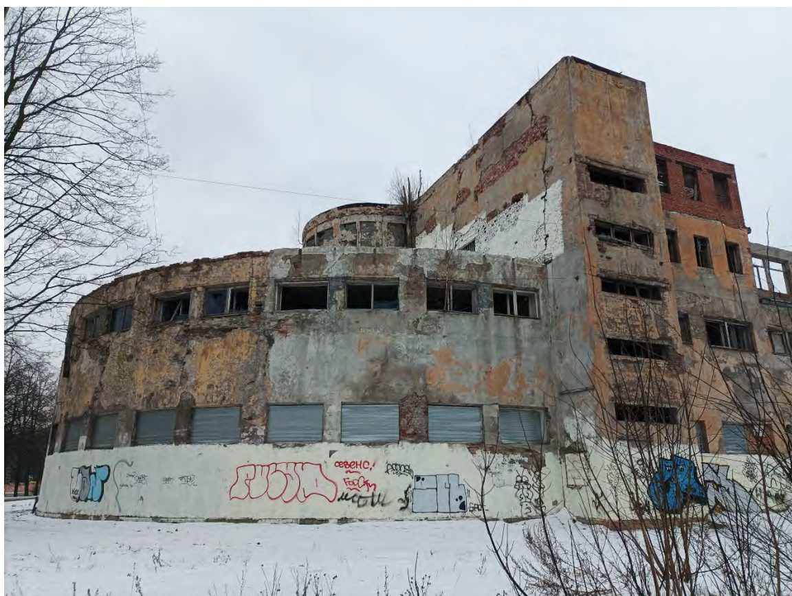
10. Объект культурного наследия регионального значения «Ушаковские бани «Гигант», по адресу: Санкт-Петербург, ул. Зои Космодемьянской, дом 7, литера А. Фрагмент северного фасада. Дата съемки: 01.03.2023г.
