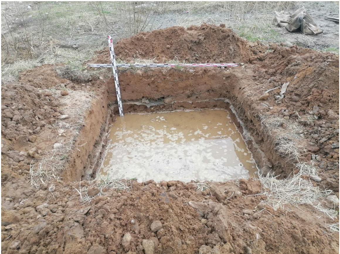
Рис. 40 Санкт-Петербург, пос. Шушары, Колпинское шоссе, участок 168 (квартал II)» (кадастровый номер: 78:42:0018304:19566) Шурф 2. Фиксация по уровню грунтовых вод. Вид на юг.
