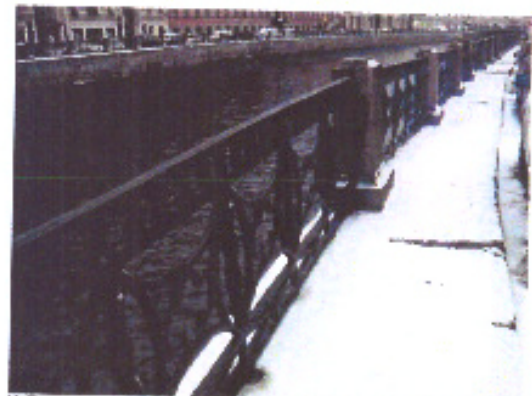
10. Вид на левый берег, тротуар (правый берег), на участке между Плещеевым и Пискаревским (Зеленом, Нарвским) мостами
