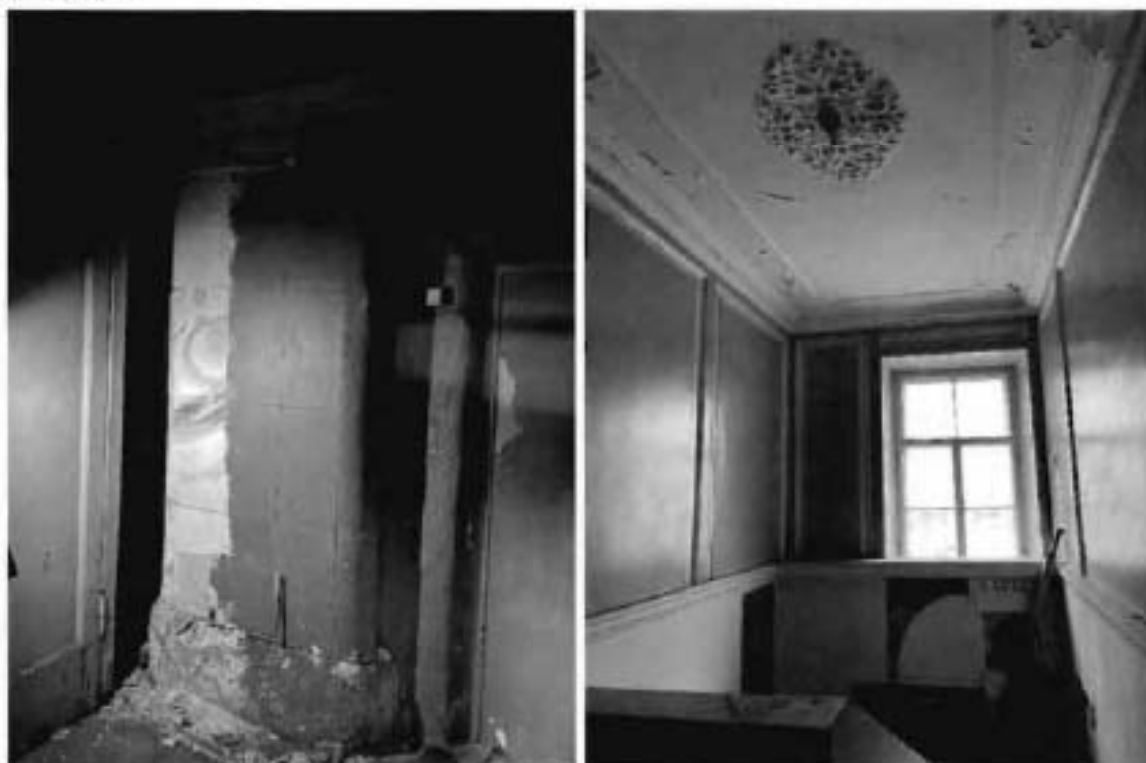
10, 11. Интерьер парадной лестницы Л-2 главного дома объекта культурного наследия по наб. реки Фонтанки.
