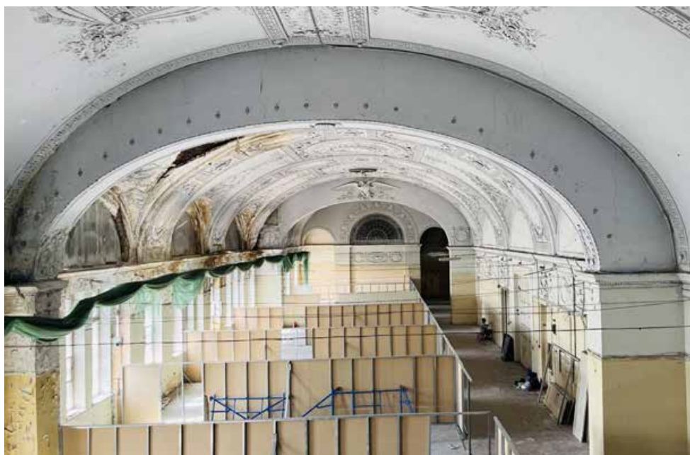
74. Объект культурного наследия регионального значения «Главное здание с 8 флигелями» по адресу: г. Санкт-Петербург, Фрунзенский р-н, ул. Расстанная, д. 20, лит. А, в составе объекта культурного наследия регионального значения «Дом престарелых и увечных граждан (Николаевский дом призрения)», расположенного по адресу: Санкт-Петербург, Расстанная ул., д. 20, Тамбовская ул., д. 80-82. Третий этаж. Помещение бывшей церкви. Общий вид (северная, южная и западная стены помещения).
