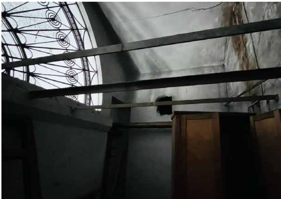
73. Объект культурного наследия регионального значения «Главное здание с 8 флигелями» по адресу: г. Санкт-Петербург, Фрунзенский р-н, ул. Расстанная, д. 20, лит. А, в составе объекта культурного наследия регионального значения «Дом престарелых и увечных граждан (Николаевский дом призрения)», расположенного по адресу: Санкт-Петербург, Расстанная ул., д. 20, Тамбовская ул., д. 80-82. Третий этаж. Помещение бывшей церкви. Фрагмент интерьера второго уровня помещения. Южная сторона.
