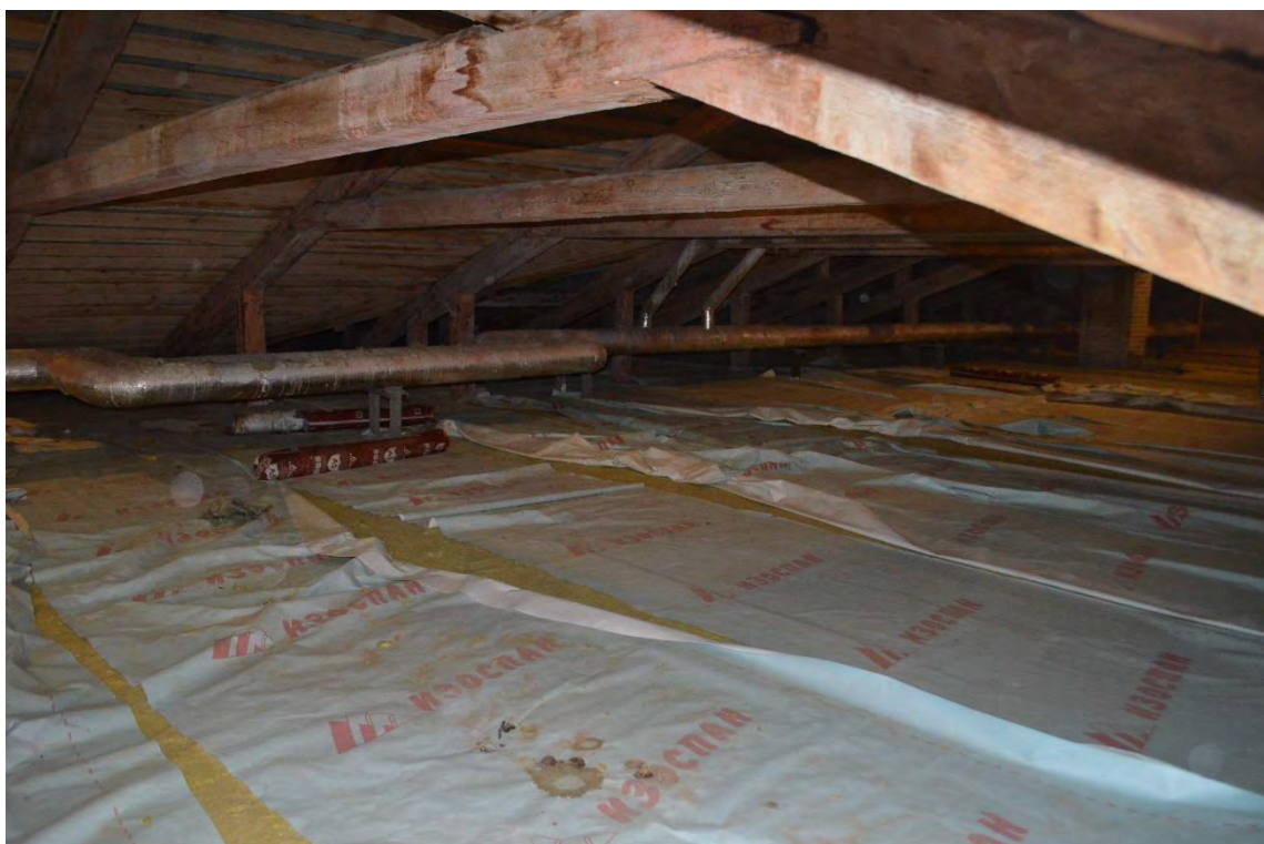
Фото 11. ОКН федерального значения «Монетный двор». Корпус № 5. Чердак. Стропильная система. Общий вид. Съёмка 24.11.2022 г.
