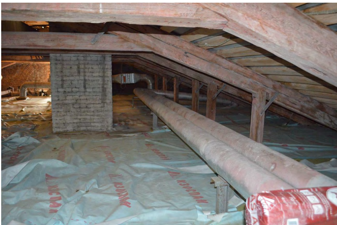
Фото 13. ОКН федерального значения «Монетный двор». Корпус № 5. Чердак. Стропильная система. Фрагмент. Съёмка 24.11.2022 г.
