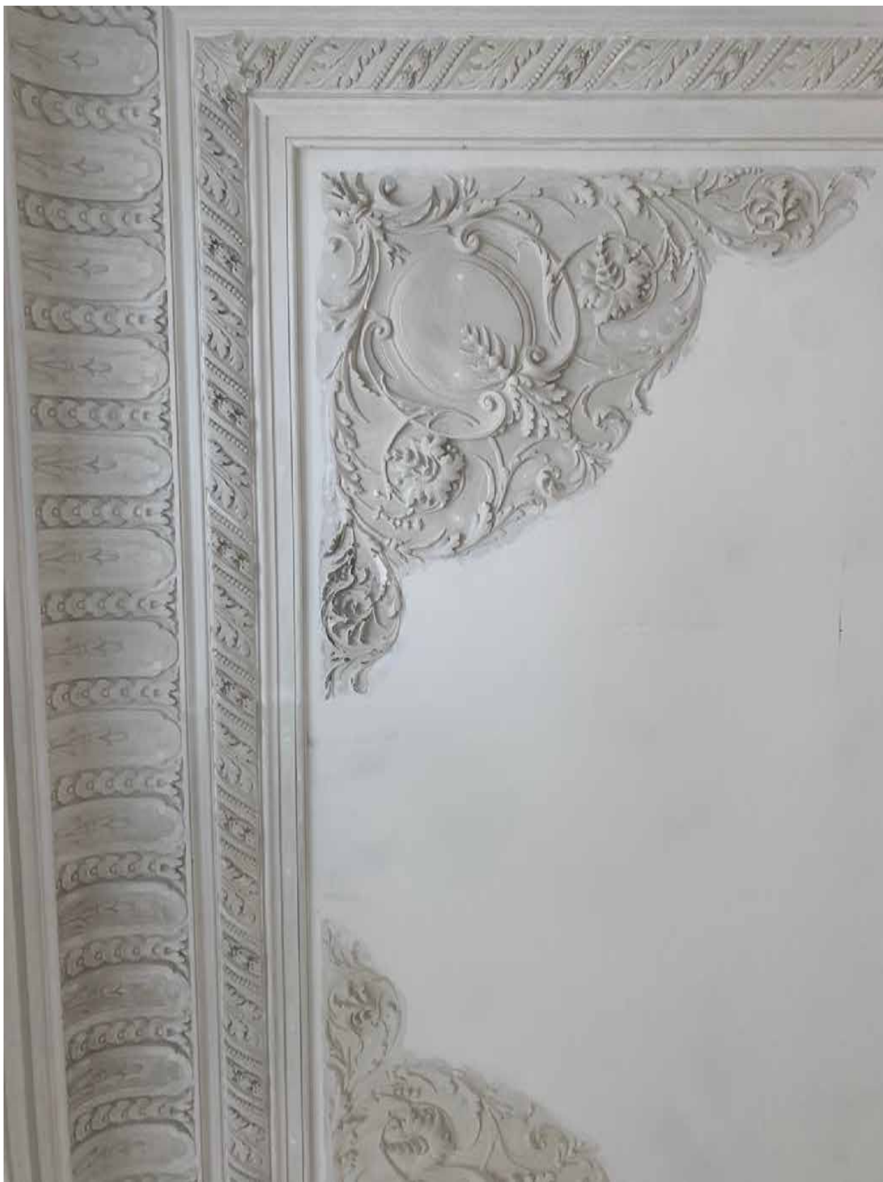
Фото 27. Фрагмент потолка помещения квартиры № 45 объекта культурного наследия.
