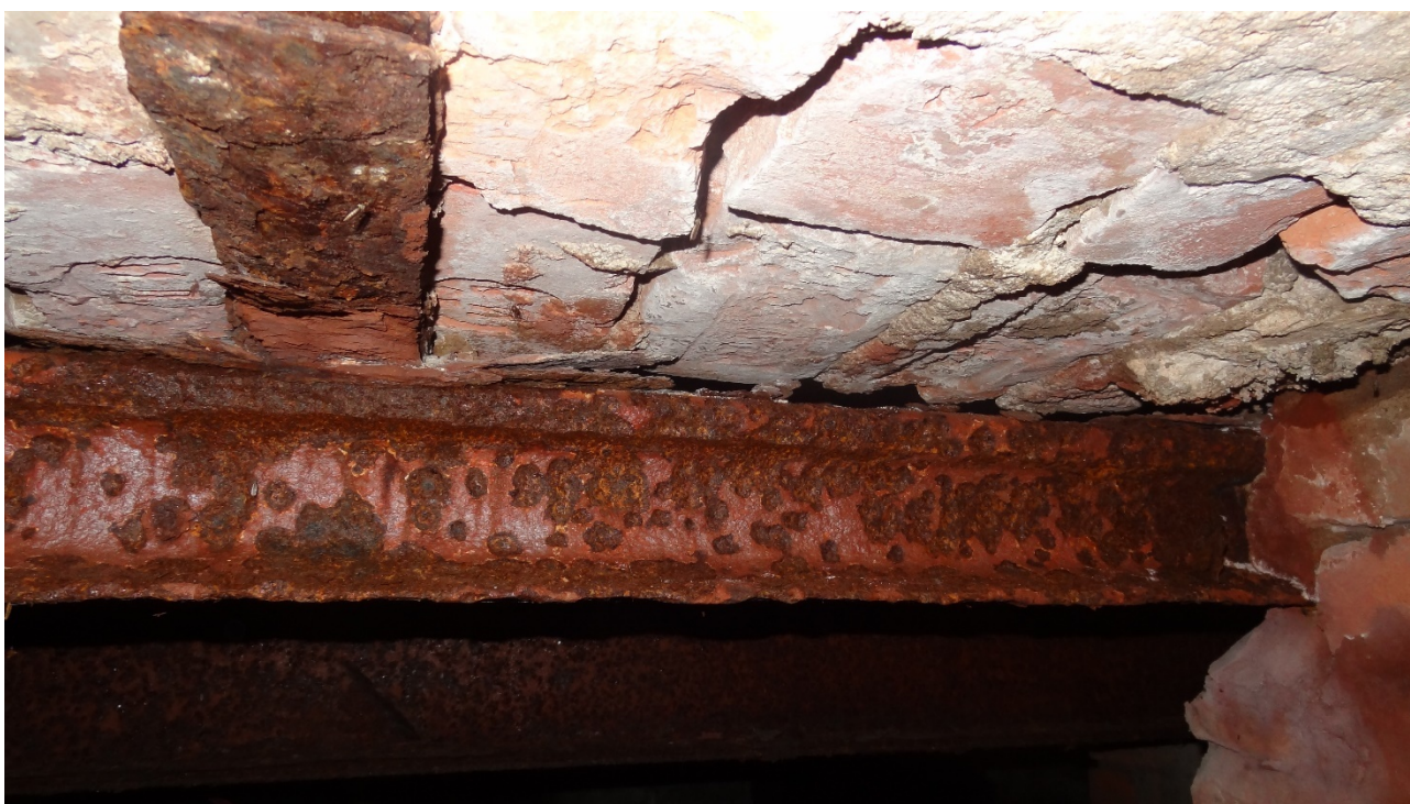
Фото 16. Трещина в сводах. Фрагмент. Дата фотофиксации: 14.06.23
