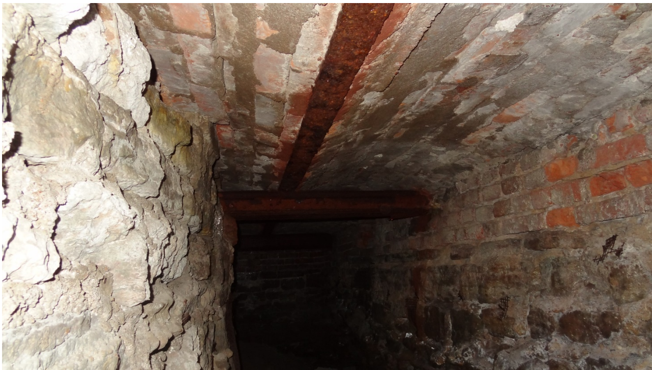
Фото 25. Фрагмент конструкции с прогибом свода. Дата фотофиксации: 14.06.23
