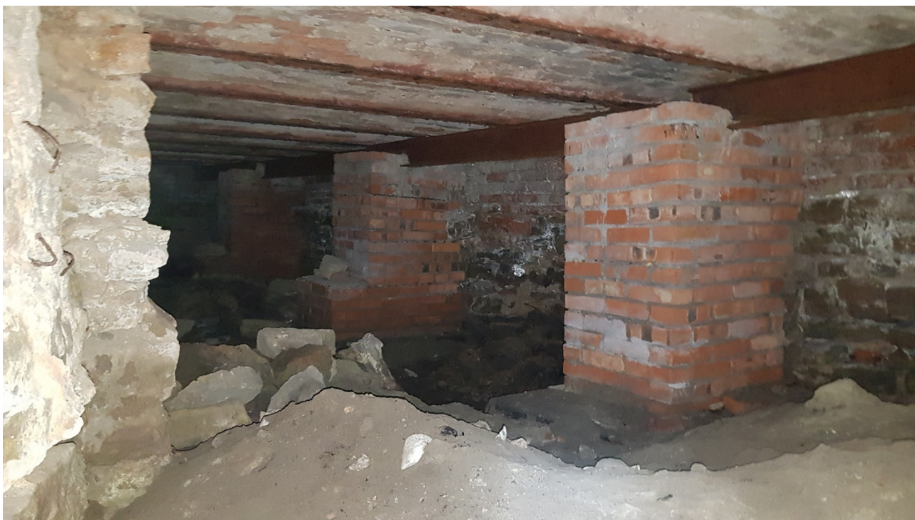
Фото 26. Прусские своды и современное усиление. Вид на северную часть подвала с восточной части подвала. Дата фотофиксации: 14.06.23
