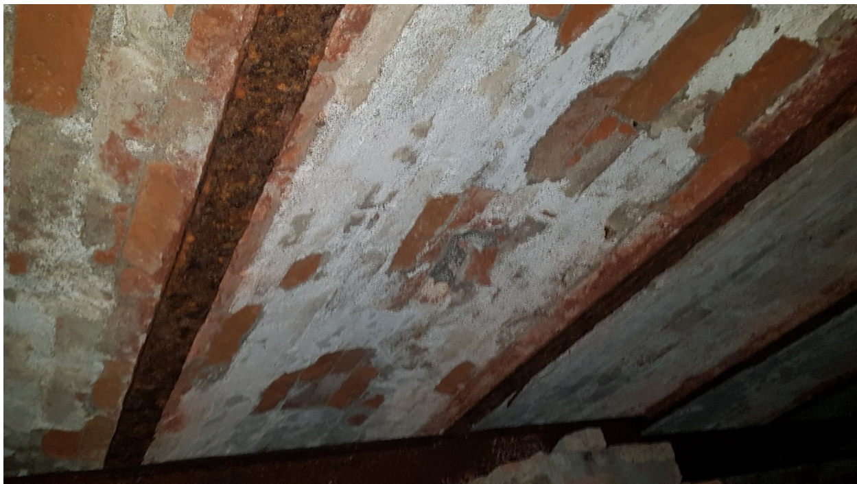
Фото 27. Фрагмент деформированного прусского свода в центральной части. Дата фотофиксации: 14.06.23
