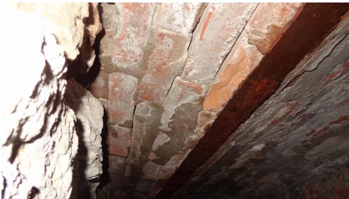
Фото 24. Фрагмент деформированного прусского свода в восточной части подвала. Дата фотофиксации: 14.06.23
