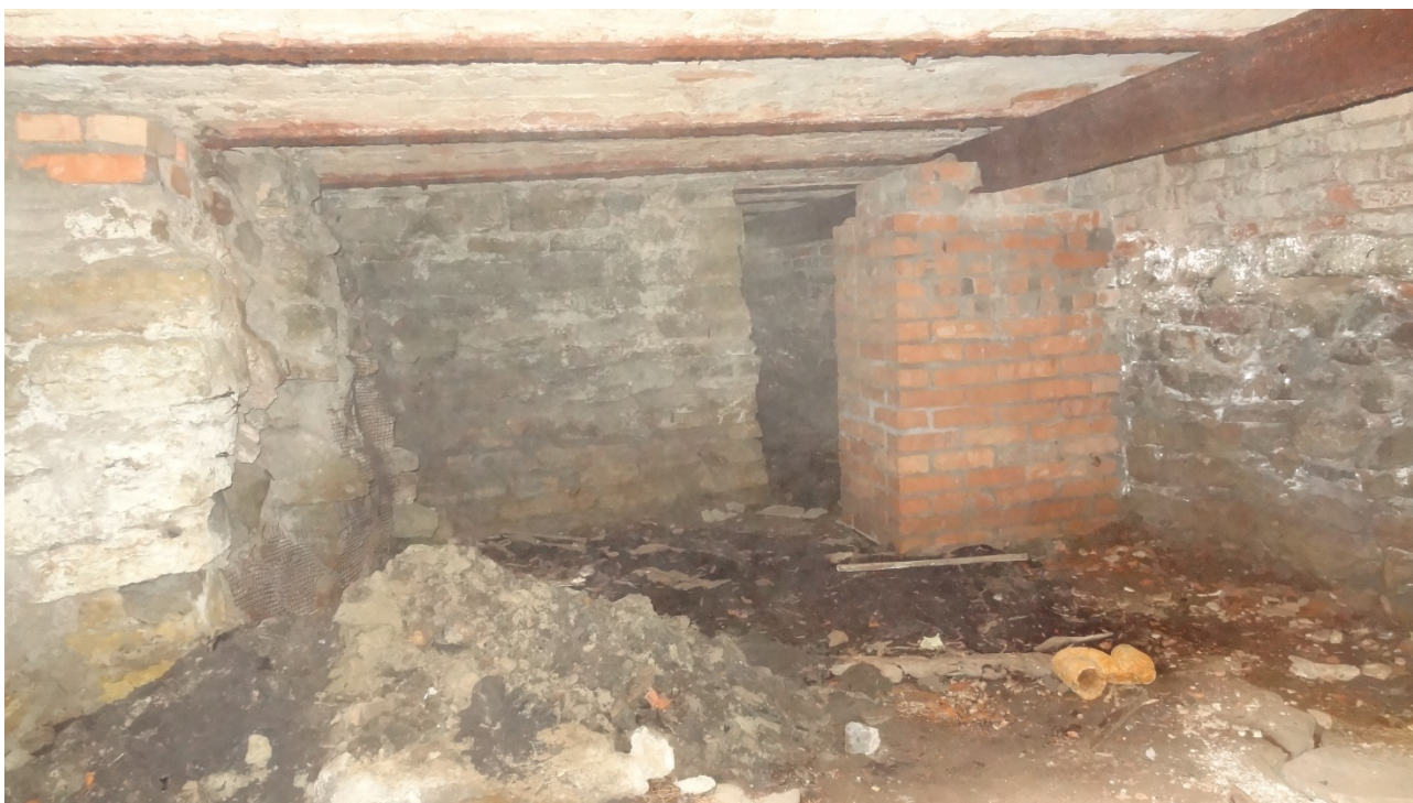
Фото 13. Вид на сохранившиеся прусские своды, современное усиление, фрагмент фундамента, служившего основанием для утраченной изразцовой печи.
