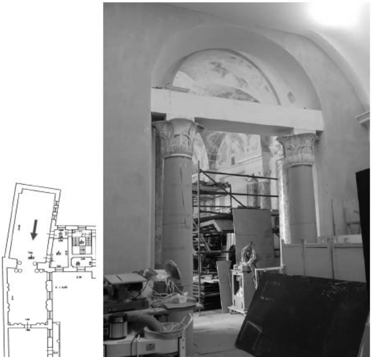
Фото 11. Объект культурного наследия федерального значения "Дворец Строгановых", по адресу: Санкт-Петербург, Невский пр. 17. Помещение 211 Физический кабинет
