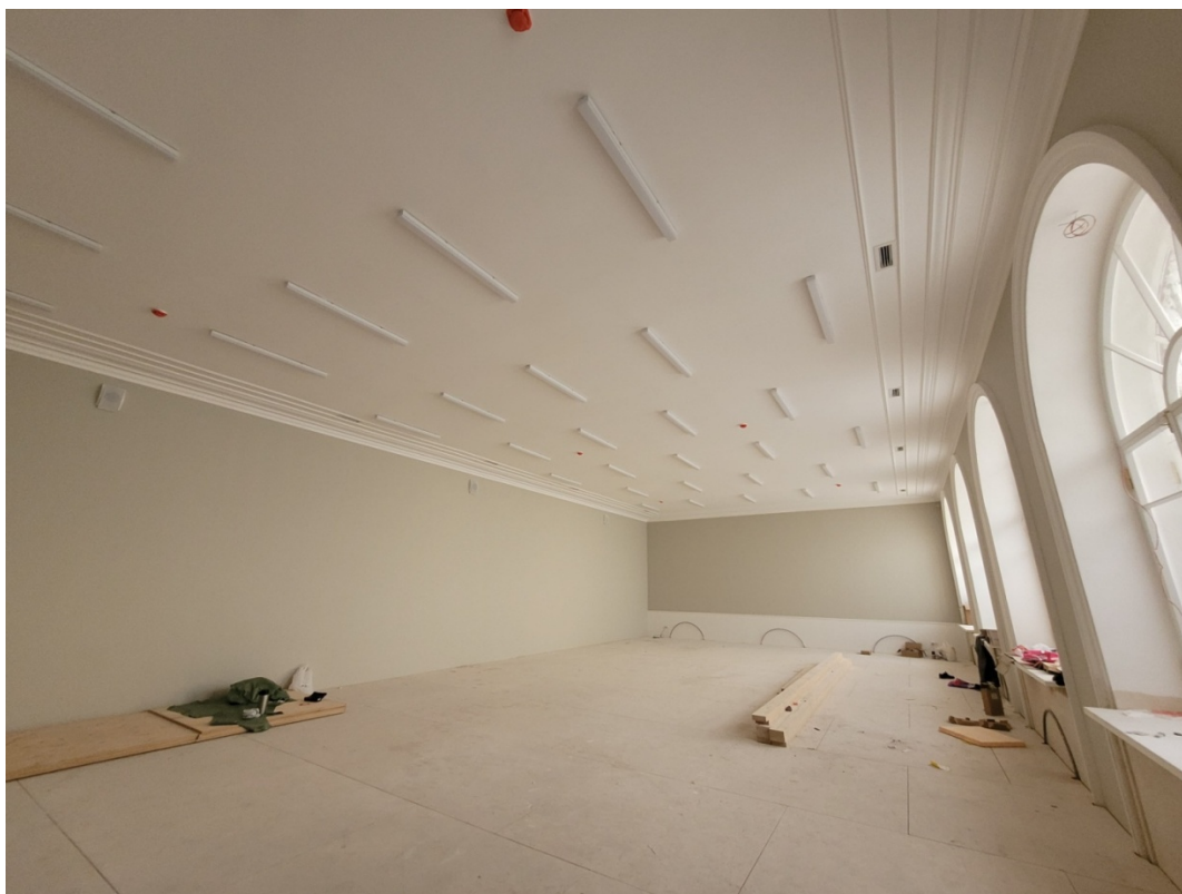
28. Объект культурного наследия регионального значения (ансамбль) «Комплекс построек Главного управления государственного коннозаводства и Санкт-Петербургской аукционной конюшни», расположенный по адресу: Санкт-Петербург, улица Маяковского, дом 15, литера А. Современный репетиционный зал. Дата съемки: 28.04.2023г.
