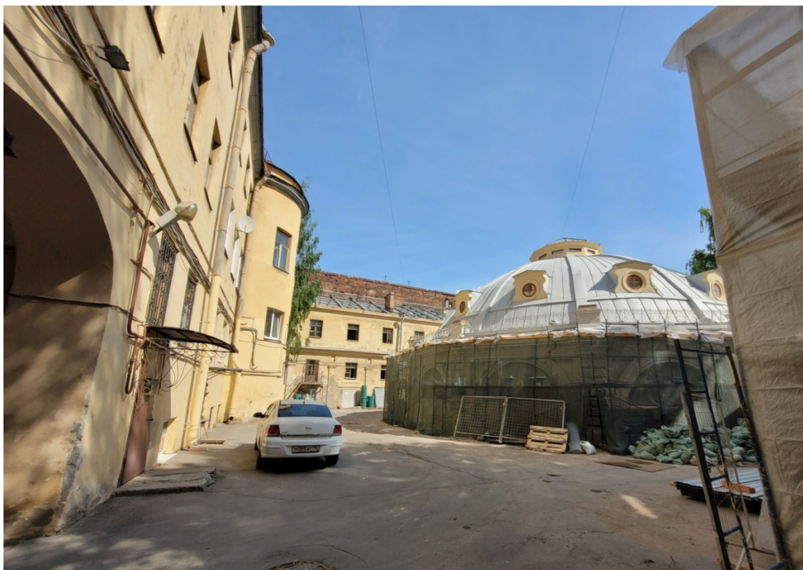
13. Объект культурного наследия регионального значения (ансамбль) «Комплекс построек Главного управления государственного коннозаводства и Санкт-Петербургской аукционной конюшни», расположенный по адресу: Санкт-Петербург, улица Маяковского, дом 15, литера А. Вид на Выводной манеж. Дата съемки: 28.04.2023г.
