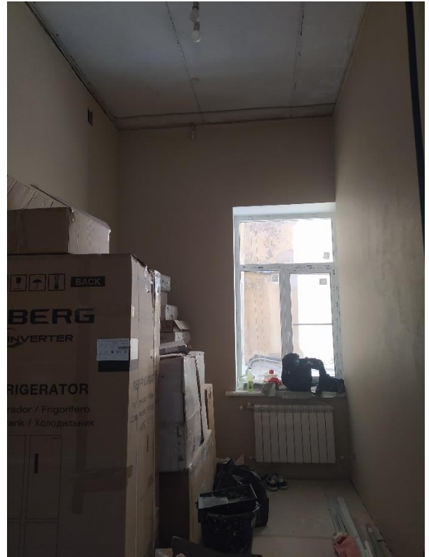
Фото 17. Вид на второе кухонное окно кв. № 33 слева от входа на кухню.
