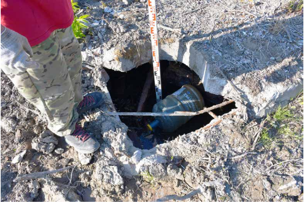
Илл. 18. г. Санкт-Петербург. ул. Тамбасова. Земельный участок с кадастровым номером 78:40:0008472:7780. Уровень стояние грунтовых вод в «коробе» теплотрассы. Вид с юга.
