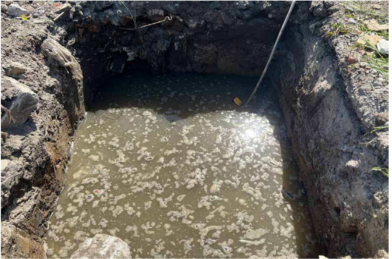
Илл. 23. г. Санкт-Петербург, ул. Тамбасова. Земельный участок с кадастровым номером 78:40:0008472:7780. Шурф №1. Попытка удаления грунтовых вод из шурфа. Вид с севера.
