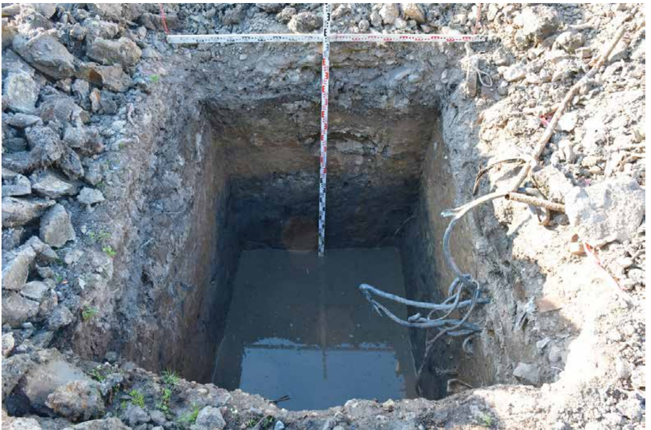
Илл. 31. г. Санкт-Петербург, ул. Тамбасова. Земельный участок с кадастровым номером 78:40:0008472:7778. Шурф №2. Уровень стояния грунтовых вод. Вид с юга.
