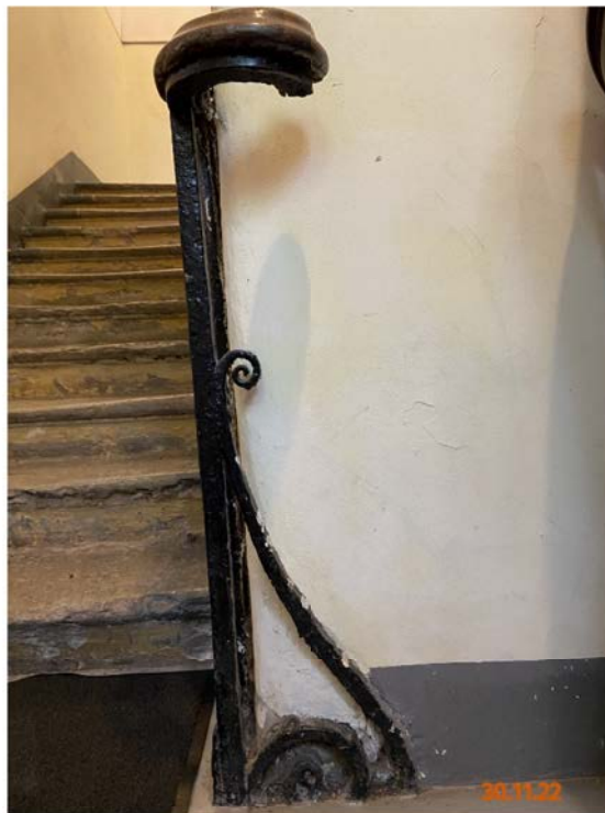
Фото № 2. Фрагмент основания лестничного ограждения. 1 этаж. Дата фотофиксации: 30.11.22 г.
