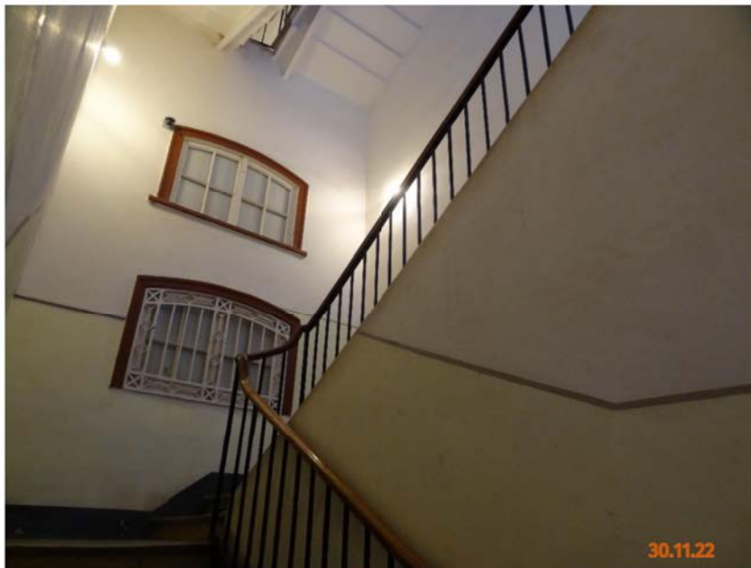
Фото № 4. Общий вид. Лестничный пролёт и межэтажная площадка. Глухие оконные проёмы. Дата фотофиксации: 30.11.22 г.
