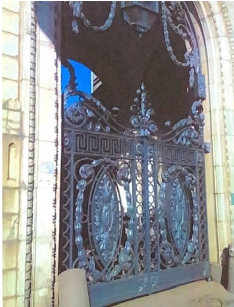
Илл. 94. Научно-реставрационный отчет по объекту. Выполнение первоочередных противоаварийных работ по реставрации кованых ворот с навершием, фонарем Музея политической истории России особняка В.Э. Бранта. 2015 г. Ворота после реставрации.
