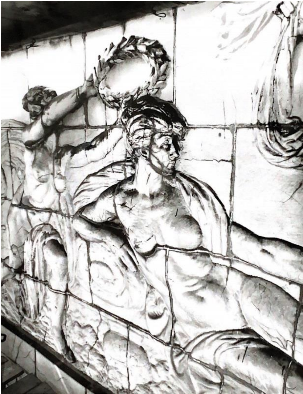
Илл. 83. Фотофиксация портала до начала производства работ (после установки лесов). РПНЦ «Специалист», 2003 г. Панно. Центральная композиция.
