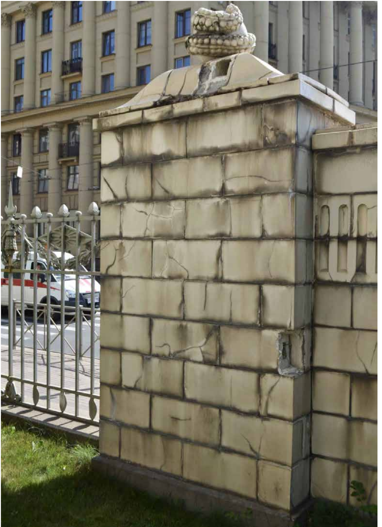
Фото 16. ОКН федерального значения «Особняк Бранта В. Э.» (ул. Куйбышева, дом 2-4, лит. А). Парапетный столб, увенчанный воссозданным шаром, обвитым змеями. Вид со стороны сада. Фрагмент. Съёмка 01.07.2021 г.
