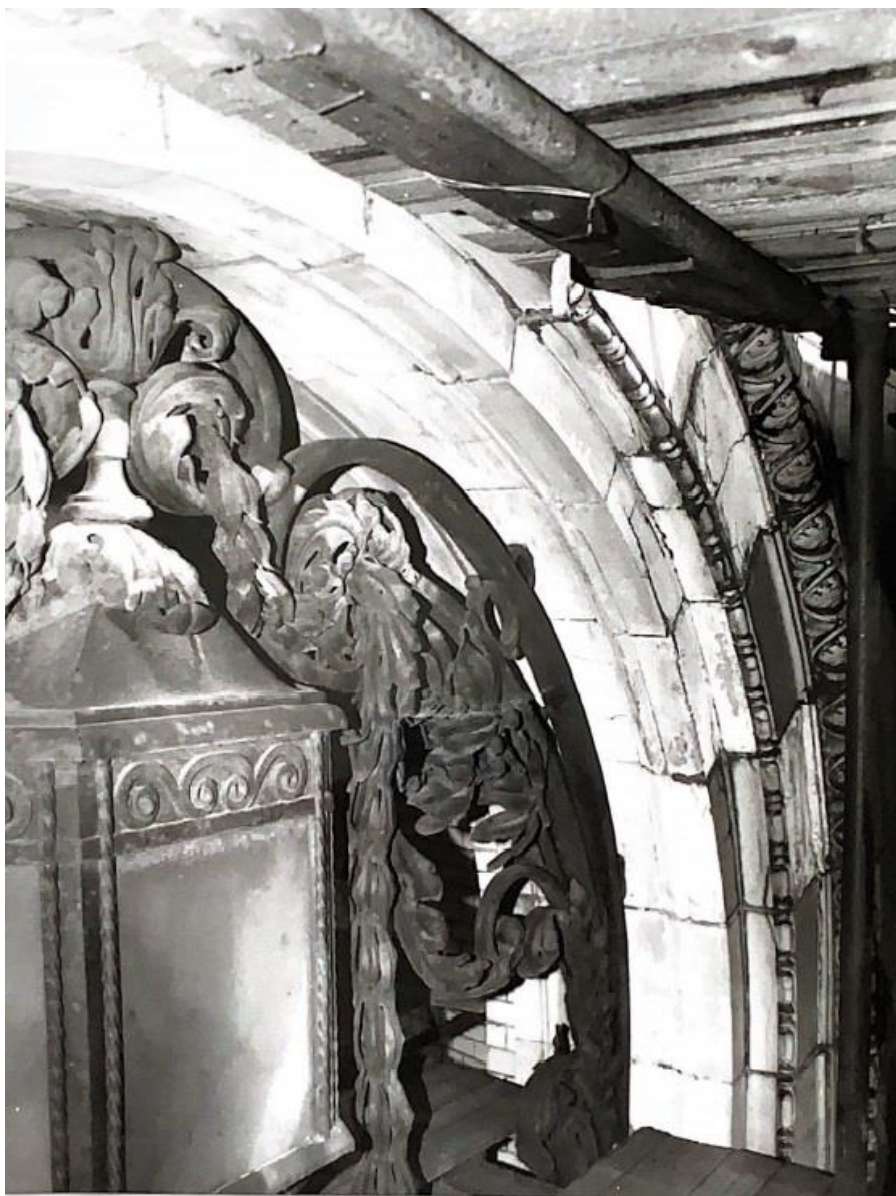
Илл. 82. Фотофиксация портала до начала производства работ (после установки лесов). РПНЦ «Специалист», 2003 г. Юго-восточный угол.
