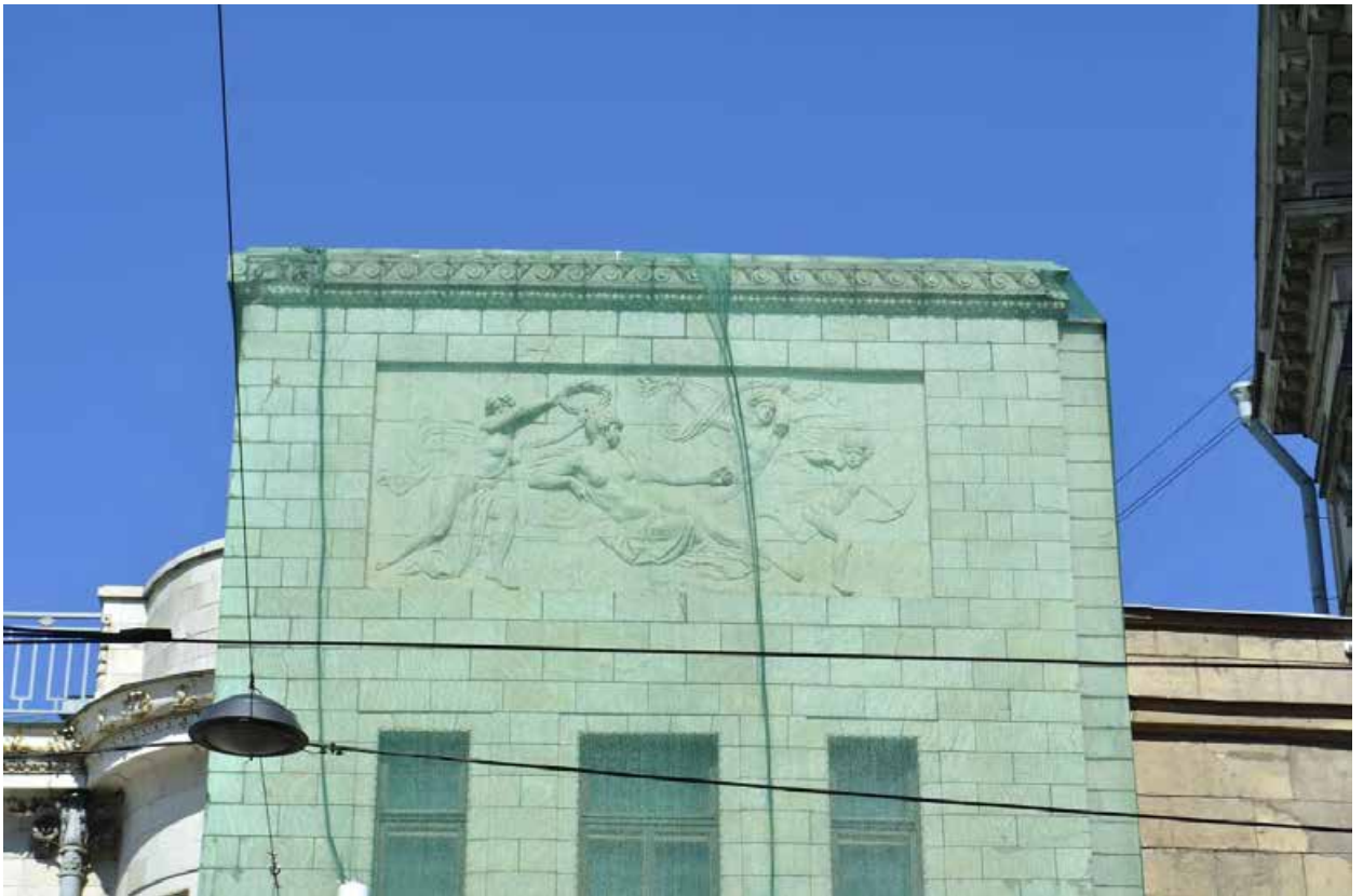
Фото 22. ОКН федерального значения «Особняк Бранта В. Э.» (ул. Куйбышева, дом 2-4, лит. А). Рельефная керамическая композиция в верхней части ризалита. Вид со стороны ул. Куйбышева. Фрагмент. Съёмка 01.07.2021 г.
