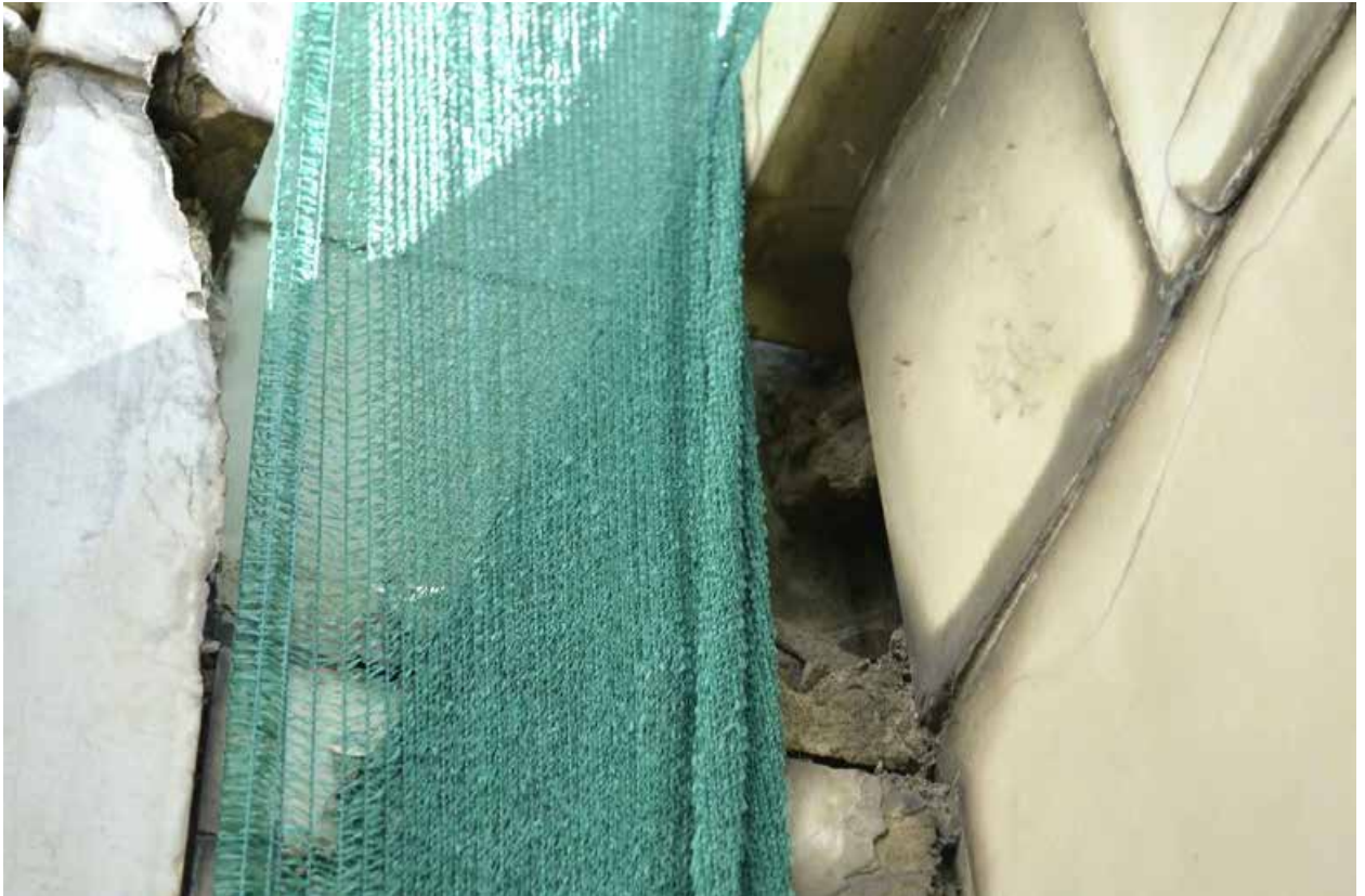
Фото 34. ОКН федерального значения «Особняк Бранта В. Э.» (ул. Куйбышева, дом 2-4, лит. А). Облицовка стен внутри сада. Фрагмент. Съёмка 01.07.2021 г.
