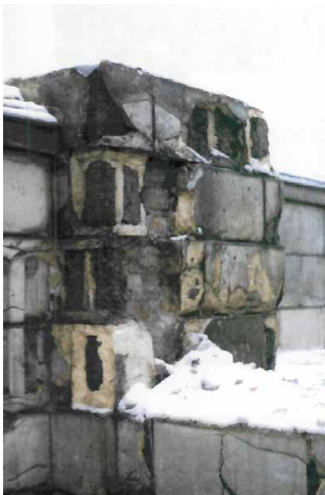
Илл. 59. Инженерное обследование состояния стен, фундаментов, каменной ограды и террасы особняка В.Э. Бранта, 2000 г.
