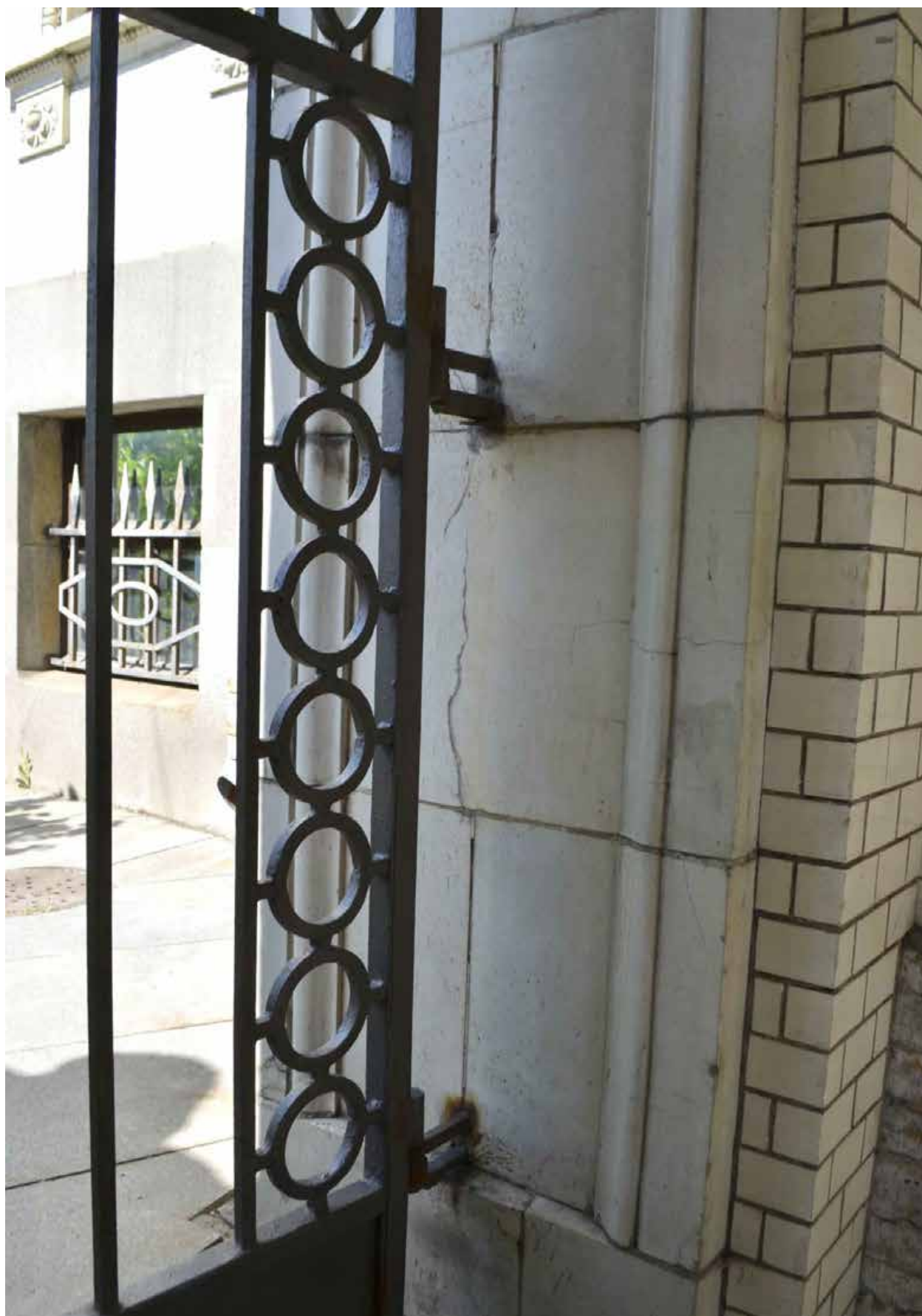
Фото 31. ОКН федерального значения «Особняк Бранта В. Э.» (ул. Куйбышева, дом 2-4, лит. А). Прямоугольный входной проем в воротном проезде, ведущий в сад. Калитка из кованного черного металла. Фрагмент. Съёмка 01.07.2021 г.
