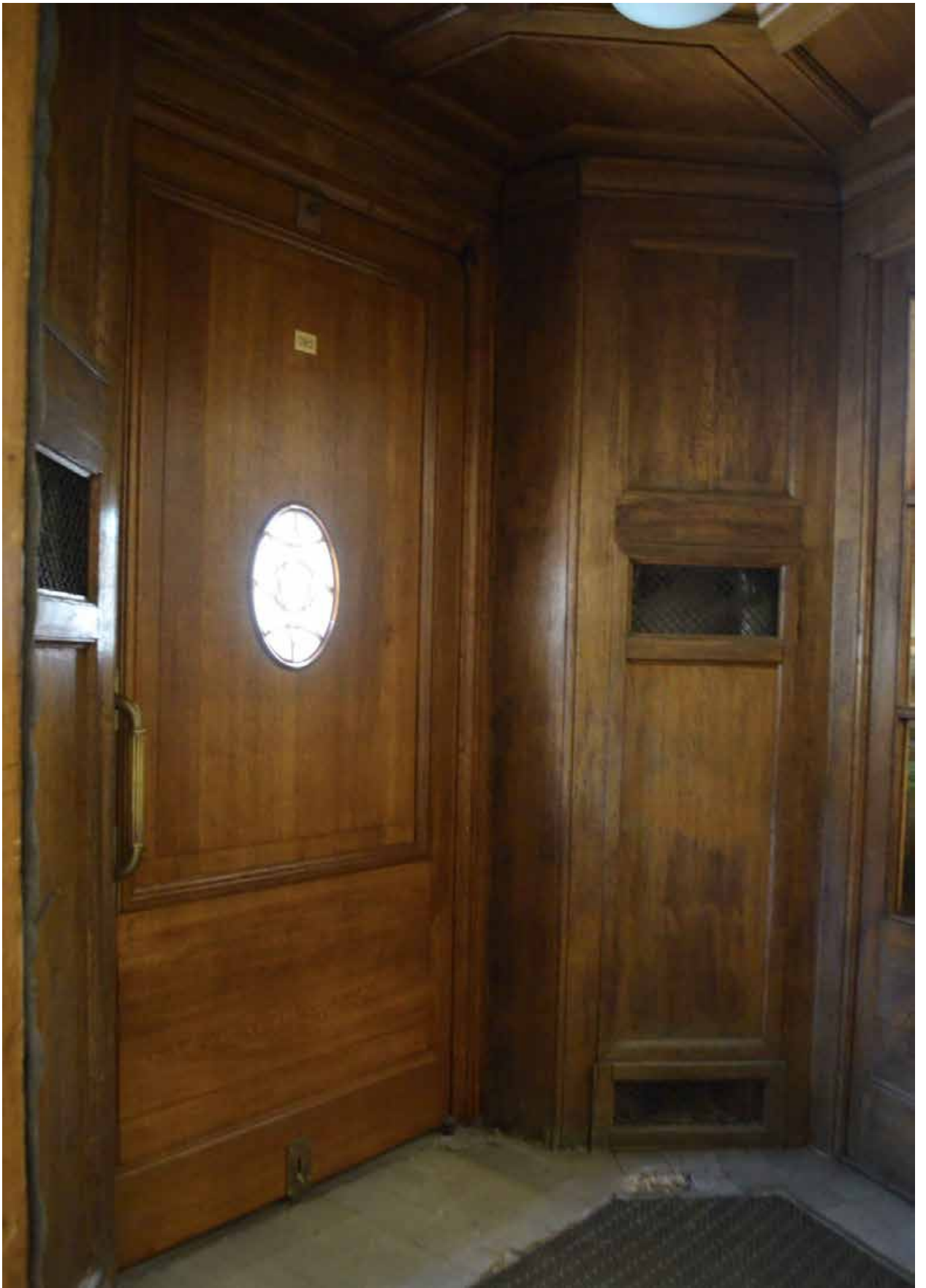
Фото 36. ОКН федерального значения «Особняк Бранта В. Э.» (ул. Куйбышева, дом 2-4, лит. А). Тамбур парадного входа. Внутренние дубовые стены тамбура с историческими вентиляционными решетками. Наружный дверной проем с историческим заполнением. Фрагмент. Съёмка 01.07.2021 г.
