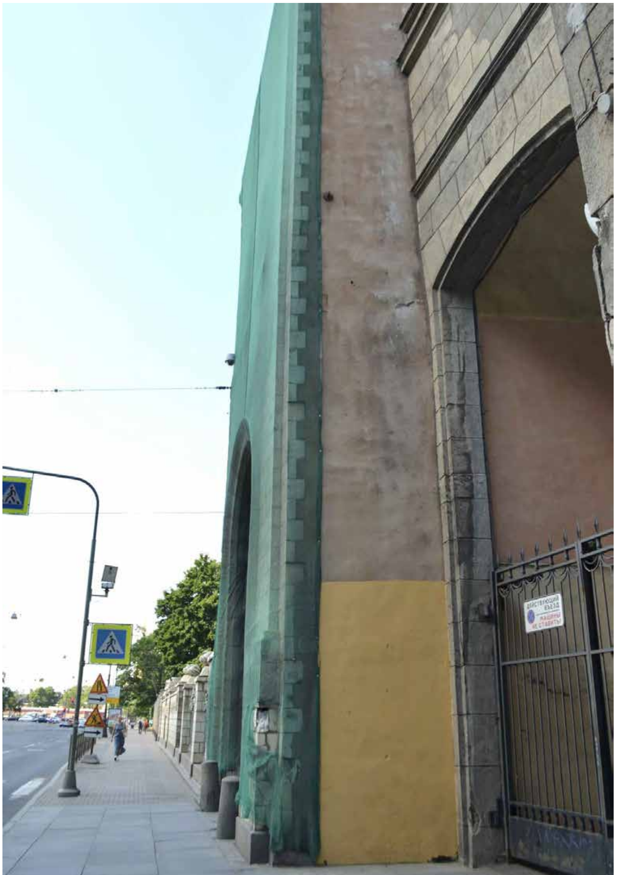
Фото 21. ОКН федерального значения «Особняк Бранта В. Э.» (ул. Куйбышева, дом 2-4, лит. А). Ризалит с воротным проездом со стороны ул. Куйбышева. Фрагмент. Вид с северо-востока. Съёмка 01.07.2021 г.
