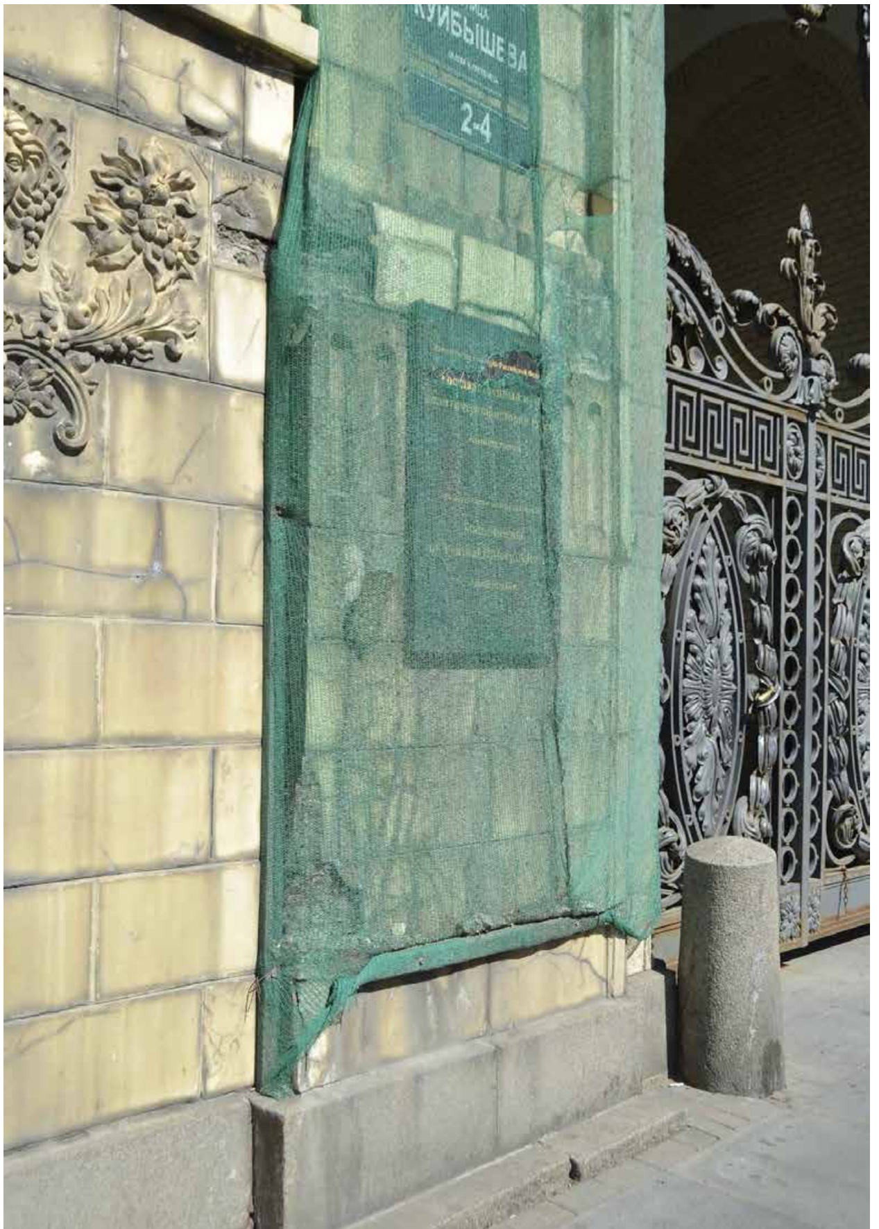
Фото 25. ОКН федерального значения «Особняк Бранта В. Э.» (ул. Куйбышева, дом 2-4, лит. А). Ризалит со стороны ул. Куйбышева. Фрагмент. Съёмка 01.07.2021 г.
