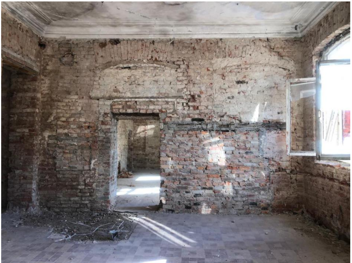
Фото 30. Стена по оси 10 в осях Б – В (первоначально – наружная). При пристройке части здания между осями 10 – 13 оконные проемы – заложены. Вид с западной стороны.
