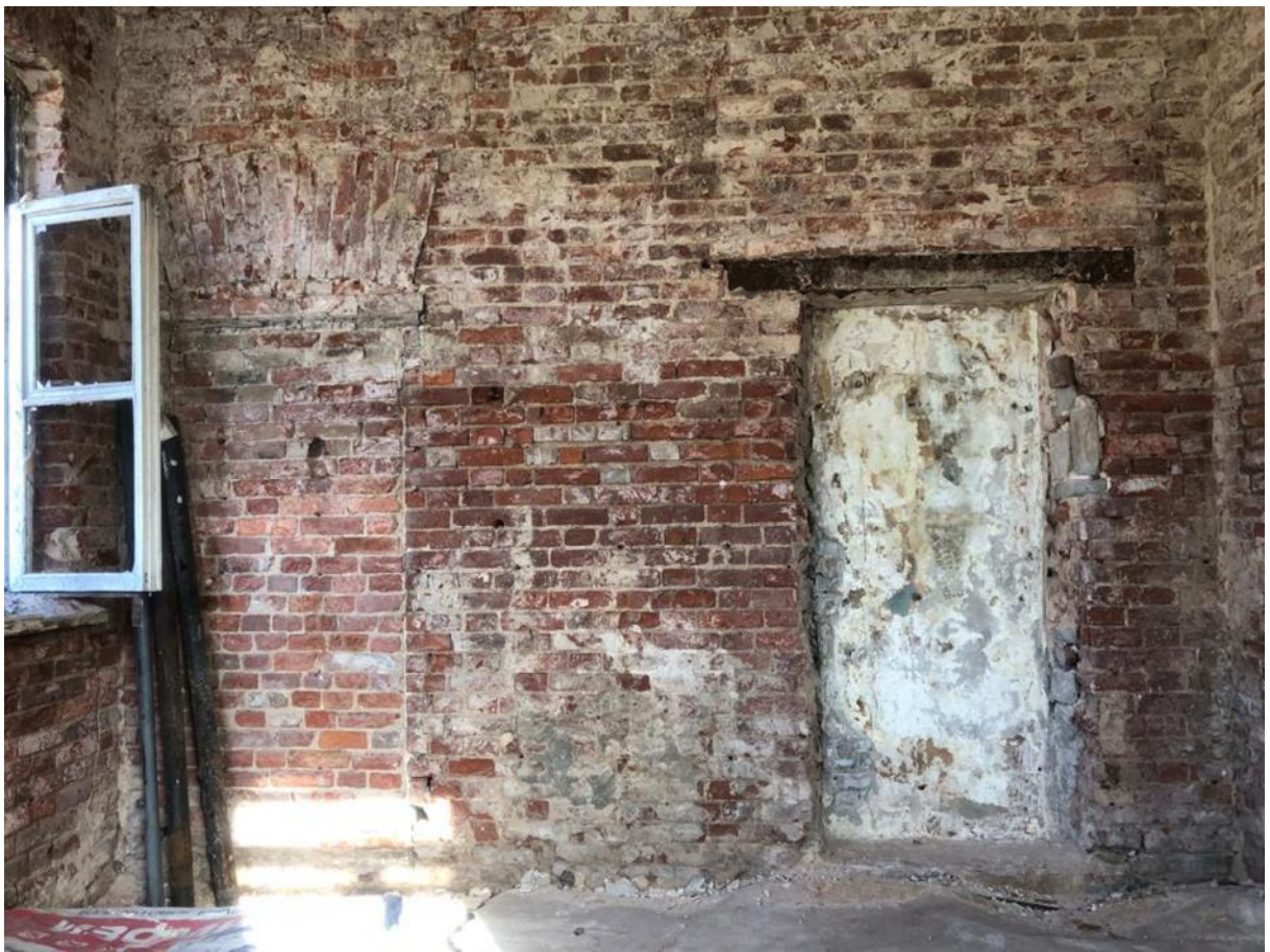
Фото 24. Помещение 1-го этажа в осях 1 – 2/Б – В. Вид на стену по оси В с юга.
